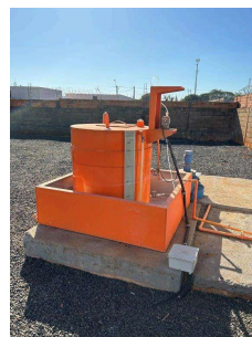
Foto 4 - Tanque dosador de produto químico
