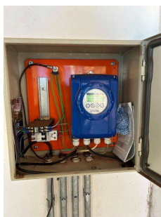
Foto 5 - Medidor de vazão
