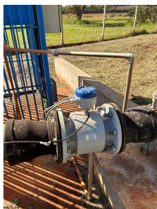
Foto 7 - Macromedidor de vazão
