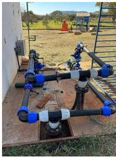
Foto 3 - Detalhe do barrilete do booster
