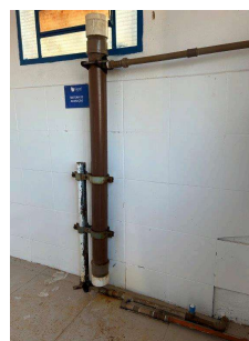
Foto 4 - Sistema de cloração
