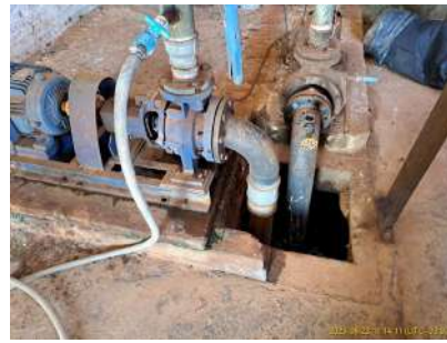
Foto 2 - Ausência de proteção na entrada do reservatório de água tratada, possibilitando a entrada de sujeira, água de chuva, produtos químicos e animais de pequeno porte
