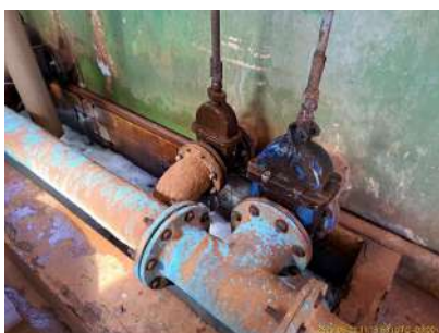
Foto 1 - Detalhe de vazamentos nos registros.
