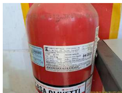
Foto 2 - Extintor com validade expirada.
