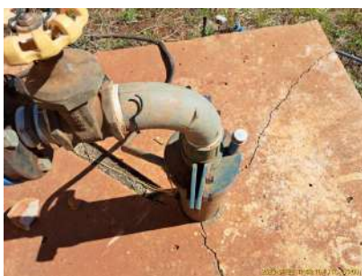
Foto 1 - Tubo medidor de nível do Poço.
