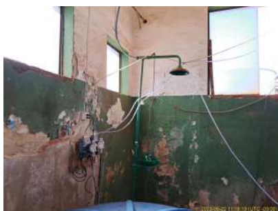
Foto 1 - Chuveiro de emergência.
