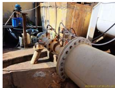
Foto 4 - Locais de adição de produtos químicos.
