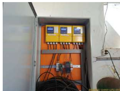
Foto 2 - Paineis dos macromedidores das motobombas, porém não estão operando corretamente.
