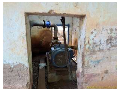
Foto 6 - Vista do outro lado do abrigo do conjunto motobomba de maior porte (e principal)
