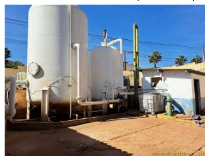
Foto 9 - Vista geral dos dois tanques (decantação à esquerda e filtração à direita) que compõe a ETE III, ao lado da EEAT Bom Jardim e Pombal.
