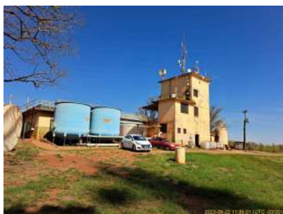
Foto 1 - Vista geral da ETA I e novos filtros da ETA I (em azul).
