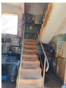
Foto 1 - Ausência de material antiderrapante nos degraus da escada.
