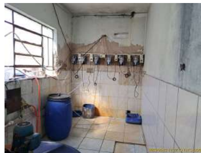
Foto 5 - Armazenamento de produtos químicos e bombas dosadoras.
