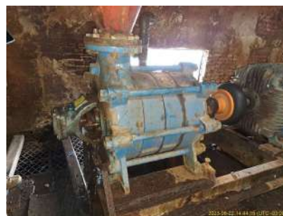
Foto 2 - Vazamento próximo à bomba do conjunto de captação.
