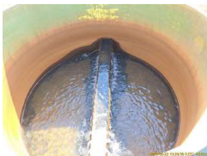
Foto 3 - Vista interna dos novos filtros (azul) da ETA I.
