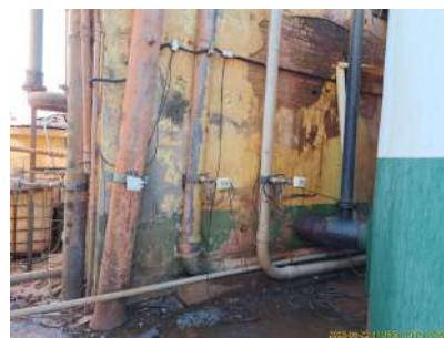
Foto 2 - Pontos de monitoramento dos macromedidores nas tubulações de entrada de água bruta da ETA 1 (contudo, os macromedidores não estão operando corretamente).
