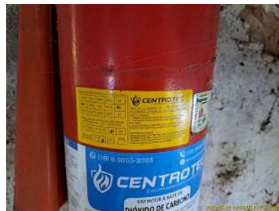
Foto 2 - Detalhe da validade do extintor de incêndio.
