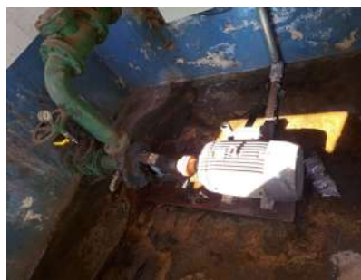
Foto 7 - Conjunto Motobomba Pombal
