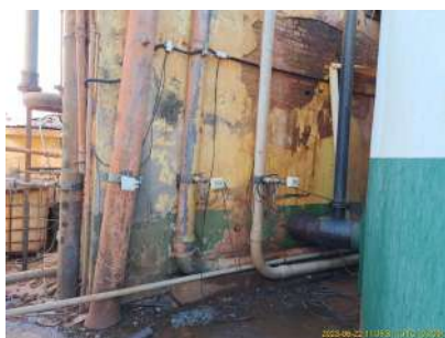
Foto 1 - Pontos de monitoramento dos macromedidores nas tubulações de entrada de água bruta da ETA 1 (contudo, os macromedidores não estão operando corretamente).
