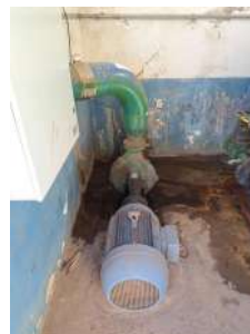
Foto 5 - Conjunto motobomba Bom Jardim.
