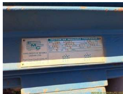
Foto 2 - Placa de especificações técnicas do motor de captação.
