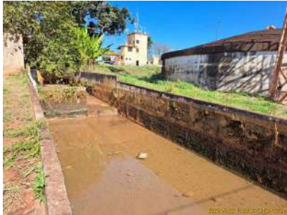
Foto 1 - Tanque de destinação de lodo das ETAs 1-2.
