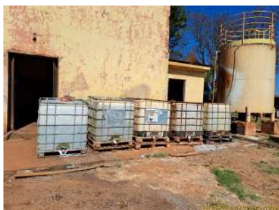
Foto 1 - Situação de tanques de produtos químicos (sem baia de contenção e expostos ao tempo).
