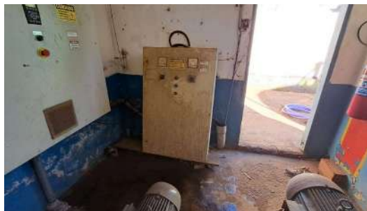
Foto 1 - Painel elétrico da EEAT está apoiada em uma tábua de madeira, próxima ao piso do local.
