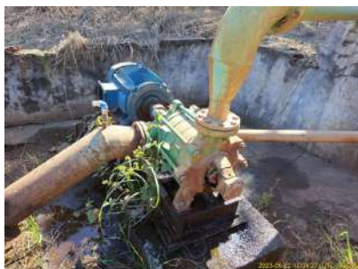
Foto 3 - Vista do único conjunto motobomba instalado na captação da Represa São Jorge II.
