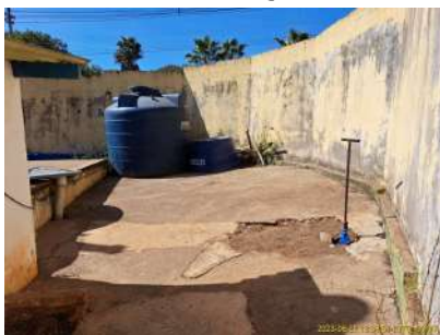
Foto 3 - Registro de manobra para entrada de água tratada das ETAs 1 e 2, interceptada da rede de distribuição.
