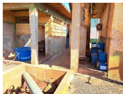
Foto 2 - Situação dos locais de armazenamento de produtos químicos (sem baia de contenção e expostos ao tempo).
