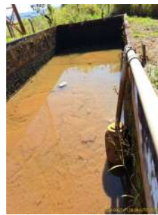
Foto 2 - Local de recebimento do lodo das ETAs 1-2 sem guarda-corpos e com terreno em desnível para dentro do tanque, além de diversos vergalhões de aço expostos, com perigo iminente de acidentes de trabalho.
