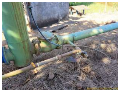
Foto 2 - Vazamento no registro lateral da tubulação.
