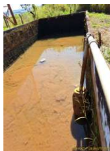
Foto 2 - Tanque de destinação de lodo das ETAs 1-2.
