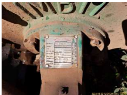
Foto 1 - Placa de especificações técnicas da bomba de captação.
