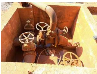
Foto 1 - Vazamento nos registros de manobra das tubulações de água bruta.
