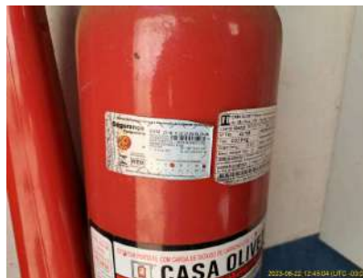
Foto 2 - Validade do extintor de incêndio.
