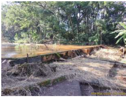
Foto 12 - Represa de Captação São José Viegas.
