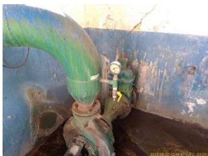
Foto 1 - Detalhe da vazamento na torneira após o manômetro.
