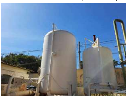
Foto 8 - Vista geral dos dois tanques (decantação à esquerda e filtração à direita) que compõe a ETE III
