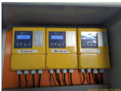
Foto 1 - Paineis dos macromedidores das motobombas, porém não estão operando corretamente.
