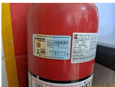
Foto 1 - Extintor com validade expirada.
