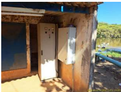
Foto 1 - Ausência de extintor de incêndio no abrigo dos painéis elétricos.
