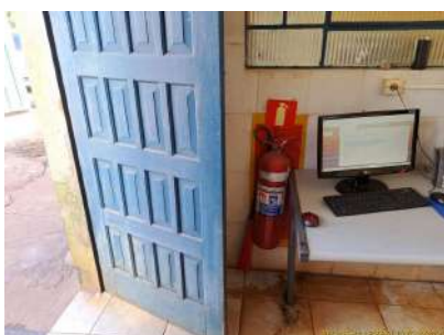
Foto 1 - Extintor de incêndio.
