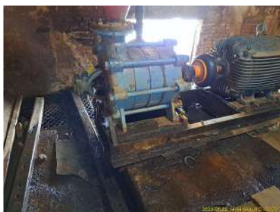
Foto 1 - Vazamento próximo à bomba do conjunto de captação.
