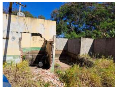
Foto 3 - Vista dos dois tanques de destinação do lodo (primeiro tanque à esquerda).
