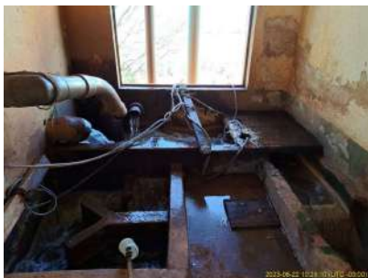
Foto 9 - Local de chegada da água bruta na ETA I e adição de produtos químicos.
