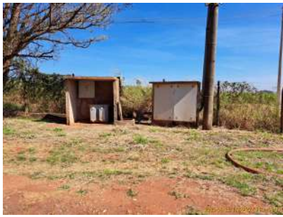
Foto 1 - Abrigo do painel elétrico e do transformador do Poço.
