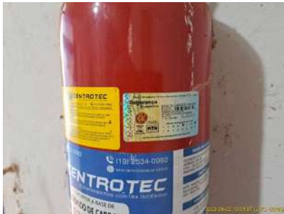
Foto 3 - Validade do extintor de incêndio.
