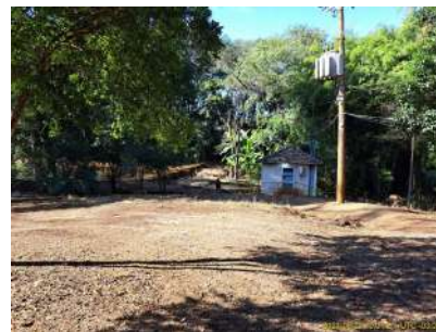
Foto 16 - Vista da Represa de Captação (à esquerda) e do abrigo dos painéis elétricos (à direita), sendo que os conjuntos motobomba estão situados abaixo do abrigo.
