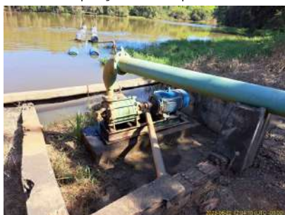
Foto 5 - Vista do único conjunto motobomba instalado na captação da Represa São Jorge II.
