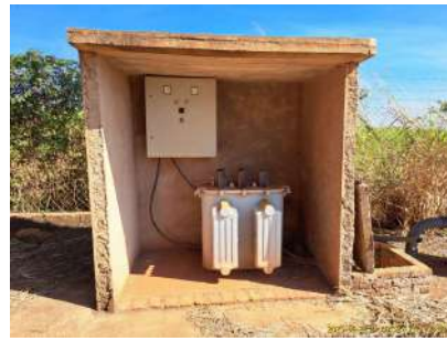
Foto 2 - Abrigo do painel elétrico e do transformador do Poço.
