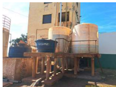
Foto 2 - Armazenamento de produtos químicos das ETA 1.
