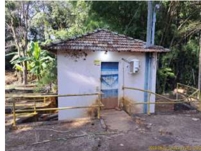
Foto 15 - Abrigo de painéis elétricos
