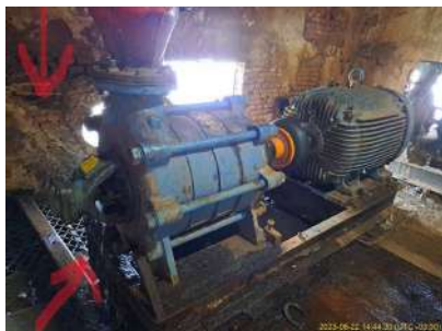
Foto 3 - Detalhe do vazamento próximo à bomba do conjunto de captação.
