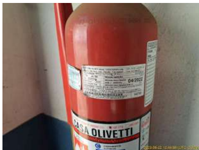
Foto 1 - Validade do extintor de incêndio.
