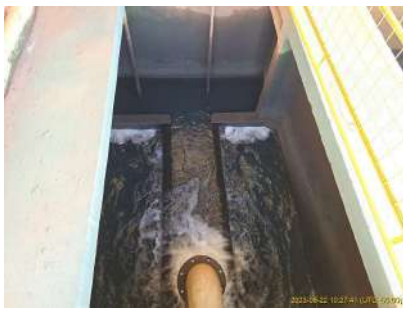
Foto 6 - Vista interna dos filtros antigos (porém readequados) da ETA I.
