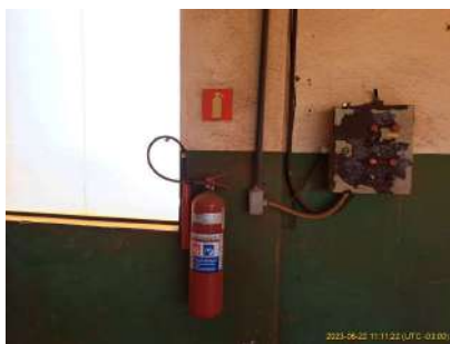
Foto 1 - Extintor de incêndio.
