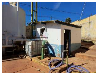
Foto 4 - Vista geral da Estação Elevatória
