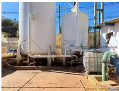
Foto 10 - Vista geral dos dois tanques (decantação à esquerda e filtração à direita) que compõe a ETE III
