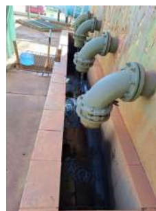
Foto 2 - Vazamentos nas tubulações do lodo pós-filtro da ETA II (que é direcionada ao tanque de retorno do lodo)
