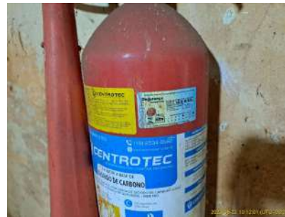
Foto 2 - Validade do extintor de incêndio.
