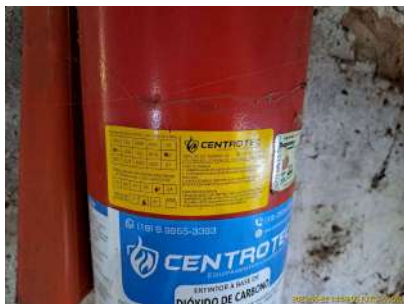
Foto 1 - Detalhe da validade do extintor de incêndio.
