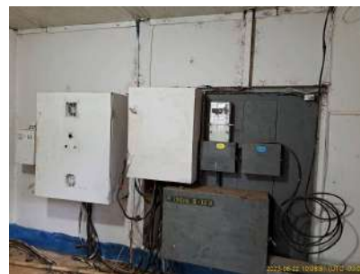
Foto 8 - Painéis elétricos da Captação.
