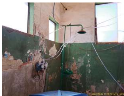
Foto 2 - Chuveiro de emergência próximo ao reservatório de água tratada.
