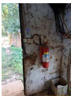
Foto 1 - Extintor de incêndio na casa de bombas, porém com validade vencida.
