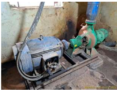
Foto 3 - Conjunto motobomba de menor porte (secundário)
