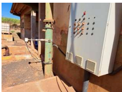
Foto 1 - Pontos de monitoramento do macromedidor na tubulação de entrada de água bruta da ETA II (contudo, os macromedidores não estão operando corretamente).
