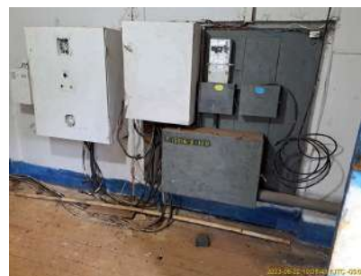
Foto 9 - Painéis elétricos da Captação.
