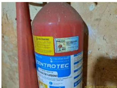
Foto 1 - Extintor de incêndio.
