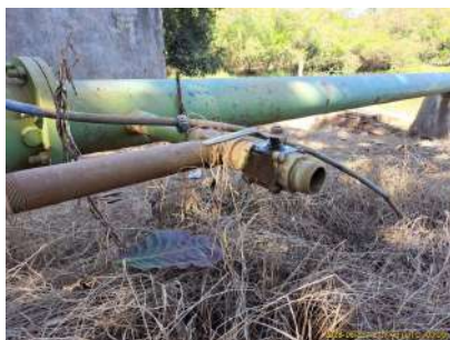
Foto 1 - Vazamento no registro lateral da tubulação.
