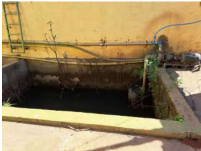
Foto 3 - Ausência de guarda-corpos no poço de manobra para descarte do lodo do decantador da ETA 1.
