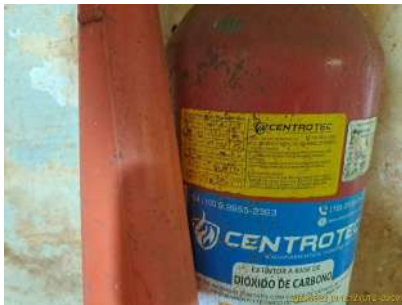
Foto 1 - Validade do extintor de incêndio.
