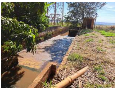
Foto 1 - Local de recebimento do lodo das ETAs 1-2 sem guarda-corpos e com terreno em desnível para dentro do tanque, além de diversos vergalhões de aço expostos, com perigo iminente de acidentes de trabalho.
