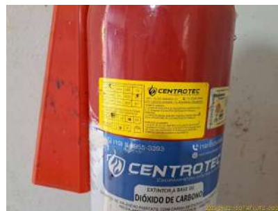
Foto 2 - Extintor de incêndio.
