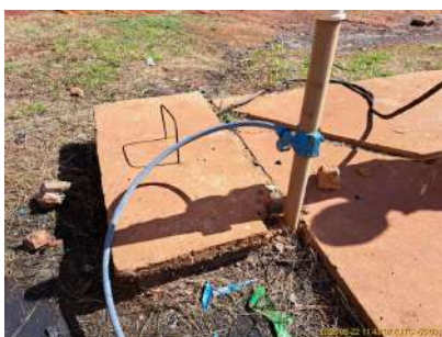
Foto 1 - Ponto de tomada de água bruta do Poço.
