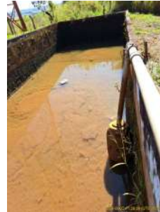
Foto 2 - Tanque de destinação de lodo das ETAs 1-2.
