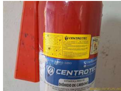
Foto 4 - Validade do extintor de incêndio.
