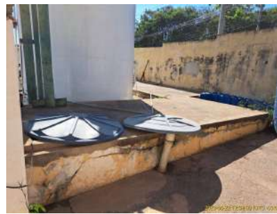
Foto 2 - Local de entrada de água tratada das ETAs 1 e 2, interceptada da rede de distribuição, indo para o reservatório de água tratada da ETA III
