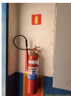
Foto 1 - Presença de extintor de incêndio, porém com validade vencida.
