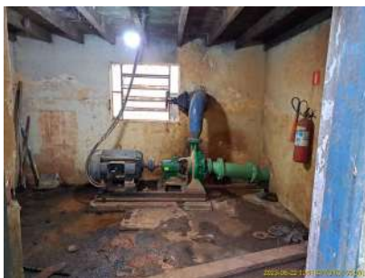
Foto 5 - Conjunto motobomba de menor porte (secundário)
