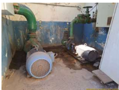
Foto 3 - Vista interna da elevatória, com os dois conjuntos motobomba (Bom Jardim à esquerda e Pombal à direita)
