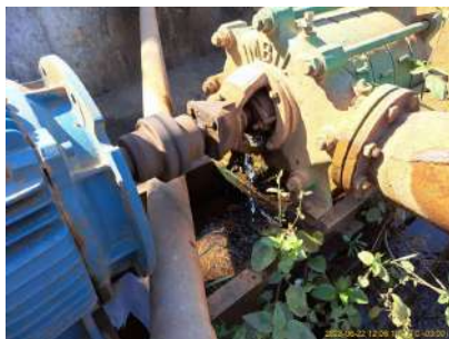
Foto 1 - Detalhe da água de lubrificação de gaxetas sem correta condução e afastamento do entorno do conjunto motobomba.
