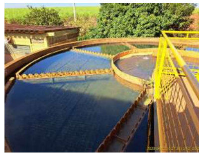
Foto 7 - Vista dos decantadores da ETA I.
