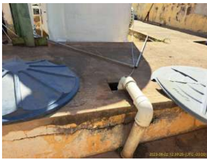
Foto 1 - Local de entrada de água tratada das ETAs 1 e 2, interceptada da rede de distribuição, indo para o reservatório de água tratada da ETA III
