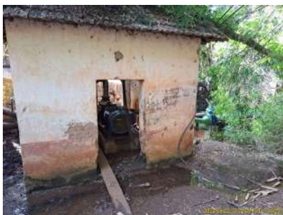
Foto 7 - Vista do outro lado do abrigo do conjunto motobomba de maior porte (e principal)
