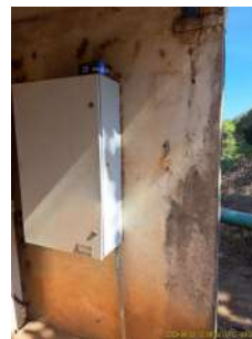
Foto 2 - Detalhe do suporte de extintor de incêndio ao lado do painel elétrico.
