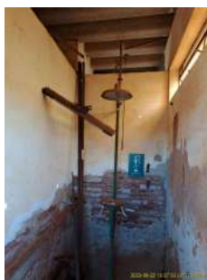
Foto 1 - Chuveiro de emergência com luminária caída.
