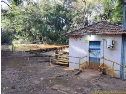
Foto 14 - Vista da Represa de Captação (à esquerda) e do abrigo dos painéis elétricos (à direita), sendo que os conjuntos motobomba estão situados abaixo do abrigo.
