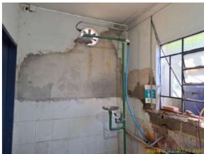
Foto 1 - Chuveiro de emergência.
