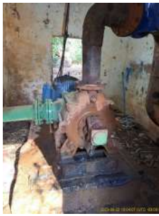
Foto 1 - Vazamento no conjunto motobomba principal (de maior porte).
