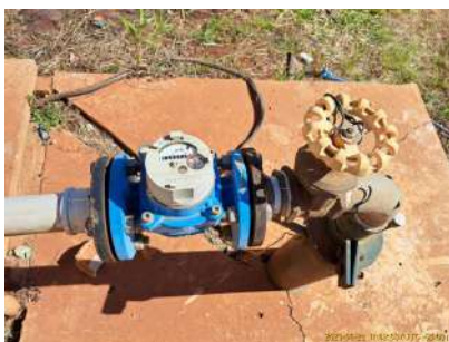
Foto 1 - Macromedidor do Poço.
