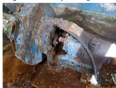
Foto 4 - Detalhe da drenagem inadequada da água de lubrificação das gaxetas.
