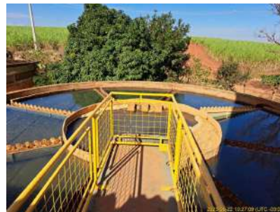
Foto 8 - Vista dos decantadores da ETA I.
