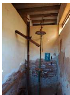
Foto 2 - Chuveiro de emergência com luminária caída.
