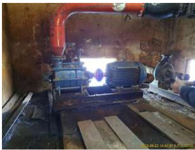
Foto 3 - Conjunto motobomba (1+0R) em operação na Captação.
