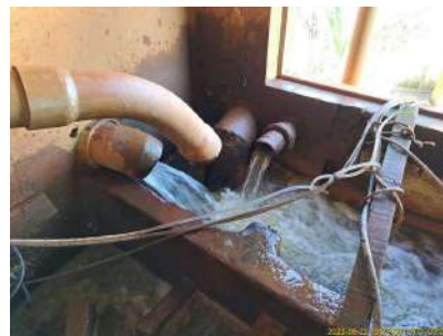
Foto 10 - Local de chegada da água bruta na ETA I e adição de produtos químicos.
