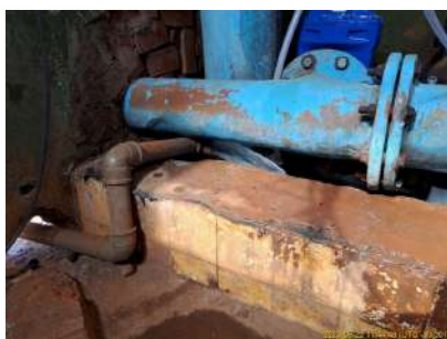
Foto 1 - A cloração e fluoretação é feita no tanque de água tratada das ETAs 1-2.
