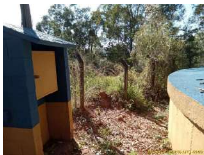
Foto 1 - Trecho do perímetro sem cerca.
