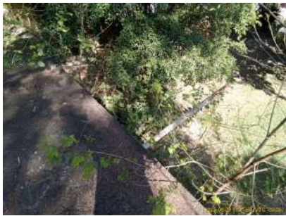
Foto 1 - Extravasador aberto sem tela de proteção.
