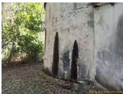
Foto 1 - Vazamento na parede externa do reservatório.
