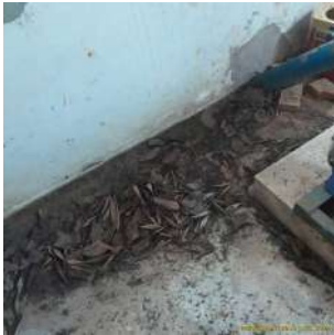
Foto 4 - Acúmulo de matéria orgânica.
