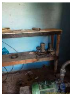
Foto 2 - Resíduos sólidos acumulados no interior da EEA.
