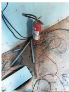
Foto 1 - Extintor no interior da EEA.
