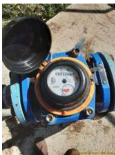
Foto 1 - Macromedidor do poço.
