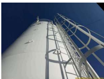
Foto 1 - Guarda-corpo do reservatório.
