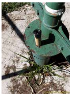
Foto 1 - Tubo de medição de nível.
