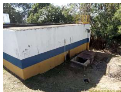
Foto 4 - Vazamento na parede externa do R4 (70m³).
