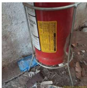
Foto 1 - Validade do extintor vencida.
