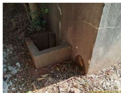
Foto 2 - Vazamento na parede externa do reservatório.
