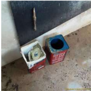
Foto 3 - Acúmulo de resíduos de construção civil.
