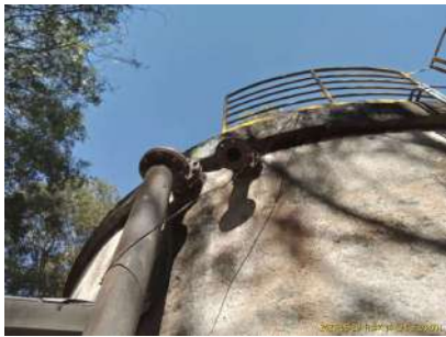
Foto 3 - Extravador sem tela de proteção.
