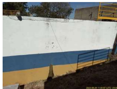
Foto 2 - Vazamento na parede externa do R4 (70m³).
