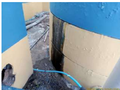
Foto 1 - Vazamento na parede externa do reservatório cilíndrico.
