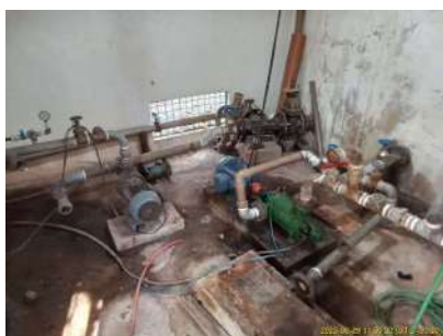
Foto 1 - Vista interna da casa de bombeamento.
