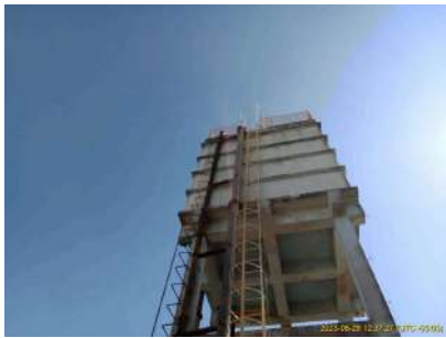
Foto 1 - Tubo extravasor do reservatório.
