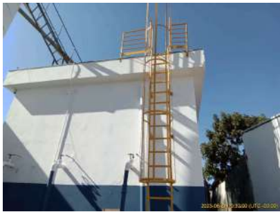
Foto 1 - Guarda-corpo no reservatório quadrado.
