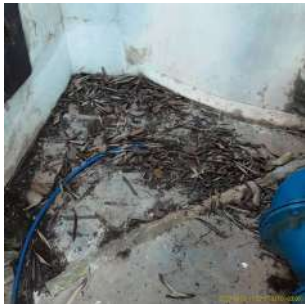
Foto 1 - Acúmulo de matéria orgânica.
