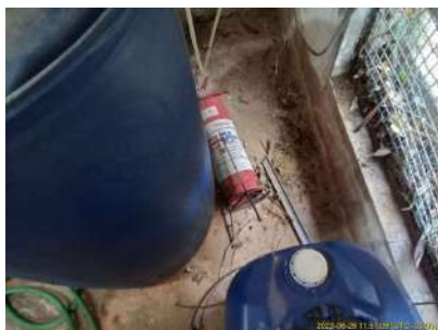
Foto 1 - Extintor mal posicionado.
