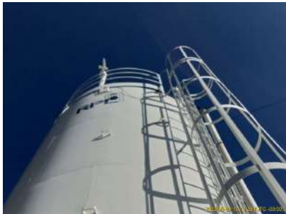
Foto 1 - Abertura do extravasor sem tela de proteção.
