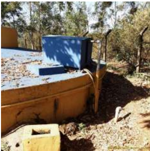
Foto 1 - Vista do booster apoiado sobre a laje do reservatório.
