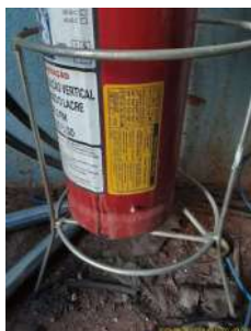
Foto 1 - Validade do extintor expirada.
