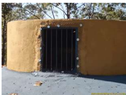
Foto 1 - A tela instalada não protege contra entrada de insetos.
