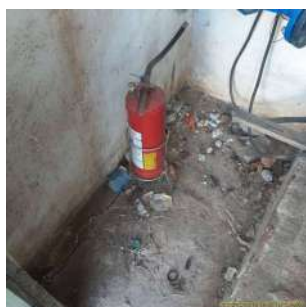
Foto 1 - Extintor de incêndio da EEA.
