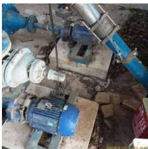
Foto 1 - Conjunto de moto bombas.
