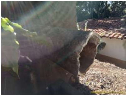
Foto 2 - Ausência de tela no tubo extravasor.
