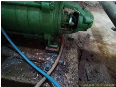
Foto 1 - Drenagem da gaxeta.
