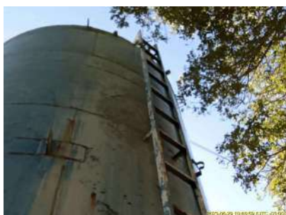
Foto 1 - Extravisor sem tela de proteção.
