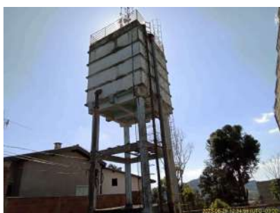
Foto 1 - Guarda-corpo do reservatório.
