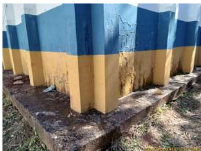
Foto 1 - Vazamento na parede externa do R5 (50m³).
