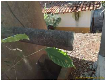
Foto 1 - Ausência de tela no tubo extravasor.
