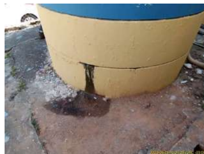
Foto 2 - Vazamento na parede externa do reservatório cilíndrico.
