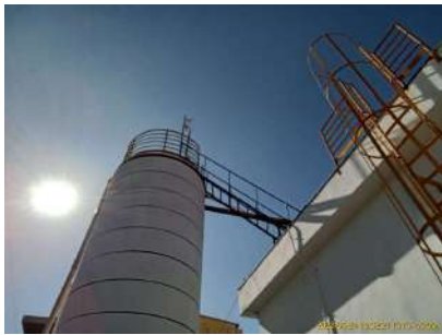
Foto 2 - Guarda-corpo no reservatório cilíndrico.
