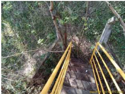
Foto 1 - Arbusto atrapalhando o acesso à escada do reservatório.
