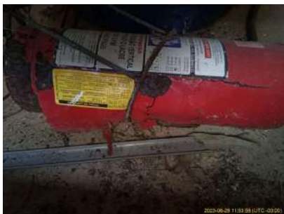
Foto 1 - Validade do extintor vencida.
