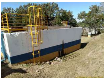
Foto 3 - Vazamento na parede externa do R4 (70m³).
