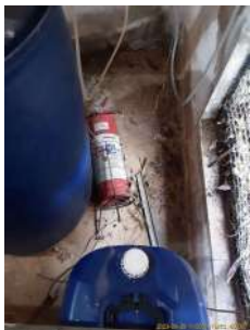
Foto 1 - Extintor em posição inadequada.
