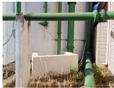
Foto 6 - Tubo extravasor do Reservatório.
