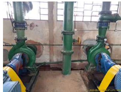
Foto 14 - Conjuntos motobomba B3 e B4.
