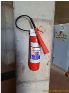
Foto 2 - Extintor de incêndio da estação elevatória.
