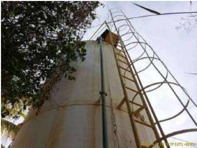
Foto 2 - Tubo extravasor do Reservatório.
