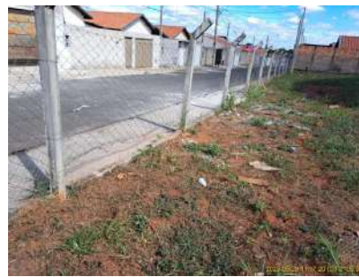
Foto 2 - Deformações na cerca no entorno do Reservatório.
