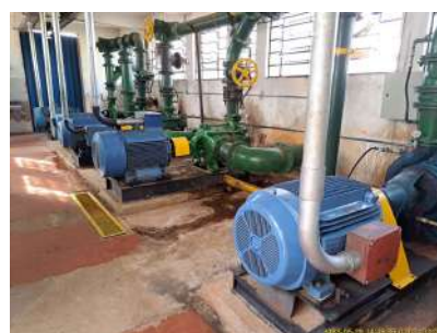
Foto 6 - Conjuntos motobomba da Estação elevatória.
