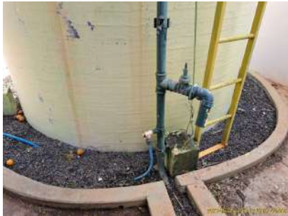
Foto 1 - Tubo extravasor do Reservatório.
