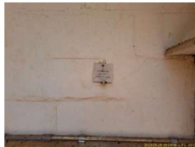
Foto 4 - Extintor de incêndio ausente no momento da fiscalização.
