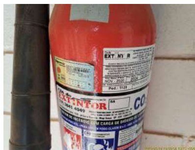
Foto 2 - Validade do extintor de incêndio.
