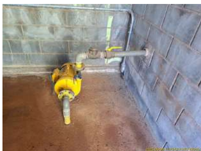
Foto 4 - Conjunto motobomba que envia água tratada do Res. Apoiado Chaparral para o Res. Elevado Chaparral.
