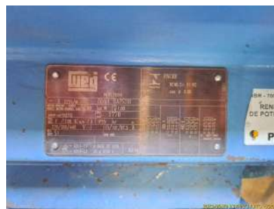
Foto 7 - Especificações técnicas do motor de um dos conjuntos motobomba 3/4.
