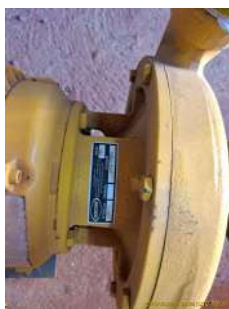
Foto 6 - Especificações técnicas da bomba do conjunto motobomba Res. Apoiado - Res. Elevado Chaparral.
