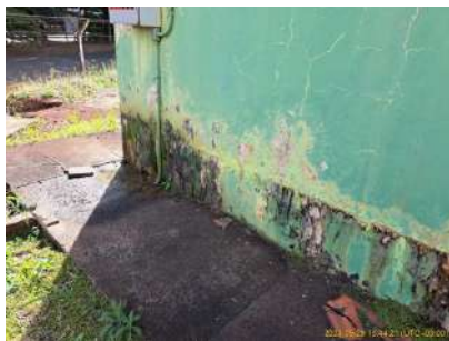
Foto 1 - Pontos com vazamentos na lateral do Reservatório apoiado.
