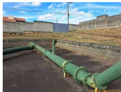
Foto 2 - Telas de proteção na tubulação de ventilação.
