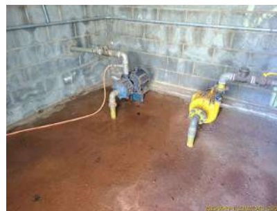
Foto 2 - Piso com água dentro da estação elevatória.
