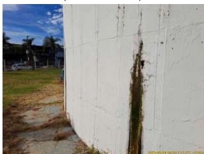
Foto 3 - Vazamentos na lateral do Reservatório (célula inferior).
