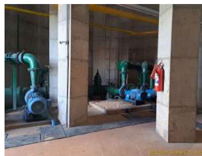
Foto 4 - Vista do interior da estação elevatória e do extintor de incêndio.
