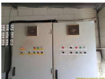
Foto 3 - Vista do painel de comando da estação elevatória..
