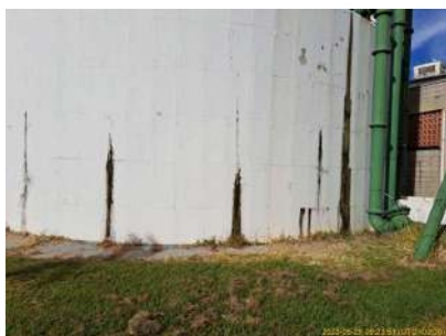
Foto 1 - Vazamentos na lateral do Reservatório (célula inferior).
