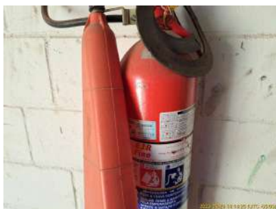
Foto 1 - Detalhe da validade do extintor de incêndio.
