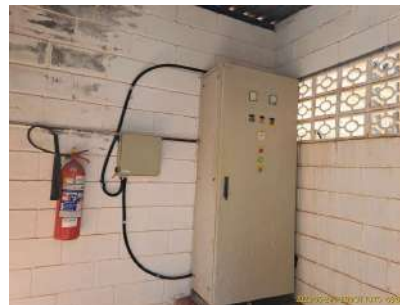
Foto 4 - Vista do painel de comando do Poço.
