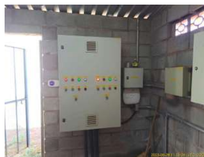
Foto 9 - Painel elétrico de comando dos conjuntos motobomba.
