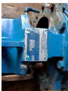
Foto 8 - Especificações técnicas da bomba de um dos conjuntos motobomba 3/4.
