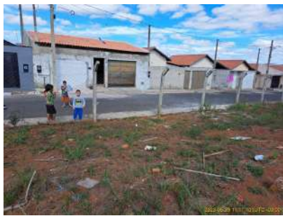
Foto 1 - Buraco e deformação da cerca (próximo ao solo), com possibilidade de entrada de pessoas (como foi verificado durante a fiscalização).
