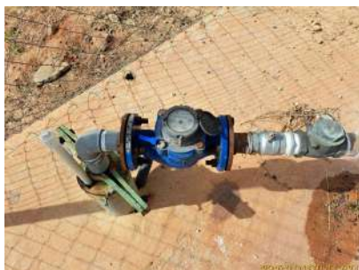
Foto 1 - Macromedidor do Poço.
