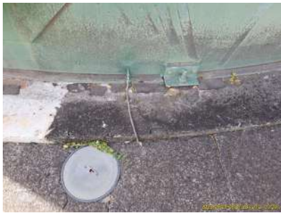
Foto 1 - Cabo de aterramento do Reservatório.
