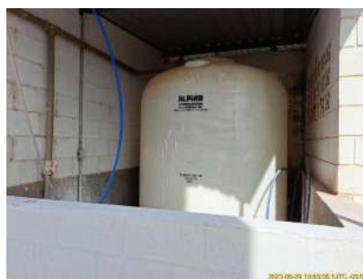
Foto 2 - Tanque de hidróxido de cálcio.
