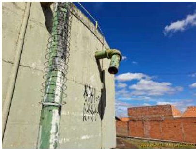
Foto 1 - Tubo extravasor do Reservatório.
