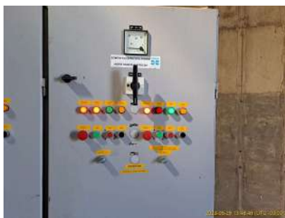
Foto 3 - Paineis de comando dos conjuntos motobombas responsáveis pelo atendimento ao Res. Elevado Zaniboni.
