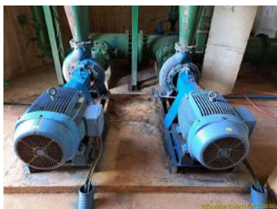
Foto 6 - Conjuntos motobomba 3 e 4 (Res. elevado Zaniboni).
