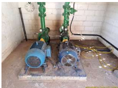
Foto 1 - Conjuntos motobomba da Estação elevatória de água Jardim Alvorada
