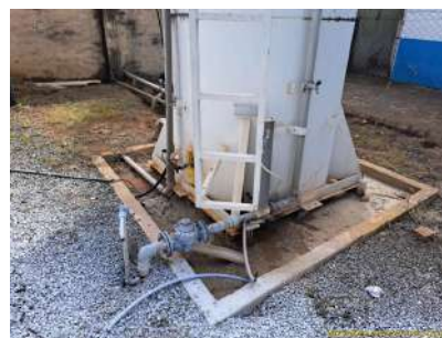
Foto 6 - Tomada de água bruta e macromedidor situados antes da cloração e fluoretação.
