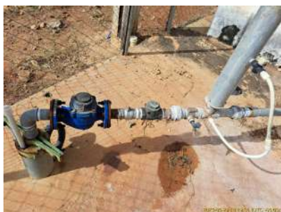
Foto 1 - Tomada de água na tubulação do Poço.
