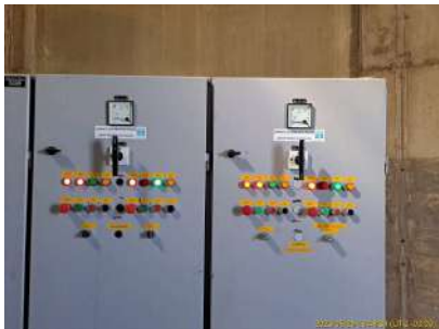
Foto 1 - Paineis de comando dos conjuntos motobombas responsáveis pelo atendimento ao Res. Chaparral e Elevado Zaniboni.
