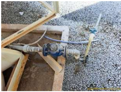
Foto 1 - Macromedidor do Poço situado na chegada ao Reservatório.
