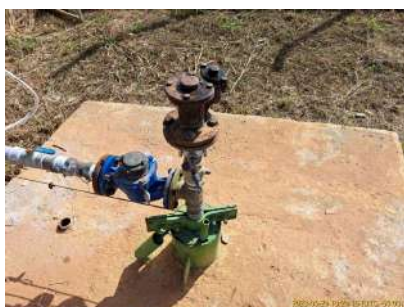
Foto 1 - Tubo para medição de nível do Poço.
