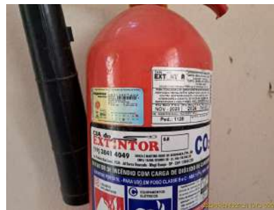
Foto 2 - Validade do extintor de incêndio.
