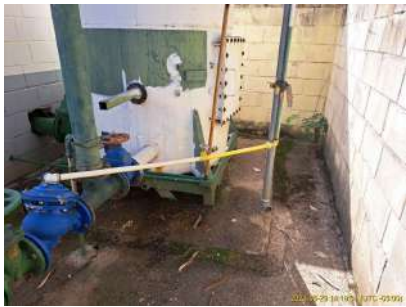
Foto 1 - Tubo extravasor do Reservatório.
