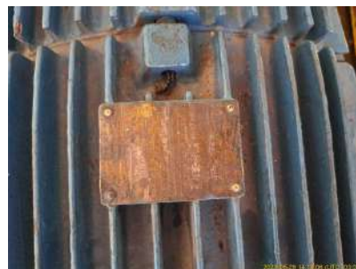
Foto 2 - Placa de identificação e especificações técnicas do motor de um dos conjuntos motobomba (50 cv).
