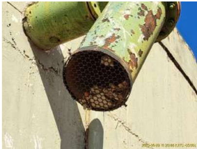
Foto 1 - Materiais no interior do tubo extravasor, presos à tela de proteção, indicando que estavam no interior do reservatório.
