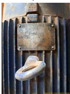
Foto 8 - Especificações técnicas do motor do conjunto motobomba Res. Apoiado - Res. Eldorado.
