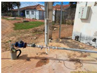
Foto 1 - Sistema de cloração e fluoretação na saída do Poço.
