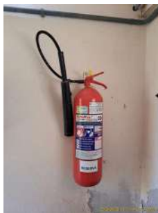
Foto 1 - Validade do extintor de incêndio.
