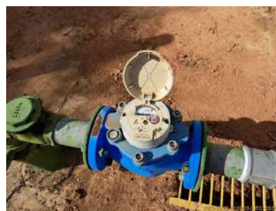
Foto 2 - Macromedidor do Poço.
