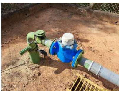
Foto 1 - Macromedidor do Poço.
