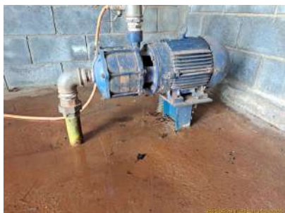
Foto 3 - Detalhe do vazamento no conjunto motobomba na cor azul.
