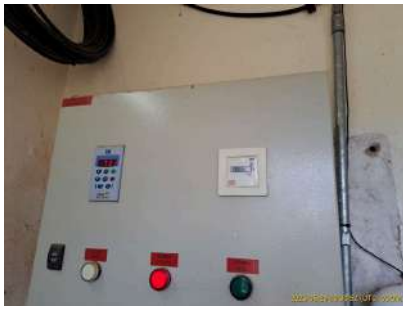
Foto 3 - Vista do painel de comando do Poço.
