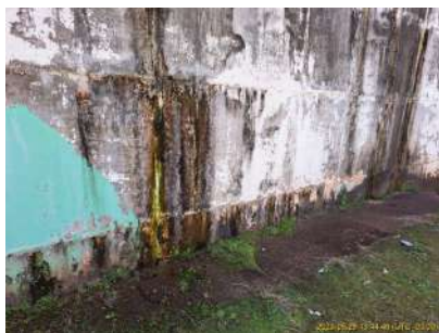
Foto 3 - Pontos com vazamentos na lateral do Reservatório apoiado.
