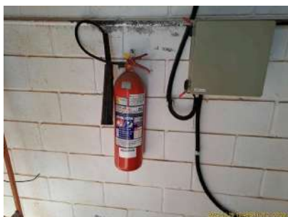
Foto 1 - Validade do extintor de incêndio.
