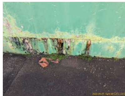
Foto 2 - Pontos com vazamentos na lateral do Reservatório apoiado.
