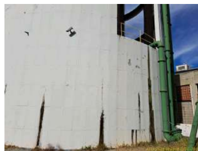
Foto 2 - Vazamentos na lateral do Reservatório (célula inferior).
