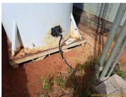
Foto 1 - Ponto de monitoramento do sistema de telemetria.
