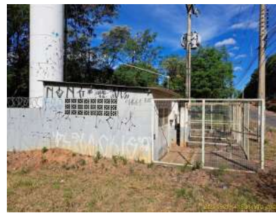
Foto 6 - Vista da Estação elevatória e, ao lado, o Reservatório elevado Jd. Alvorada.
