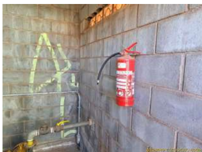
Foto 1 - Extintor de incêndio dentro da estação elevatória.
