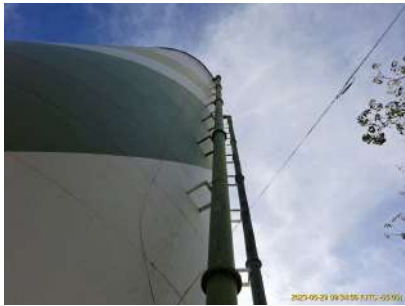
Foto 1 - Tubo extravasor do Reservatório.
