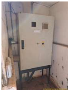
Foto 3 - Vista do painel de comandos do Poço Chácara Alvorada 2.
