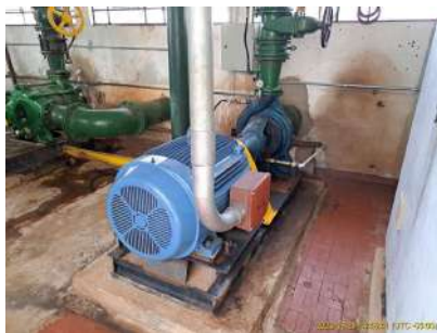
Foto 7 - Conjunto motobomba B0
