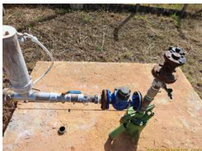
Foto 1 - Macromedidor do Poço.
