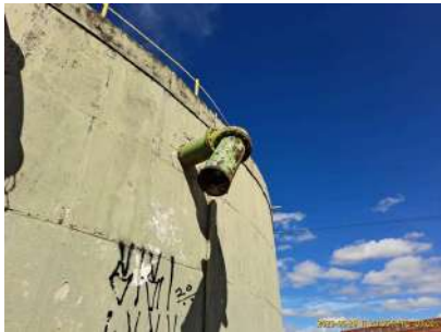
Foto 2 - Materiais no interior do tubo extravasor, presos à tela de proteção, indicando que estavam no interior do reservatório.
