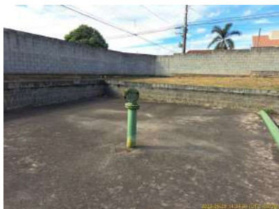
Foto 1 - Telas de proteção na tubulação de ventilação.
