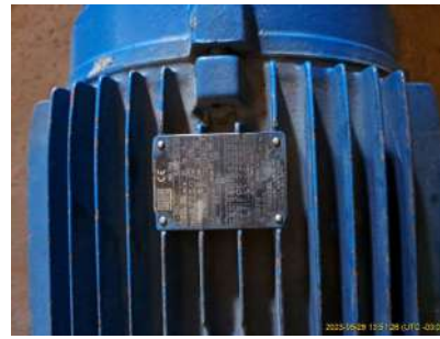
Foto 13 - Especificações técnicas do motor do conjunto motobomba 5.
