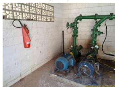
Foto 4 - Conjuntos motobomba da Estação elevatória de água Jardim Alvorada
