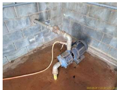
Foto 7 - Conjunto motobomba que envia água tratada do Res. Apoiado Chaparral para o Res. Eldorado.
