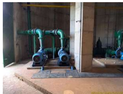
Foto 5 - Conjuntos motobomba 3 e 4 (Res. elevado Zaniboni).
