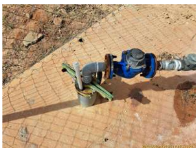
Foto 1 - Tubo medidor de nível.
