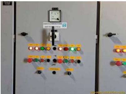
Foto 2 - Paineis de comando dos conjuntos motobombas responsáveis pelo atendimento ao Res. Chaparral.
