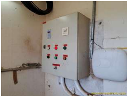
Foto 2 - Vista do painel de comando do Poço.
