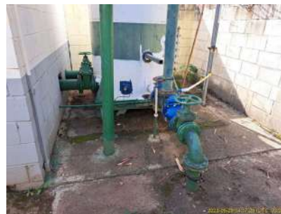
Foto 2 - Ponto de monitoramento por telemetria e tubulação de conexão com a EEAT.
