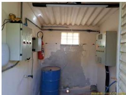
Foto 1 - Extintor de incêndio dentro da sala de abrigo do painel de comando.
