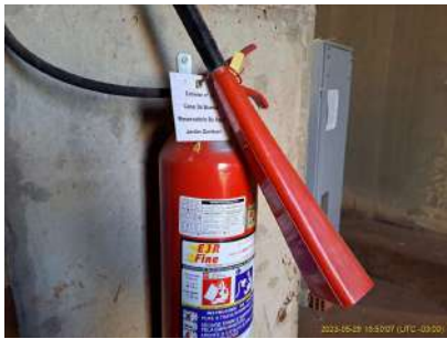
Foto 1 - Extintor de incêndio da estação elevatória.
