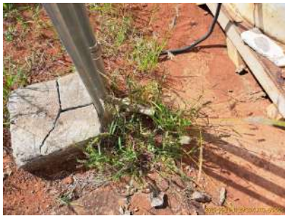
Foto 1 - Tubo extravasor do Reservatório.
