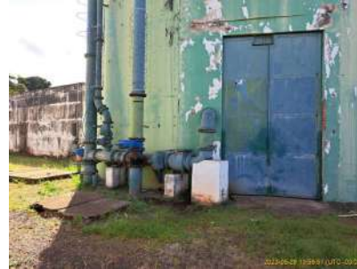
Foto 15 - Entrada da Estação Elevatória na base do Res. Elevado Zaniboni
