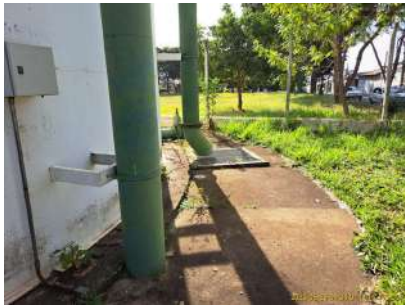
Foto 2 - Tubo extravasor do Reservatório.
