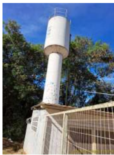
Foto 5 - Vista da Estação elevatória e, ao lado, o Reservatório elevado Jd. Alvorada.
