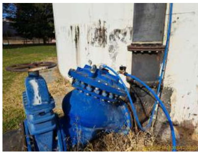
Foto 5 - Ponto de monitoramento por telemetria na entrada do Reservatório.
