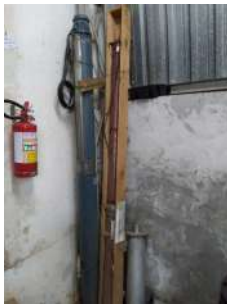
Foto 1 - Bomba reserva do Poço Chácara Alvorada 1 em estoque. (Fonte: SAMAE Mogi Guaçu, 20/06/2023)
