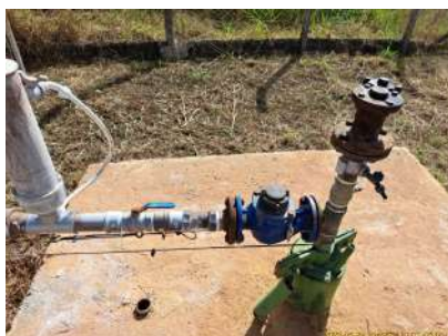
Foto 1 - Torneira para tomada de água bruta.
