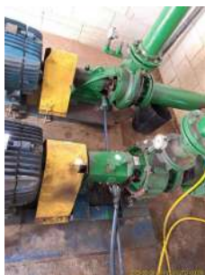
Foto 1 - Detalhe para a drenagem das gaxetas dos conjuntos motobomba.
