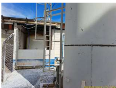
Foto 1 - Baía do tanque de hidróxido de cálcio ao lado do Reservatório elevado.
