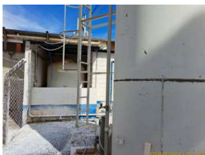
Foto 7 - Baia do tanque de hidróxido de cálcio situada ao lado do Reservatório.
