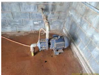
Foto 1 - Detalhe do vazamento no conjunto motobomba na cor azul.
