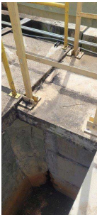
Foto 3 - Local do vazamento
