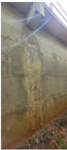
Foto 1 - Vazamento antigo (resolvido)
