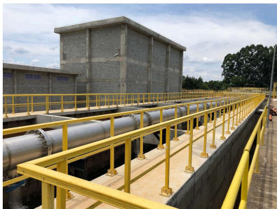
Foto 1 - Vista geral da ETE
