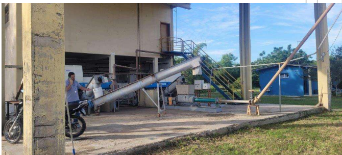
Foto 6 - Sistema de lodo
