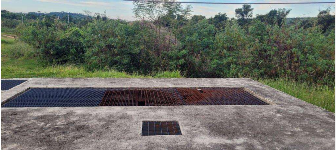
Foto 7 - Grade do piso em estado de oxidação
