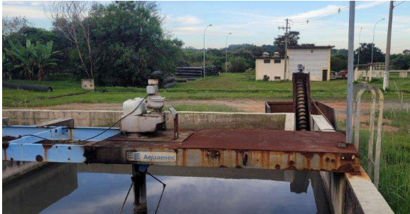
Foto 5 - Rosca trasportadora de resíduos em péssimas condições
