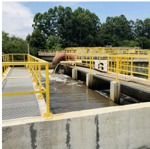
Foto 3 - Tanque de aeração
