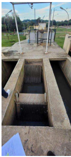
Foto 2 - Novo sistema de gradeamento
