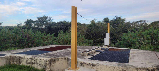
Foto 6 - Grade do piso em estado de oxidação
