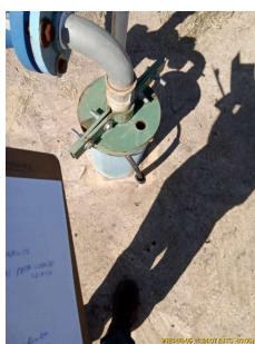
Foto 1 - Ausência de tubo medidor de nível no poço
