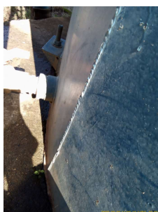
Foto 1 - Chão úmido no momento da fiscalização
