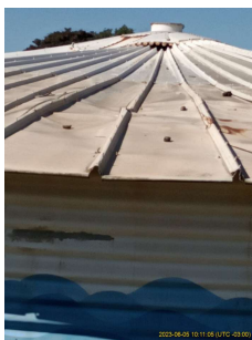
Foto 1 - Abertura na cobertura do Reservatório Apoiado
