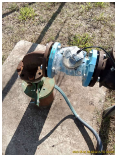
Foto 1 - Macromedidor conectado a sistema de telemetria do Poço Sacilotto II Poço 3
