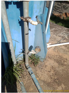
Foto 1 - Manômetro na base de reservatório
