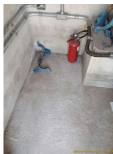
Foto 4 - Presença de extintor
