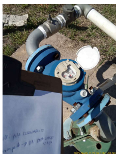
Foto 1 - Macromedidor do Poço Vila Nogueira
