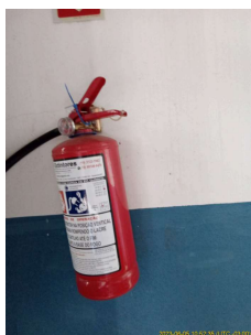
Foto 1 - Extintor de incêndio no local
