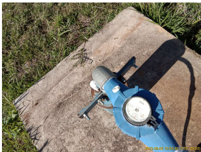
Foto 1 - Macromedidor do Poço Sacilotto II Poço 2
