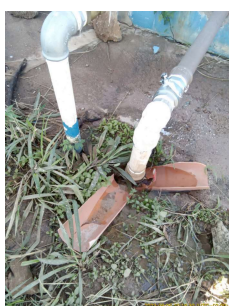
Foto 1 - Vazamento no registro
