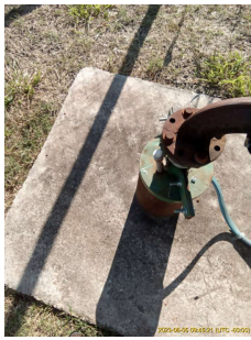
Foto 1 - Tubo medidor de nível
