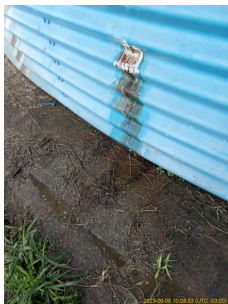
Foto 1 - Ponto de vazamento com chão enxarcado
