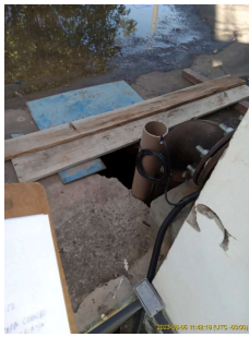
Foto 1 - Abertura na região da tampa de inspeção do Reservatório semi-enterrado
