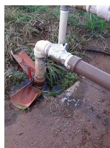
Foto 2 - Vazamento no registro (2)
