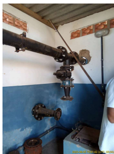
Foto 1 - Local de instalação da moto bomba reserva
