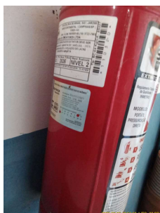
Foto 1 - Indicação de validade do extintor
