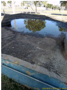
Foto 1 - Cobertura desnivelada, com região com acúmulo de água pluvial no reservatório semi-enterrado
