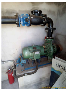
Foto 3 - Bomba do Reservatório
