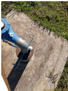
Foto 1 - Tubo medidor de nível
