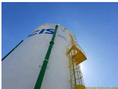
Foto 3 - Guarda-corpos nas escadas e na cobertura do Reservatório
