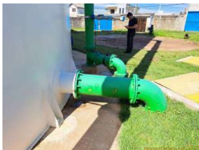
Foto 3 - Vazamentos aparentes nas junções da tubulação - Novo Reservatório Potiguará
