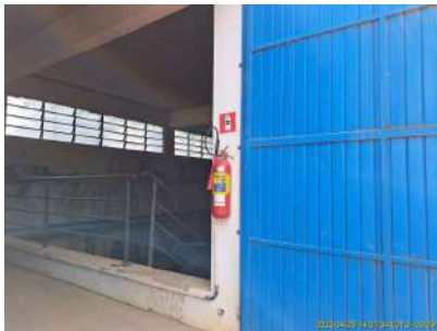
Foto 1 - Extintor de incêndio da EEAB
