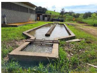
Foto 1 - Caixa de areia da Captação Mombaça.
