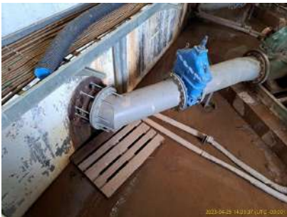
Foto 1 - Vazamentos na parede do tanque de equalização, adentrando na área da EEAB.
