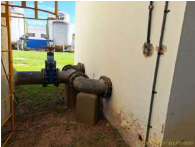
Foto 2 - Tubulação entre Reservatório de água tratada e EEAT
