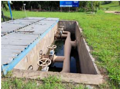
Foto 4 - Ausência de guarda-corpos no poço com registros de manobra das bombas de captação.
