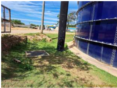
Foto 2 - Tubo extravasor do Res. Apoiado da ETA Rancho Grande.
