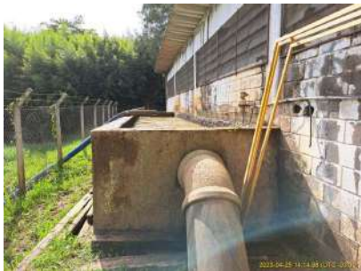
Foto 1 - Tanque de equalização.
