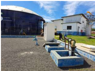
Foto 1 - Vista geral dos locais onde estão as bombas submersas e o painel elétrico.
