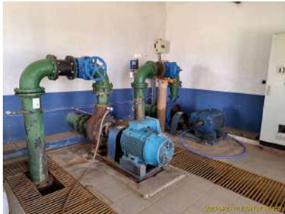
Foto 5 - Conjuntos motobomba responsáveis pelo abastecimento do Reservatório Terras de São José.
