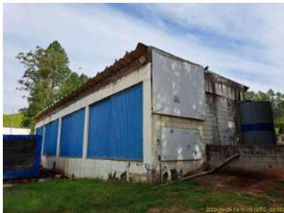
Foto 1 - Antiga placa de identificação, porém danificada pelo tempo.
