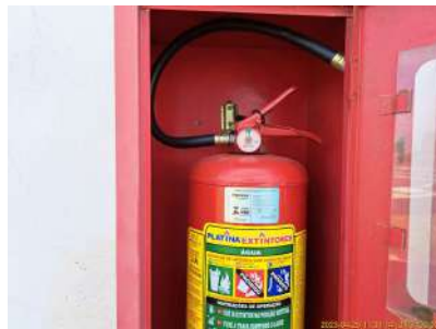
Foto 2 - Validade de um dos dois extintores de incêndio
