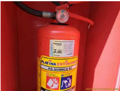
Foto 2 - Extintor de incêndio da Estação Elevatória.
