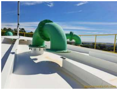
Foto 2 - Ausência de telas de proteção nas tubuações de ventilação da cobertura do Reservatório.
