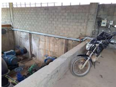
Foto 1 - Ausência de guarda-corpos em frente aos painéis de comando
