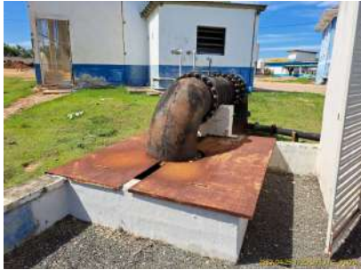
Foto 8 - Local onde está submersa a bomba anfíbia de 100 cv
