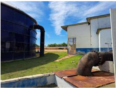
Foto 7 - Visto da tubulação de recalque da bomba anfíbia de 100 cv e da tubulação de chegada ao Novo Reservatório Apoiado da ETA Rancho Grande.
