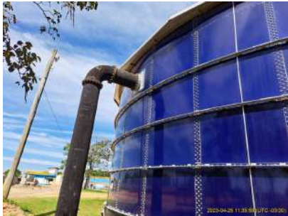
Foto 3 - Tubo extravasor do Res. Apoiado da ETA Rancho Grande.
