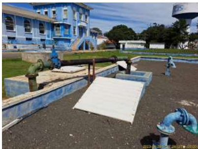
Foto 3 - Local onde está submersa a bomba submersível de 25 cv.
