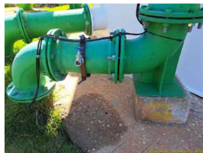
Foto 2 - Vazamentos aparentes nas junções da tubulação - Novo Reservatório Potiguará
