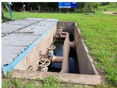
Foto 3 - Poço com os 04 conjuntos motobomba submersos - Captação Mombaça
