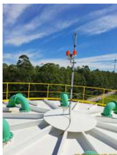
Foto 1 - Haste do para-raio do Reservatório.
