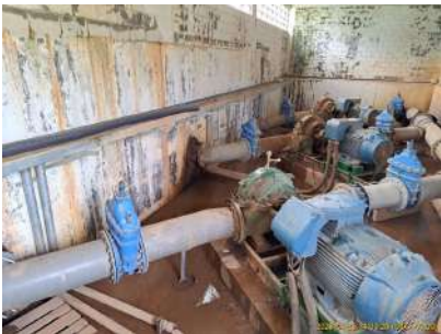
Foto 2 - Vazamentos na parede do tanque de equalização, adentrando na área da EEAB.
