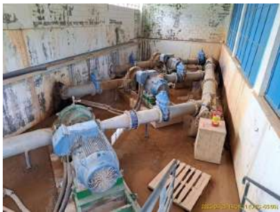
Foto 2 - Vista interna da EEAB Pau D´Alho
