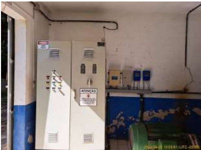
Foto 4 - Pannel elétrico dos conjuntos motobombas
