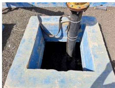
Foto 2 - Ausência de cobertura no local onde está submersa a bomba de 25 cv.
