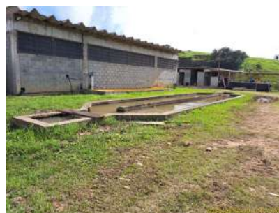
Foto 2 - Caixa de areia da Captação Mombaça.
