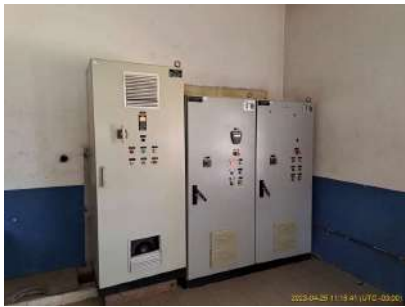
Foto 4 - Painelelétrico de todos os conjuntos da Estação Elevatória.
