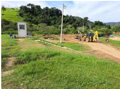
Foto 2 - Ausência de guarda-corpos na escada de acesso.
