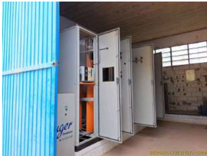
Foto 3 - Painel de comando da EEAB Pau D´Alho
