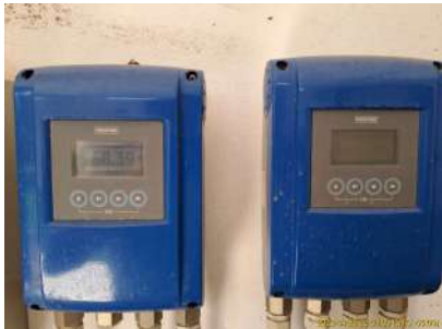
Foto 3 - Medidores de vazão da EEAT
