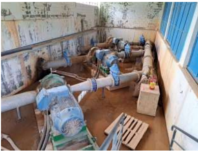
Foto 1 - Vazamentos da água de lubrificação das gaxetas, escoando pela base dos conjuntos motobomba.
