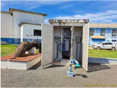
Foto 9 - Vista do local onde está submersa a bomba anfíbia de 100 cv e o painel elétrico das duas bombas.
