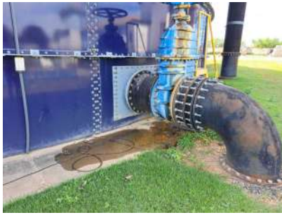
Foto 1 - Locais com vazamentos no Reservatório
