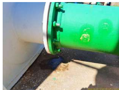
Foto 4 - Vazamentos aparentes nas junções da tubulação - Novo Reservatório Potiguará
