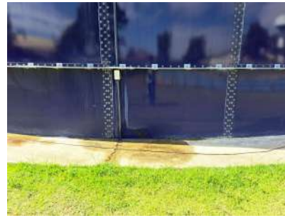
Foto 2 - Locais com vazamentos no Reservatório
