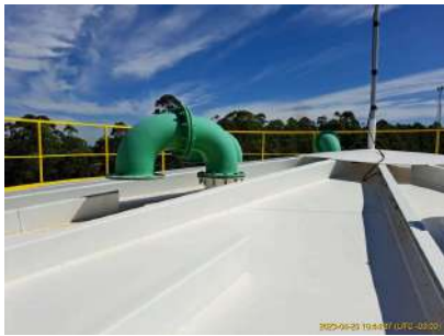
Foto 1 - Ausência de telas de proteção nas tubuações de ventilação da cobertura do Reservatório.
