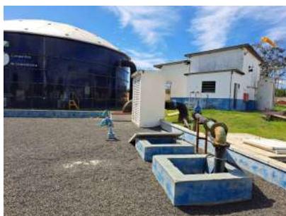
Foto 1 - Ausência de cobertura no local onde está submersa a bomba de 25 cv.
