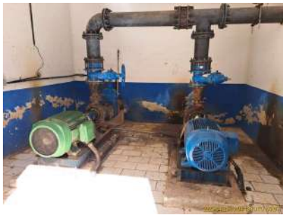
Foto 5 - Conjuntos motobomba (1+1R) da EEAT ETA Itaim para Bairro Potiguara
