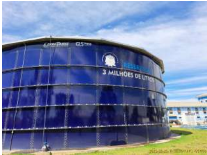
Foto 5 - Vista geral do Res. Apoiado da ETA Rancho Grande.
