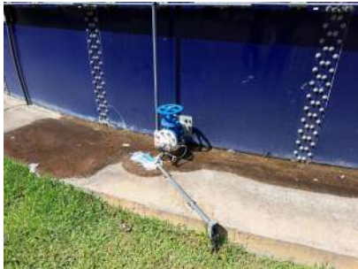
Foto 1 - Equipamento para medição de pressão na base do Reservatório.
