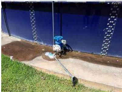
Foto 3 - Locais com vazamentos no Reservatório
