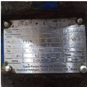
Foto 2 - Placa de identificação e especificação de uma das bombas reservas da Captação Pau D 'Alho
