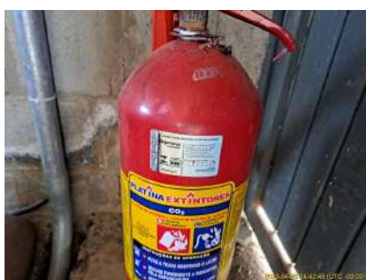
Foto 1 - Validade do extintor de incêndio.
