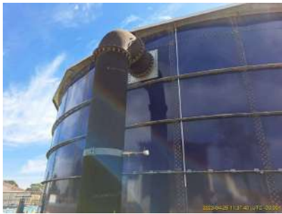
Foto 1 - Tubulação de chegada da EEAT RES. APOIADO RANCHO GRANDE
