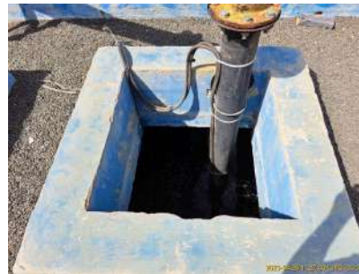
Foto 2 - Local onde está submersa a bomba submersível de 25 cv.
