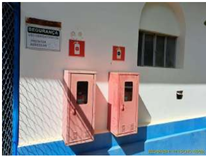
Foto 3 - Extintor de incêndio da Estação Elevatória.
