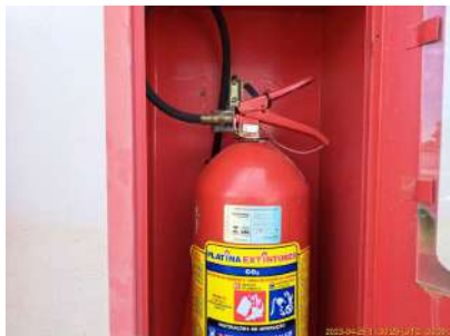
Foto 1 - Validade de um dos dois extintores de incêndio
