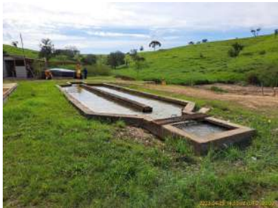
Foto 1 - Ausência de guarda-corpos no tratamento preliminar.
