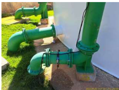
Foto 1 - Vazamentos aparentes nas junções da tubulação - Novo Reservatório Potiguará
