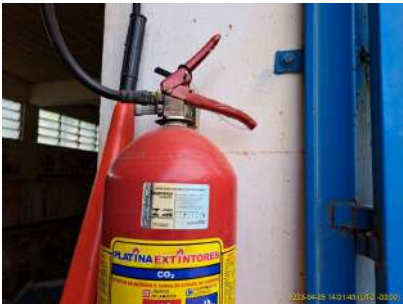
Foto 1 - Validade do extintor de incêndio.
