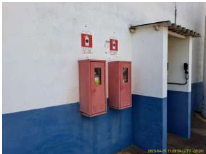
Foto 1 - Extintores de incêndio próximos ao painel elétrico.
