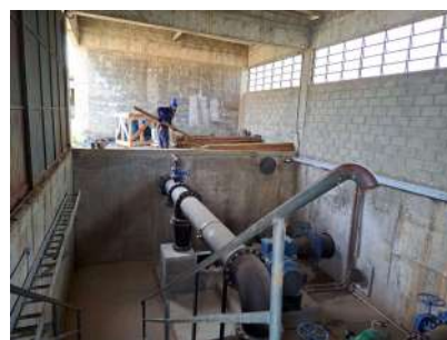
Foto 2 - Ausência de guarda-corpos do outro lado do poço (onde estão armazenadas tábuas e postes de madeira, tendo, inclusive, um trabalho no local).
