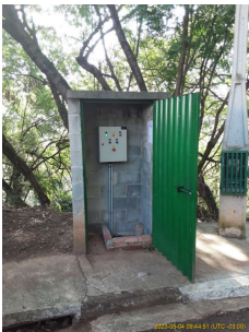
Foto 1 - Cabine do painel elétrico
