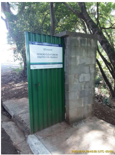
Foto 1 - Placa de identificação instalada
