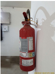
Foto 1 - Extintor de incêndio dentro do prazo da próxima manutenção
