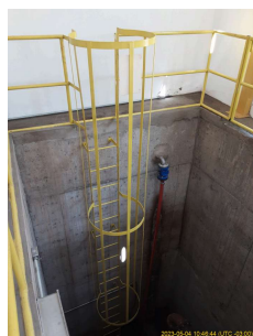
Foto 1 - Acesso aos conjuntos motobomba
