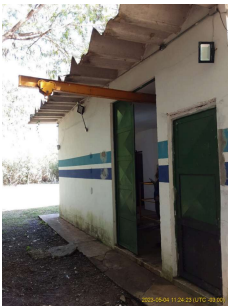
Foto 2 - Abrigo dos conjuntos motobomba
