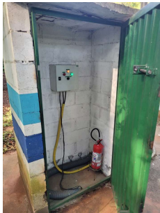
Foto 1 - Extintor de incêndio instalado
