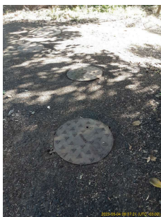
Foto 1 - Acesso ao conjunto motobomba
