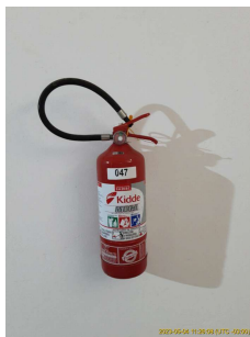
Foto 1 - Extintor de incêndio instalado
