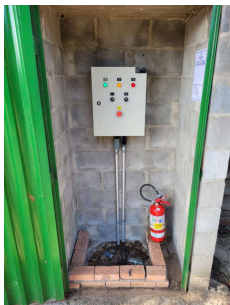
Foto 1 - Extintor de incêndio instalado
