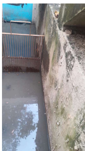
Foto 1 - Gradeamento grosseiro instalado
