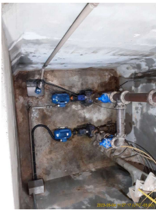
Foto 1 - Ausência de canaleta drenando um dos conjuntos motobomba
