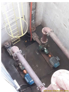
Foto 1 - Aparente vazamento próximo ao conjunto motobomba com canaleta instalada
