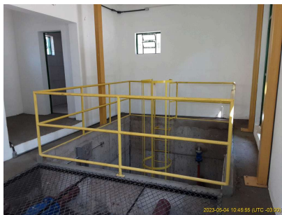
Foto 3 - Poço de acesso aos conjuntos motobomba
