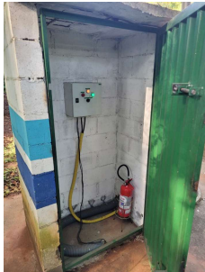
Foto 1 - Cabine do painel elétrico
