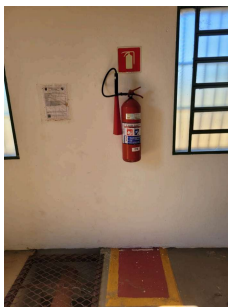
Foto 1 - Extintor de incêndio instalado
