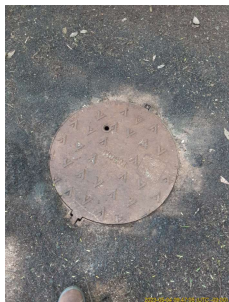
Foto 1 - Acesso ao conjunto motobomba
