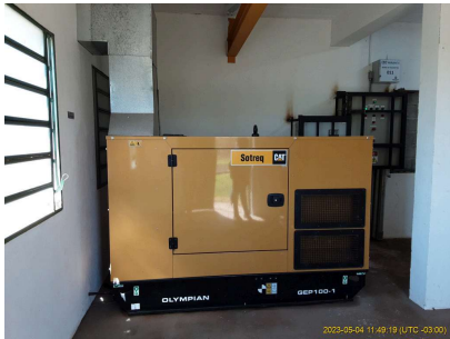
Foto 4 - Gerador no interior do abrigo
