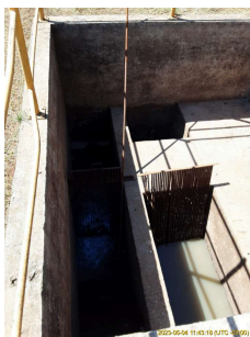
Foto 1 - Gradeamento instalado na entrada da elevatória
