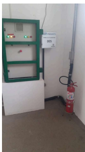
Foto 1 - Extintor de incêndio instalado
