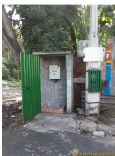
Foto 1 - Cabine do painel elétrico
