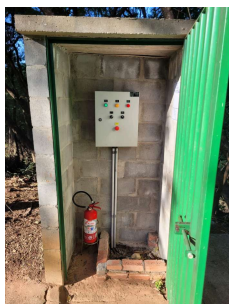
Foto 1 - Extintor de incêndio instalado
