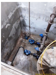
Foto 1 - Conjuntos motobomba instalados
