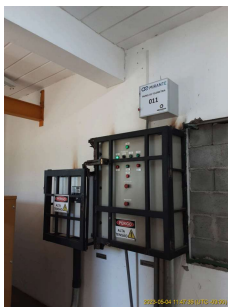
Foto 5 - Painel de telemetria no Interior do abrigo
