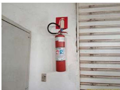
Foto 3 - Extintor de incêndio
