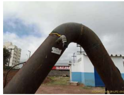
Foto 4 - Tomada para coleta de água bruta
