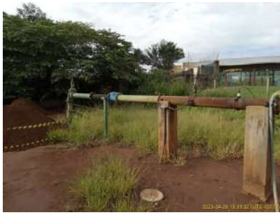
Foto 1 - Cavalete do poço Eco Tecnológico Damha
