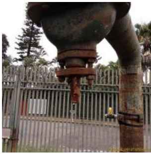
Foto 1 - Vazamento no registro
