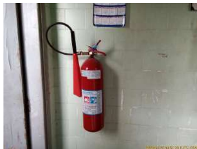
Foto 2 - Extintor de incêndio
