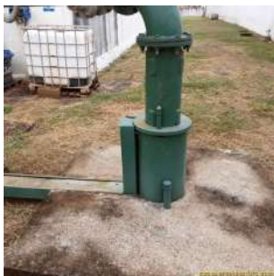
Foto 4 - Tubo de medição de nível
