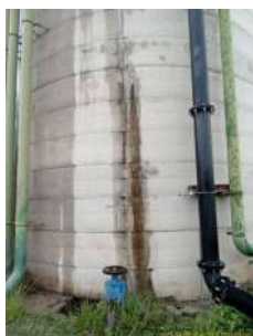
Foto 1 - Indícios de vazamentos no reservatório Village Damha III
