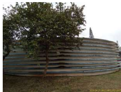
Foto 2 - Reservatório Rui Barbosa (circular)
