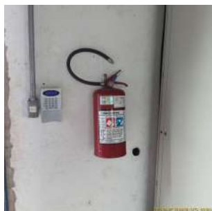
Foto 3 - Extintor de Incêndio
