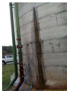
Foto 4 - Indícios de vazamentos no reservatório Village Damha III
