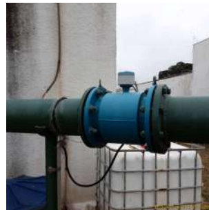
Foto 2 - Medidor de vazão do poço
