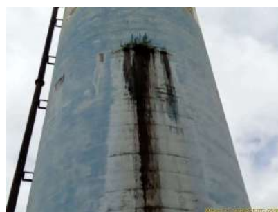
Foto 2 - Indícios de vazamentos aparentes no reservatório Cruzeiro do Sul
