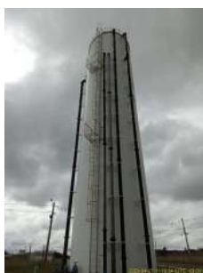
Foto 3 - Escada de acesso e guarda-corpo do reservatório Jardim do Bosque
