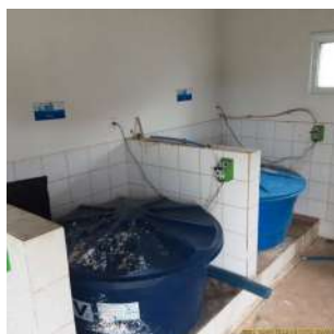
Foto 1 - Dosagem e armazenamento de cloro e flúor
