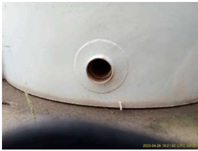
Foto 3 - Saída do tubo extravasor
