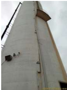
Foto 1 - Inexistência de para-raios
