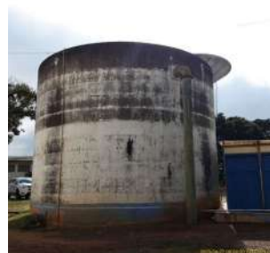
Foto 2 - Reservatório Vila Nery - Apoiado
