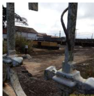
Foto 2 - Ausência de tela de proteção na tubulação de ventilação
