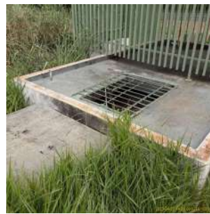
Foto 2 - Poço de sucção de esgoto bruto
