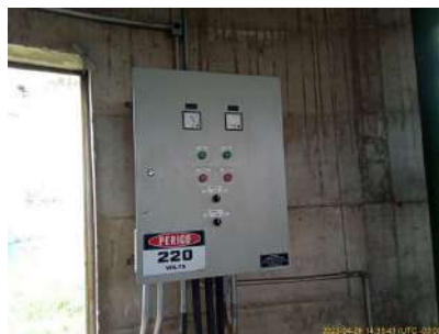
Foto 4 - Pannel de comando e acionamento dos conjuntos motobombas
