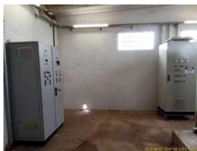
Foto 2 - Pannel de comando e acionamento dos conjuntos motobombas
