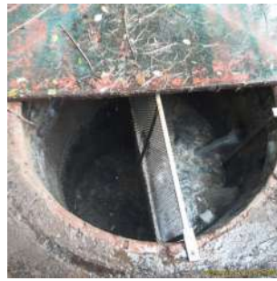
Foto 2 - Chegada do esgoto bruto
