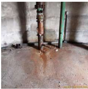
Foto 3 - Ponto de dosagem de cloro e flúor
