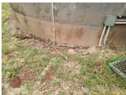
Foto 1 - Ausência de aterramento
