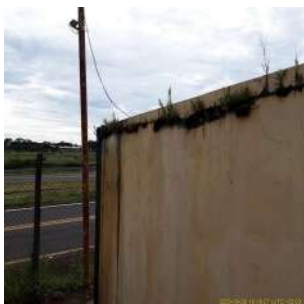
Foto 1 - Ausência de conservação (vegetação nas paredes)
