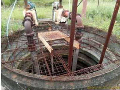
Foto 3 - Tampa de proteção danificada
