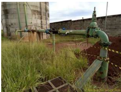
Foto 4 - Tubo de medição de nível
