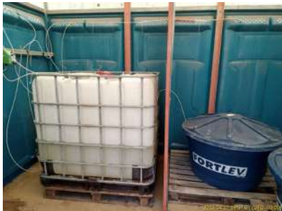
Foto 2 - Armazenamento e dosagem de cloro e flúor
