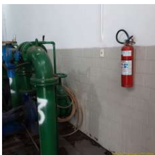
Foto 5 - Extintor de incêndio
