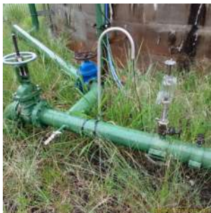
Foto 4 - Medidor de vazão do poço
