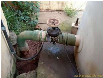
Foto 1 - Vazamento no registro
