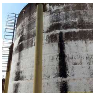
Foto 3 - Indícios de vazamentos no reservatório Vila Nery
