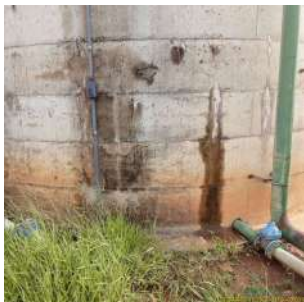
Foto 3 - Indícios de vazamentos no reservatório Eco Tecnológico Damha
