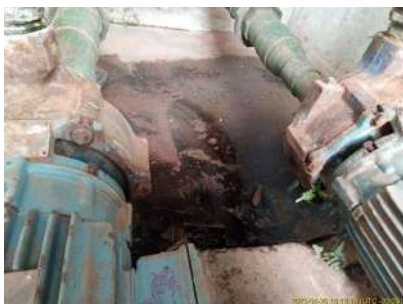
Foto 1 - Rompimento do selo da bomba
