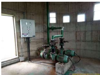
Foto 3 - Vista do interior da estação elevatória Village Damha I
