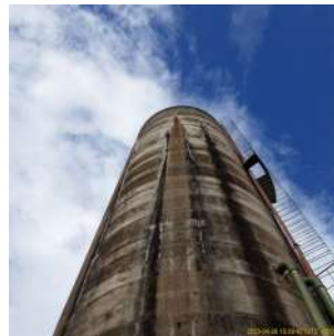
Foto 2 - Indícios de vazamentos no reservatório Eco Tecnológico Damha
