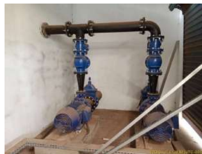
Foto 4 - Conjuntos motobombas I
