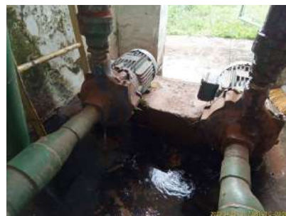
Foto 2 - Rompimento do selo da bomba
