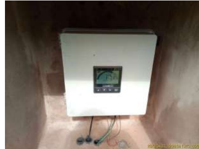
Foto 6 - Display do medidor de vazão do poço Vila Nery
