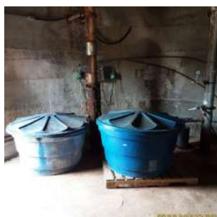
Foto 1 - Armazenamento e dosagem de produto químico
