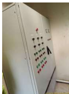
Foto 2 - Pannel de comando e acionamento dos conjuntos motobombas
