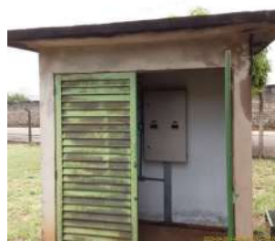
Foto 2 - Painel de comando e controle
