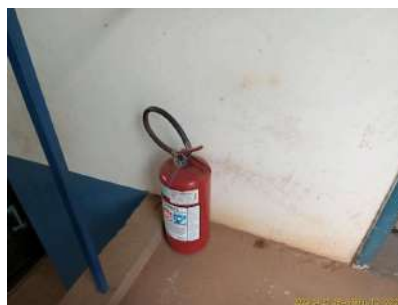
Foto 4 - Extintor de incêndio
