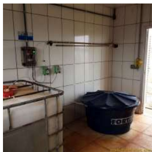
Foto 1 - Armazenamento e dosagem de produto químico
