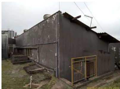
Foto 1 - Vista externa da estação elevatória ETA C. Botelho Boa Vista e São Sebastião
