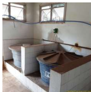
Foto 4 - Armazenamento e dosagem de produto químico
