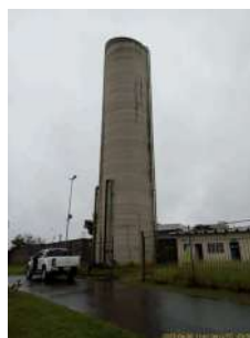
Foto 2 - Reservatório Village Damha III
