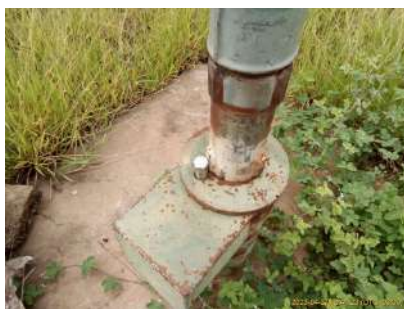
Foto 3 - Tubo de medição de nível do poço Jardim Embaré
