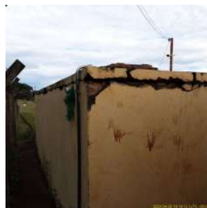
Foto 2 - Ausência de conservação (paredes com reboco danificado)
