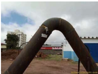
Foto 1 - Vazamento no registro da tomada para coleta de água
