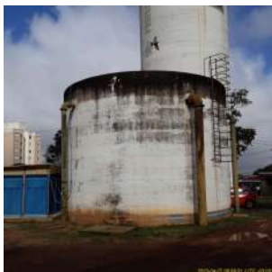
Foto 1 - Reservatório Vila Nery - Apoiado
