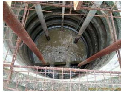
Foto 4 - Poço de sucção
