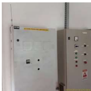
Foto 1 - Painel de comando e acionamento dos conjuntos motobombas
