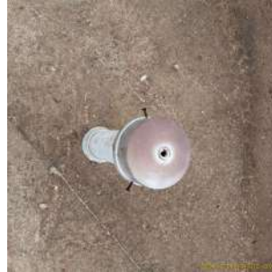
Foto 6 - Ausência de CAP
