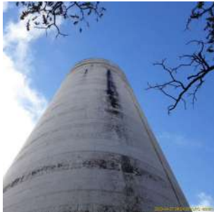
Foto 1 - Indícios de vazamentos no reservatório Vila Nery
