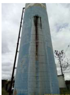
Foto 1 - Indícios de vazamentos aparentes no reservatório Cruzeiro do Sul
