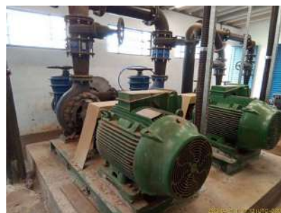
Foto 5 - Conjuntos motobombas II
