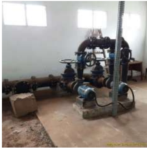
Foto 1 - Interior da estação elevatória CDHU
