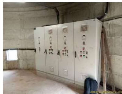
Foto 2 - Painel de comando e acionamento dos conjuntos motobombas
