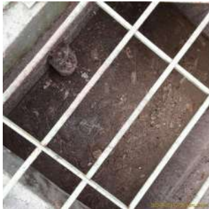
Foto 1 - Vista do poço de sucção, com acúmulo de resíduos na superfície.
