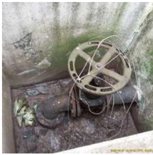
Foto 1 - Vazamento na válvula de recalque
