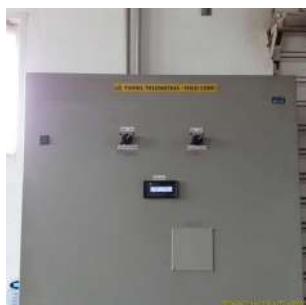
Foto 3 - Display do medidor de vazão do poço
