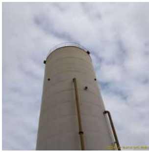
Foto 1 - Ausência de tela de proteção
