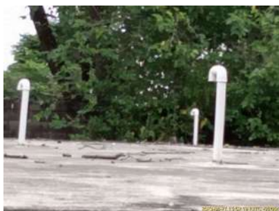
Foto 1 - Ausência de tela de proteção nas tubulações de ventilação
