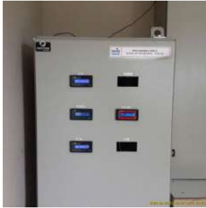
Foto 1 - Pannel de Telemetria, com medição de vazão do poço Damha Capela
