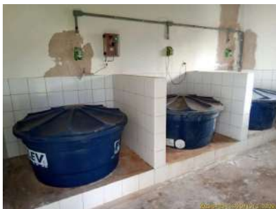
Foto 6 - Armazenamento e dosagem de produto químico
