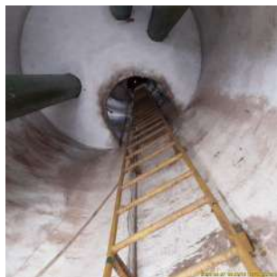
Foto 1 - Escada de acesso interna, sem guarda-corpos
