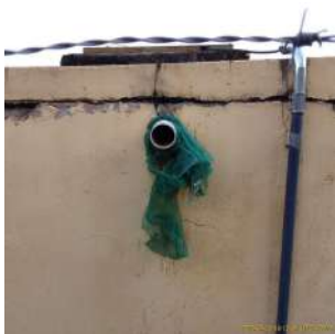
Foto 1 - Ausência de tela de proteção
