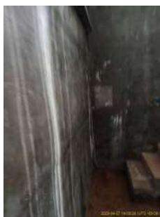
Foto 3 - Indícios de infiltrações na parede do reservatório (EEA Cruz. do Sul)
