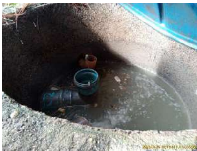
Foto 3 - Chegada do esgoto bruto
