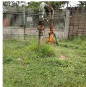
Foto 2 - Vista da área do poço e reservatórios Cruzeiro do Sul
