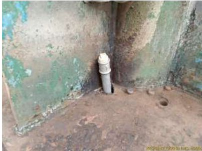
Foto 5 - Tubo de medição de nível
