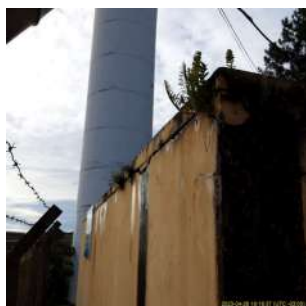
Foto 1 - Indícios de vazamentos na parede do reservatório apoiado Tutoya do Vale
