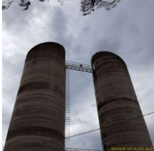
Foto 3 - Reservatórios Village Damha I (vasos comunicantes)
