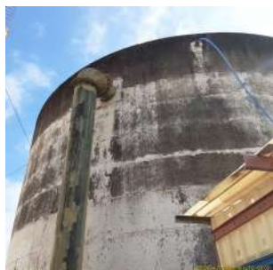
Foto 1 - Indícios de vazamentos no reservatório Vila Nery
