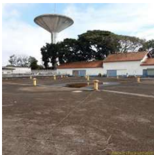
Foto 1 - Ausência de tela de proteção nas tubulações de ventilação
