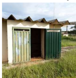
Foto 3 - Vista externa da estação elevatória de esgoto Eco Tecnológico Damha
