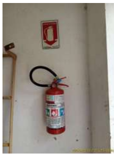
Foto 3 - Extintor de incêndio
