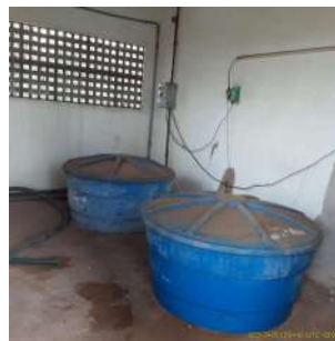
Foto 2 - Armazenamento e dosagem de cloro e flúor
