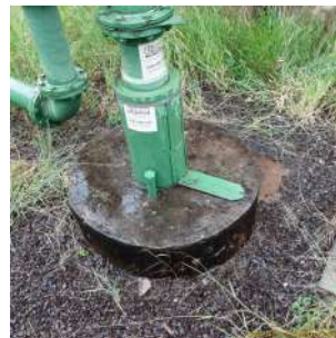
Foto 5 - Tubo de medição de nível
