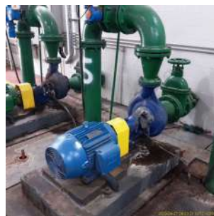
Foto 2 - Drenagem inadequada de água de lubrificação de gaxetas
