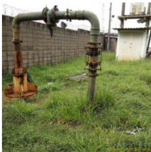
Foto 1 - Vista da área do poço e reservatórios Cruzeiro do Sul
