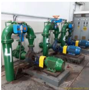
Foto 1 - Conjuntos motobomba 4,5 e 6 (Vila Alpes)
