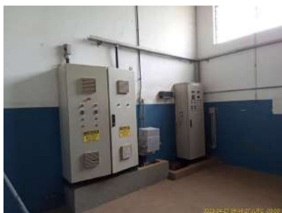
Foto 3 - Paineis de controle e acionamento dos conjuntos motobombas
