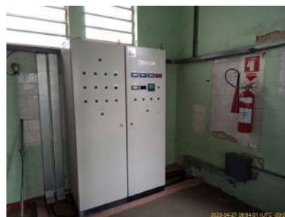
Foto 5 - Paineis II de controle e acionamento dos conjuntos motobomba
