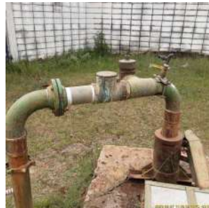
Foto 6 - Cavalete do poço Parque Fehr
