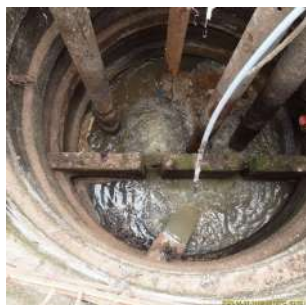
Foto 1 - Chegada do esgoto bruto
