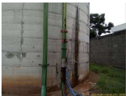
Foto 3 - Indícios de vazamentos no reservatório Village Damha III
