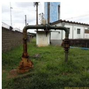
Foto 5 - Cavalete do Poço Cruzeiro do Sul
