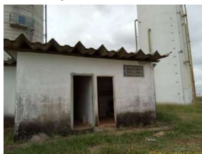
Foto 4 - Vista externa da estação elevatória de água Embaré
