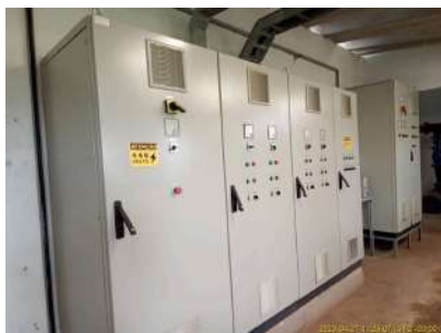
Foto 3 - Painel de controle e acionamento dos conjuntos motobombas
