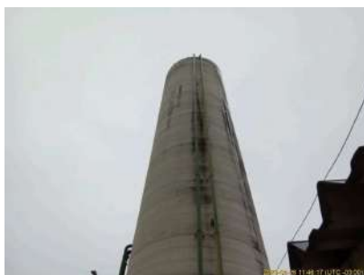
Foto 5 - Indícios de vazamentos no reservatório Village Damha III
