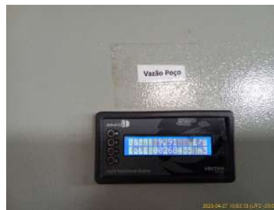
Foto 6 - Display do medidor de vazão do poço Jardim Embaré
