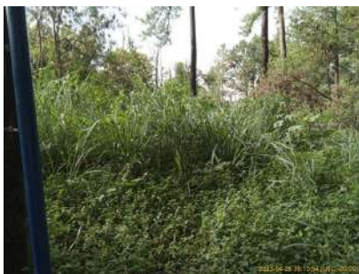
Foto 1 - Ausência de cercamento de área da estação elevatória de esgoto Samambaia
