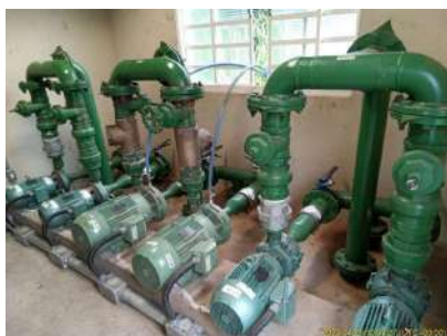
Foto 1 - Vista interna da estação elevatória Damha Capela
