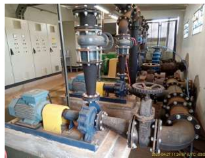
Foto 2 - Vista interna da estação elevatória Jardim do Bosque
