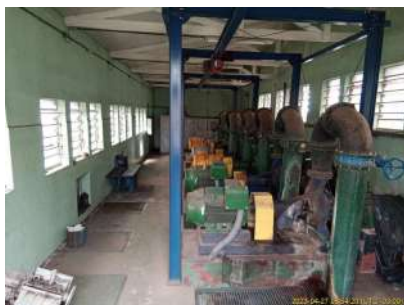
Foto 6 - Vista do interior da estação elevatória ETA C. Botelho Boa Vista e São Sebastião
