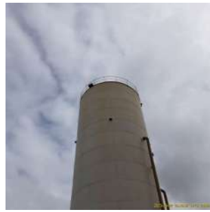
Foto 2 - Ausência de tela de proteção
