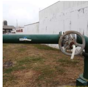
Foto 3 - Tomada para coleta de água do poço
