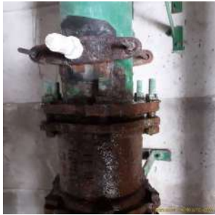
Foto 1 - Vazamento na junta da tubulação de recalque dentro do reservatório.
