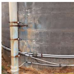
Foto 4 - Dosagem de cloro e flúor
