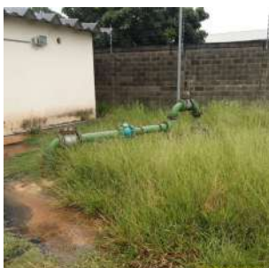
Foto 1 - Vista da área poço e reservatório Village Damha III
