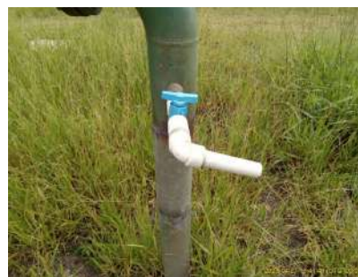
Foto 4 - Tomada para coleta de água do poço Jardim Embaré
