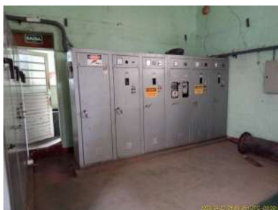
Foto 4 - Paineis I de controle e acionamento dos conjuntos motobomba
