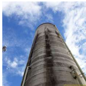
Foto 4 - Indícios de vazamentos no reservatório Eco Tecnológico Damha
