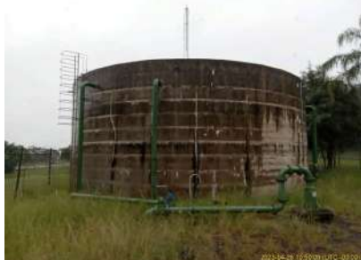
Foto 3 - Vista do reservatório e poço Damha Capela
