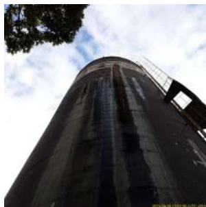
Foto 2 - Indícios de vazamentos aparentes no reservatório Samambaia
