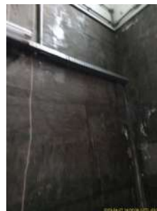
Foto 2 - Indícios de infiltrações na parede do reservatório (EEA Cruz. do Sul)
