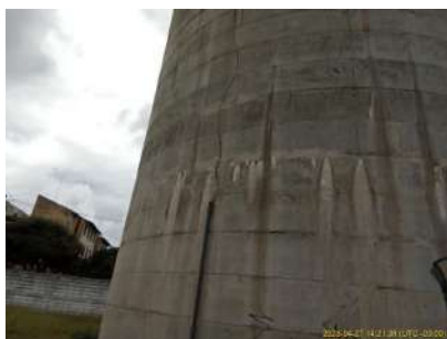
Foto 1 - Ausência de aterramento
