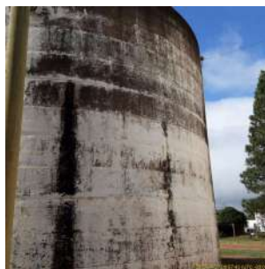
Foto 2 - Indícios de vazamentos no reservatório Vila Nery
