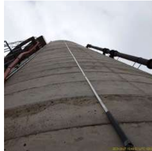
Foto 3 - Sistema de descida do aterramento do para-raio
