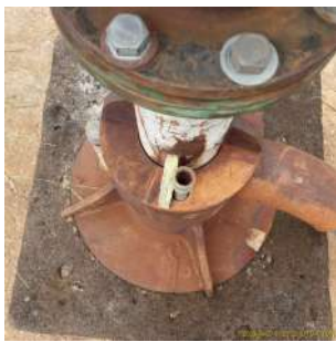
Foto 8 - Tubo de medição de nível
