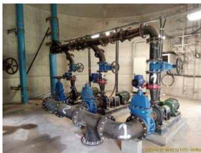
Foto 1 - Vista do interior da estação elevatória Vila Nery - elevado maior
