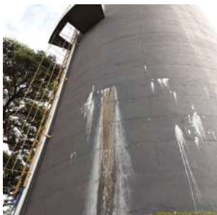
Foto 1 - Indícios de vazamentos aparentes no reservatório Samambaia
