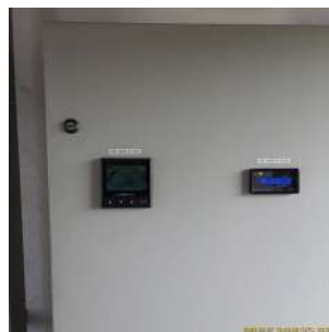
Foto 4 - Display do medidor de vazão do poço
