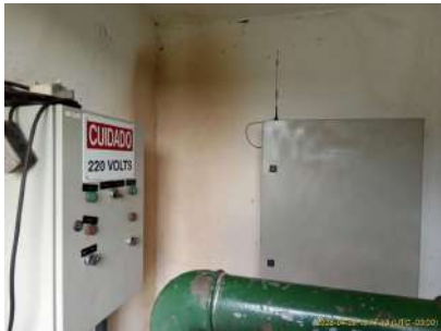
Foto 2 - Painel de comando e acionamento dos conjuntos motobombas
