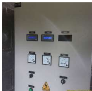
Foto 1 - Display do medidor de nível do reservatório Damha IV
