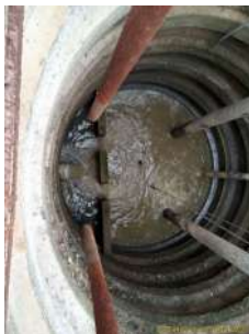
Foto 1 - Ausência de gradeamento na elevatória
