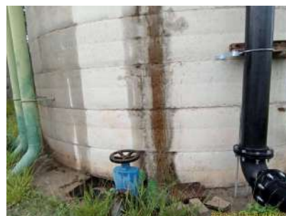
Foto 2 - Indícios de vazamentos no reservatório Village Damha III
