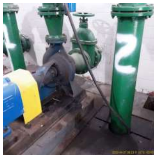
Foto 3 - Drenagem inadequada de água de lubrificação de gaxetas
