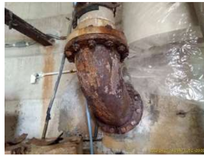
Foto 4 - Vazamentos aparentes na tubulação no interior do reservatório Cruzeiro do Sul
