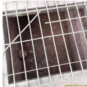
Foto 2 - Poço de sucção
