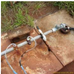
Foto 2 - Tomada para coleta de água do poço Tutoya do Vale
