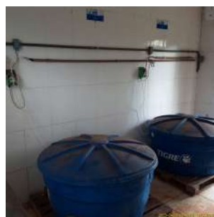
Foto 2 - Armazenamento e dosagem de cloro e flúor
