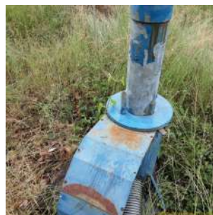
Foto 4 - Tubo de medição de nível
