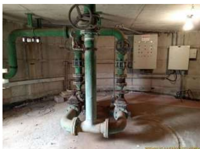
Foto 1 - Vista do interior da estação elevatória C.D.H.U
