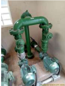
Foto 5 - Conjuntos motobombas (Damha IV)
