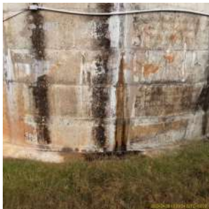
Foto 1 - Indícios de vazamentos no reservatório Eco Tecnológico Damha
