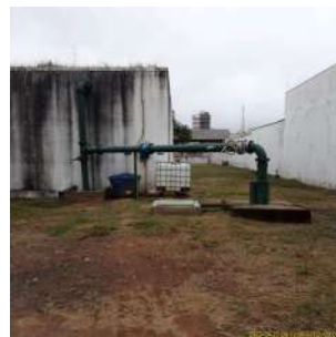
Foto 5 - Cavalete do Poço Rui Barbosa
