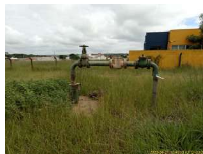
Foto 2 - Cavalete do poço Jardim Embaré
