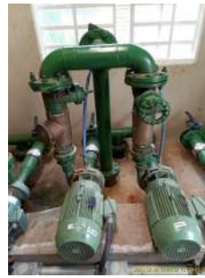
Foto 4 - Conjuntos motobombas (Village III)
