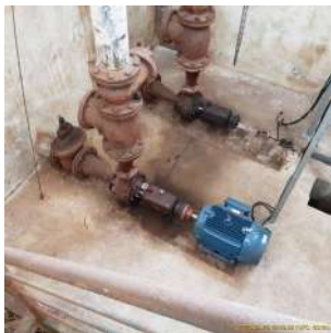
Foto 1 - Ausência de motobomba reserva
