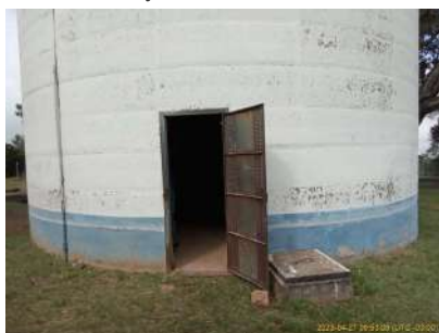
Foto 3 - Vista externa da estação elevatória Vila Nery - elevado maior
