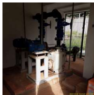
Foto 2 - Vista interna da estação elevatória Faixa Azul
