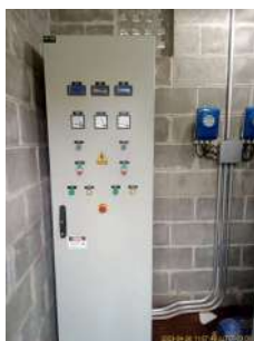
Foto 1 - Painel de comando e acionamento dos conjuntos motobombas
