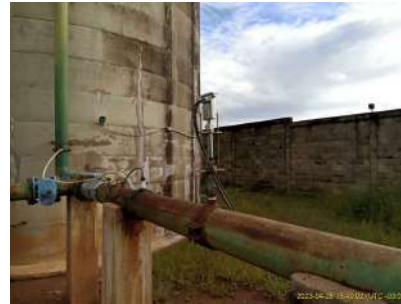
Foto 3 - Medidor de vazão do poço Eco Tecnológico Damha
