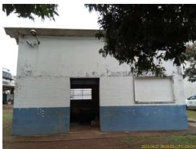
Foto 1 - Vista externa da estação elevatória Vila Alpes - Elevado Taça
