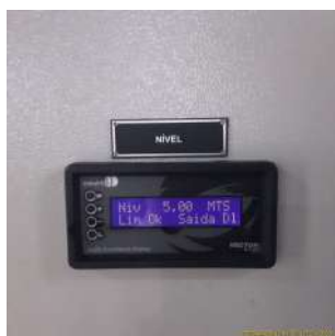
Foto 1 - Display do medidor de nível do reservatório Damha Golf Club
