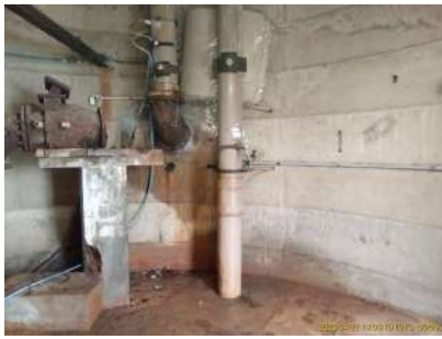
Foto 3 - Vazamentos aparentes na tubulação no interior do reservatório Cruzeiro do Sul
