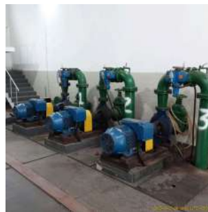
Foto 2 - Conjuntos motobombas 1,2 e 3 (Vila Nery)
