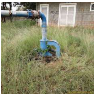
Foto 1 - Ausência de limpeza da área da laje de proteção do poço
