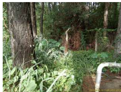
Foto 2 - Ausência de cercamento de área da estação elevatória de esgoto Samambaia
