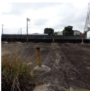
Foto 1 - Ausência de tela de proteção na tubulação de ventilação
