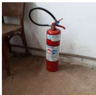
Foto 1 - Extintor de incêndio
