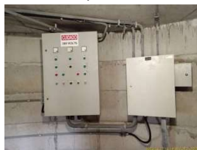
Foto 3 - Pannel de controle e acionamento dos conjuntos motobombas
