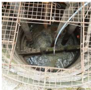
Foto 3 - Poço de sucção
