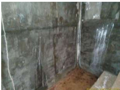
Foto 1 - Indícios de infiltrações na parede do reservatório (EEA Cruz. do Sul)
