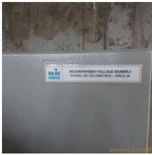
Foto 1 - Painel de telemetria
