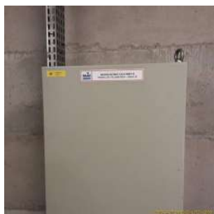
Foto 1 - Pannel de telemetria
