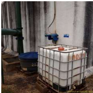
Foto 1 - Armazenamento e dosagem de cloro e flúor
