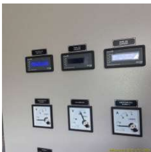
Foto 1 - Display do medidor de nível do reservatório Village Damha IV
