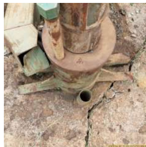
Foto 11 - Tubo de medição de nível
