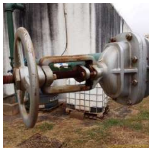
Foto 1 - Vazamento no registro
