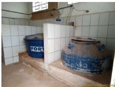
Foto 5 - Armazenamento e dosagem de cloro e flúor
