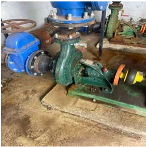
Foto 1 - Estação elevatória de água em Cordeirópolis.
