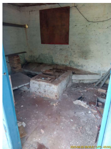
Foto 1 - Vazamento no Reservatório semi-enterrado da ETA em Cordeirópolis.
