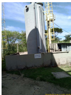
Foto 3 - Vista dos tanques de produtos químicos da ETE em Cordeirópolis.
