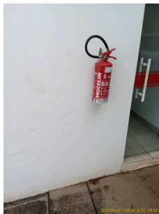
Foto 1 - Extintor de incêndio da ETE em Cordeirópolis.
