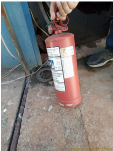
Foto 1 - Extintor de incêndio do Reservatório Jardim Cordeiro em Cordeirópolis.
