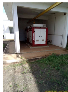
Foto 6 - ETE em Cordeirópolis.
