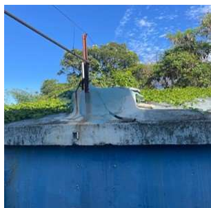
Foto 1 - Tampa de inspeção quebrada no Reservatório semi-enterrado da ETA em Cordeirópolis.
