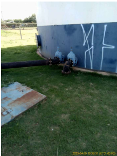
Foto 2 - Tubulação do Reservatório Jardim Paraty Apoiado em Cordeirópolis.
