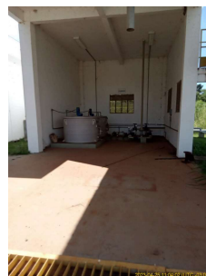
Foto 4 - Vista das dosadoras de produtos químicos da ETE em Cordeirópolis.
