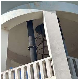
Foto 1 - Tampa de inspeção quebrada no Res. Elevado Centro de Distribuição de Água em Cordeirópolis.
