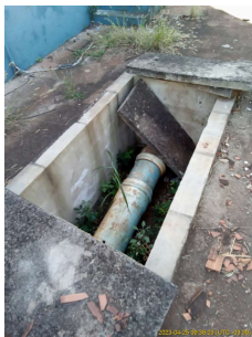
Foto 5 - Tubulação de entrada dos reservatórios semi-enterrados da ETA em Cordeirópolis.
