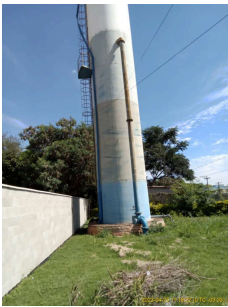
Foto 8 - Reservatório Jardim Cordeiro em Cordeirópolis.
