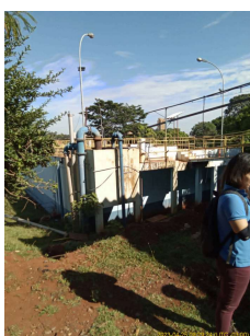
Foto 9 - Vista da ETA em Cordeirópolis.
