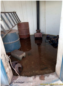
Foto 1 - Vazamento nas paredes do Reservatório Jardim Cordeiro em Cordeirópolis.
