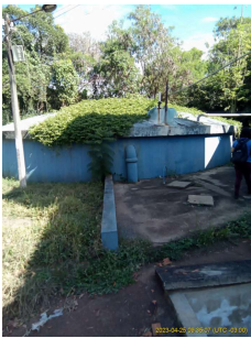
Foto 1 - Falta de limpeza no Reservatório semi-enterrado da ETA em Cordeirópolis.
