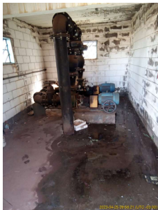
Foto 1 - EEAT Centro de Distribuição em Cordeirópolis.
