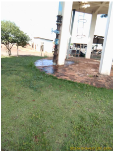
Foto 1 - Vazamento no Res. Elevado Centro de Distribuição de Água em Cordeirópolis.
