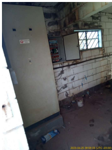
Foto 2 - EEAT Centro de Distribuição em Cordeirópolis.
