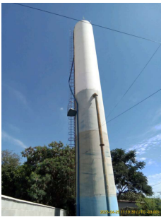
Foto 7 - Vista frontal do Reservatório Jardim Cordeiro em Cordeirópolis.
