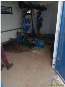
Foto 1 - Vazamento na Estação elevatória de água em Cordeirópolis.
