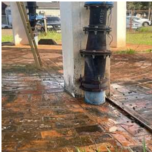
Foto 2 - Vazamento no Res. Elevado Centro de Distribuição de Água em Cordeirópolis.
