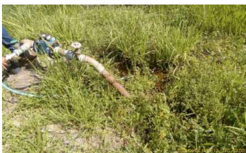
Foto 1 - Observou-se presença de água empossada no entorno das tubulação, indicando vazamento.
