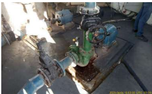
Foto 5 - Conj de bombas
