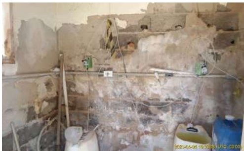
Foto 1 - Casa de dosagem - Ausência de manutenção
