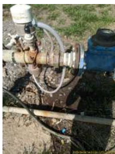
Foto 1 - Vazamento no cavalete
