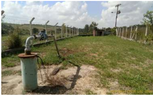
Foto 1 - Vista do cavalete
