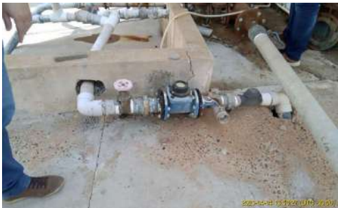
Foto 1 - Cavalete do poço
