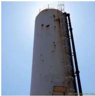
Foto 1 - Oxidações na estrutura do guarda-corpo
