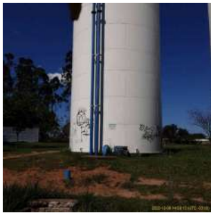
Foto 1 - Ausência de cercamento
