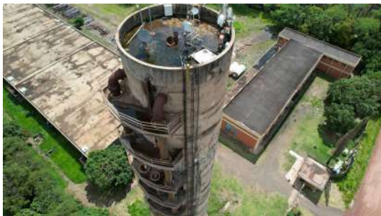
Foto 1 - Ausência de guarda-corpo na cobertura
