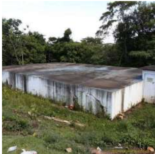
Foto 1 - Ausência de cercamento
