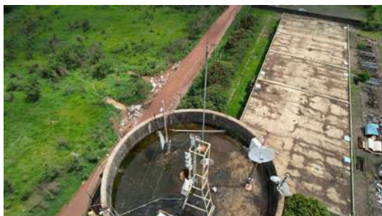
Foto 3 - Vista do pára-raio
