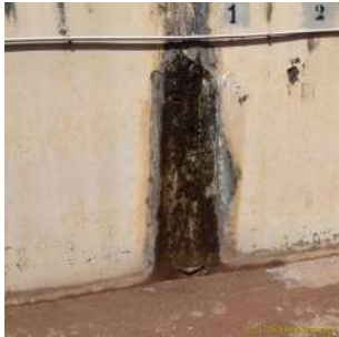
Foto 3 - Infiltração na parede da ETA
