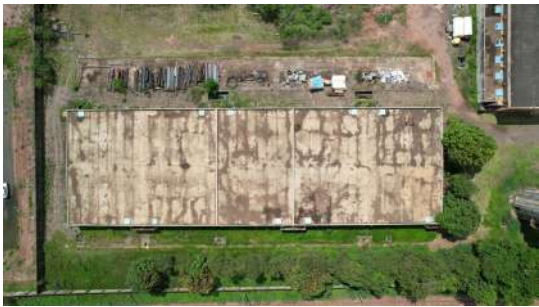
Foto 1 - Ausência de guarda-corpo e escada de acesso
