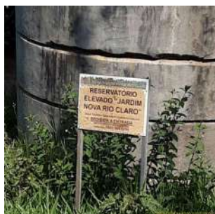
Foto 1 - Placa de identificação do reservatório
