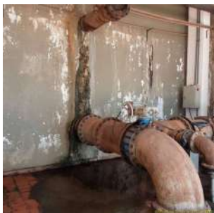
Foto 1 - Infiltração na parede da ETA, próximo ao barrilete
