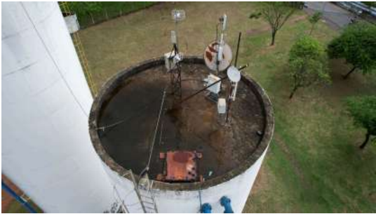
Foto 1 - Reservatório com pára-raios caído
