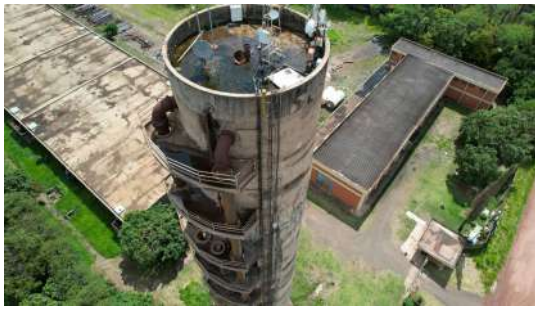
Foto 1 - Presença de infiltrações por todo reservatório
