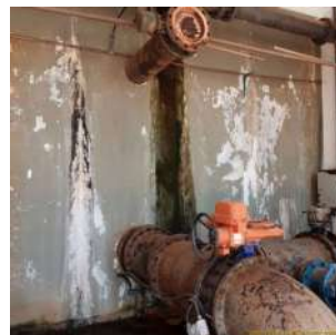
Foto 2 - Infiltração na parede da ETA, próximo ao barrilete
