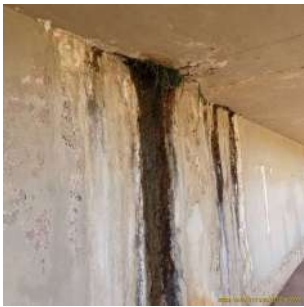
Foto 4 - Infiltração na parede da ETA
