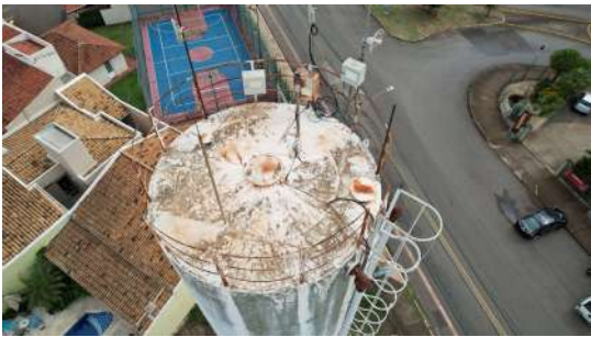
Foto 1 - Pára-raio do reservatório
