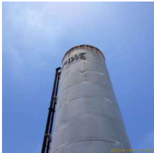
Foto 1 - Reservatório sem pára-raios
