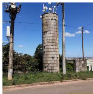
Foto 2 - Ausência de cercamento
