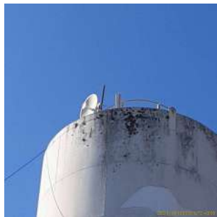
Foto 1 - Pára-raio aparentemente danificado
