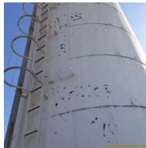
Foto 2 - Ausência de aterramento do pára-raio
