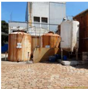
Foto 1 - Tanques de produtos químicos sem contenção
