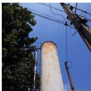
Foto 1 - Ausência de pára-raios
