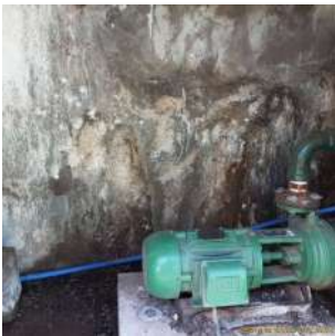
Foto 1 - Vestígios de infiltrações na parede da elevatória
