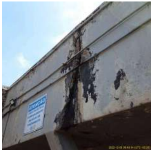
Foto 1 - Infiltração na parede da ETA
