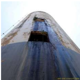
Foto 1 - Infiltração na parede do reservatório
