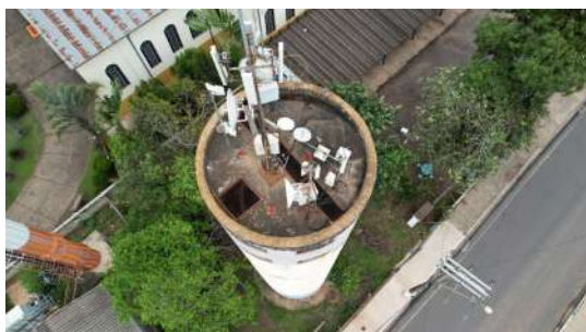
Foto 1 - Vista do topo do reservatório sem guarda corpo
