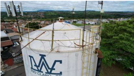
Foto 1 - Tubo de ventilação sem tela
