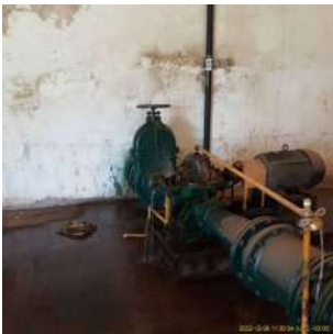
Foto 1 - Drenagem inadequada de água de lubrificação de gaxetas
