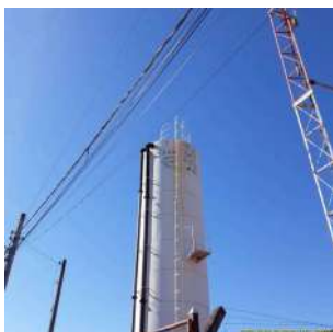
Foto 1 - Reservatório sem pára-raios
