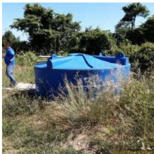
Foto 1 - Ausência de identificação do reservatório
