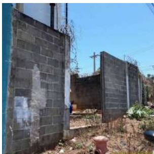
Foto 1 - Ausência de portão no cercamento
