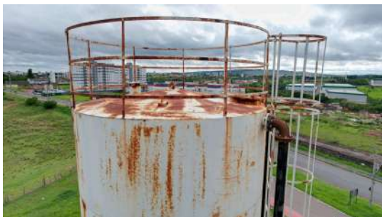
Foto 1 - Reservatório sem pára-raios
