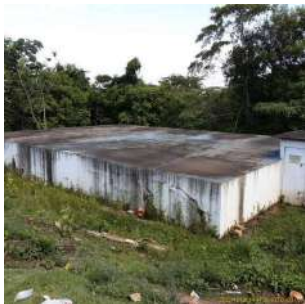
Foto 1 - Rachaduras e infiltrações na parede do reservatório
