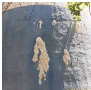
Foto 1 - Vista de fissura com possível vazamento e colmatção
