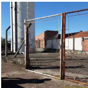
Foto 1 - Abertura no cercamento
