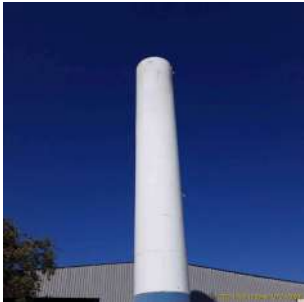
Foto 2 - Ausência de guarda-corpo na cobertura
