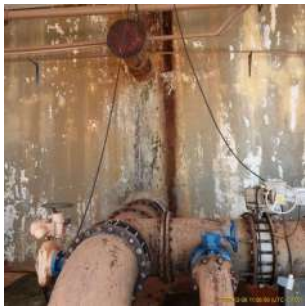
Foto 3 - Infiltração na parede da ETA, próximo ao barrilete
