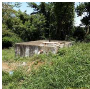
Foto 1 - Reservatório sem cercamento
