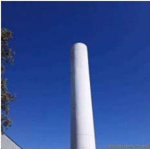
Foto 1 - Ausência de escada de acesso com guarda corpo
