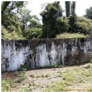
Foto 1 - Presença de diversas infiltrações em todo reservatório
