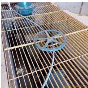
Foto 2 - Vazamento em válvula do barrilete
