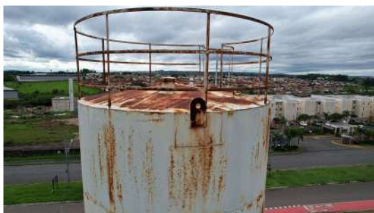
Foto 1 - Tubulação de ventilação sem tela
