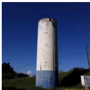
Foto 1 - Reservatório sem cercamento
