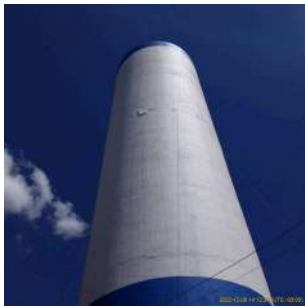
Foto 1 - Ausência de guarda-corpo na cobertura
