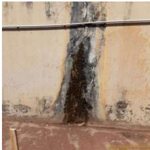
Foto 2 - Infiltração na parede da ETA
