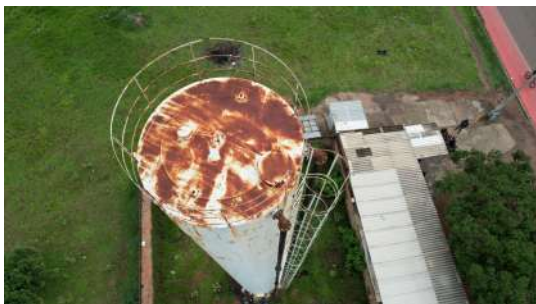
Foto 1 - Vista geral da corrosão na cobertura do reservatório
