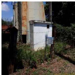
Foto 1 - Ausência de cercamento
