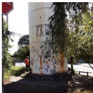
Foto 1 - Reservatório sem cercamento
