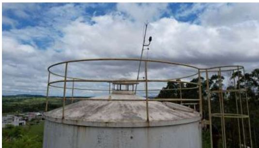
Foto 1 - Ausência de tela na tubulação de ventilação
