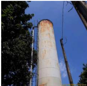
Foto 1 - Aspecto oxidado do reservatório
