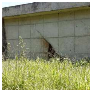
Foto 2 - Vazamento na lateral do reservatório
