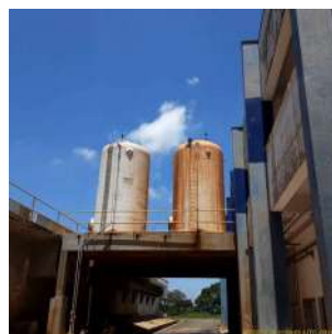
Foto 2 - Tanque de produto químico sem bacia de contenção
