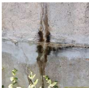
Foto 1 - Vazamento na lateral do reservatório
