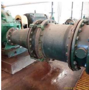
Foto 1 - Vazamento proveniente da tubulação
