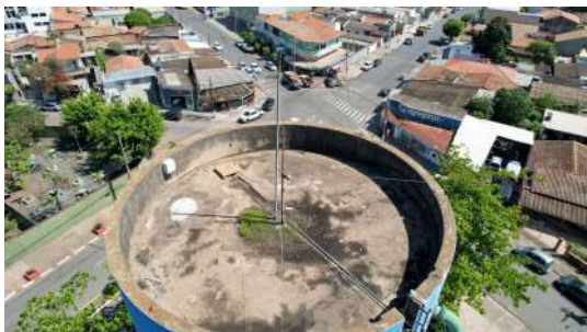
Foto 1 - Abertura na parte inferior da tampa de inspeção
