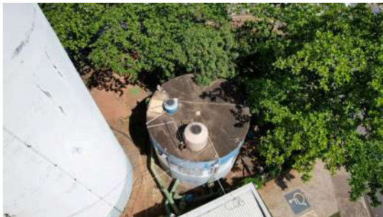
Foto 1 - Tubulação de Ventilação sem Tela
