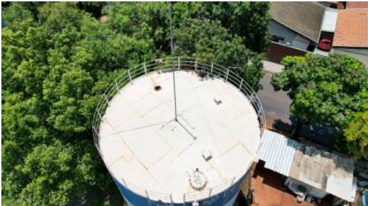
Foto 1 - Tubo de ventilação danificado por corrosão.
