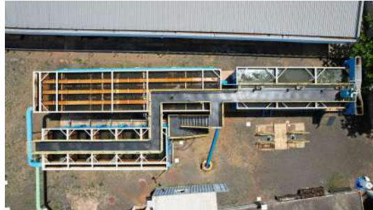
Foto 8 - Vista Geral da ETA Compacta
