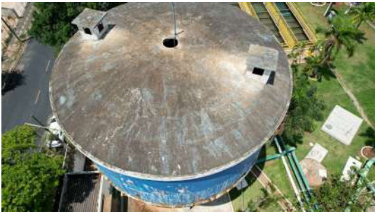
Foto 1 - Ausência de tampa de inspeção no reservatório elevado
