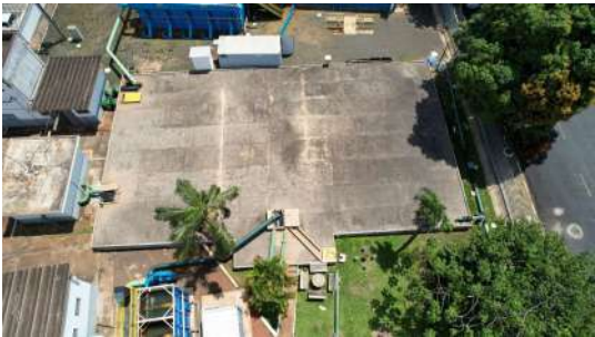
Foto 2 - Tampa de inspeção aberta no reservatório semienterrado retangular
