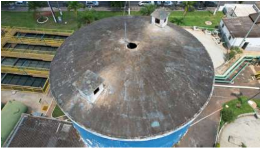
Foto 1 - Ausência de telas de proteção nas aberturas do reservatório elevado.
