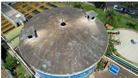
Foto 1 - Ausência de guarda-corpo na parte superior do reservatório elevado
