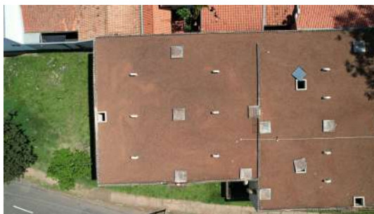
Foto 2 - Sem tampa de inspeção e tampa de inspeção aberta
