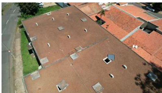
Foto 2 - Tubulações e ventilação
