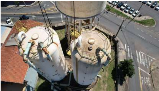
Foto 1 - Vista das Tubulações de Ventilação sem Telas
