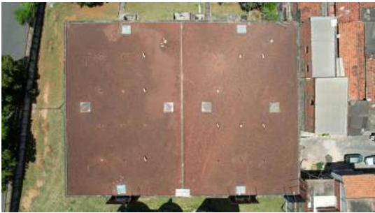
Foto 1 - Aberturas na cobertura do reservatório
