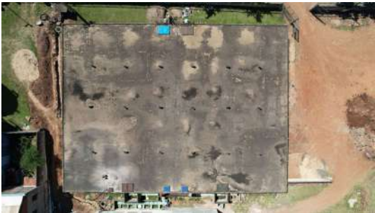
Foto 1 - Vista das tubulações de ventilação
