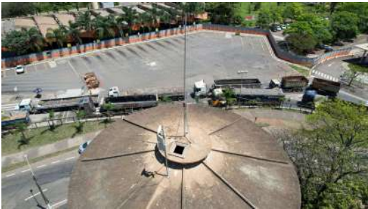
Foto 2 - Ausência de tampa de inspeção do Reservatório Elevado Vila Rezende
