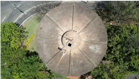
Foto 1 - Ausência de tampa de inspeção do Reservatório Elevado Vila Rezende
