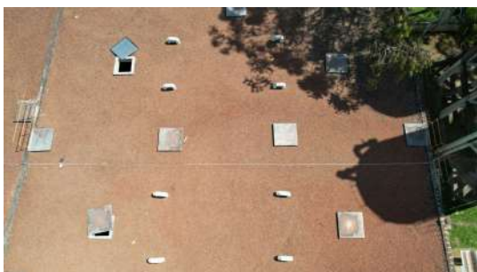
Foto 1 - Tubulações de ventilação
