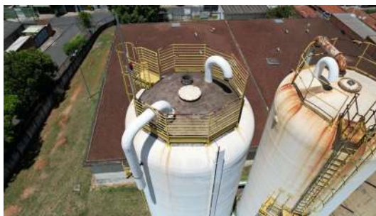
Foto 2 - Tubulação de ventilação sem tela (ambos reservatórios)
