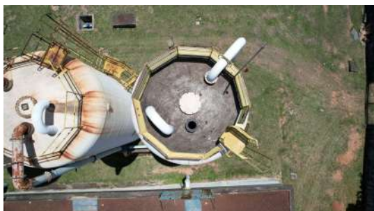
Foto 1 - Tubulação de ventilação sem tela (direita da foto)
