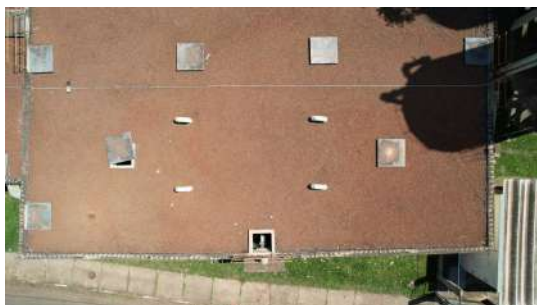
Foto 1 - Tampa de inspeção aberta
