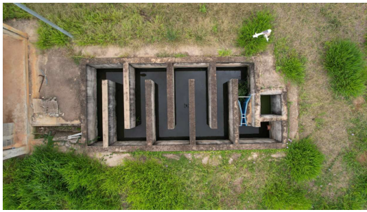
Foto 7 - Tanque de contato
