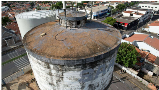
Foto 1 - Ventilação sem tela
