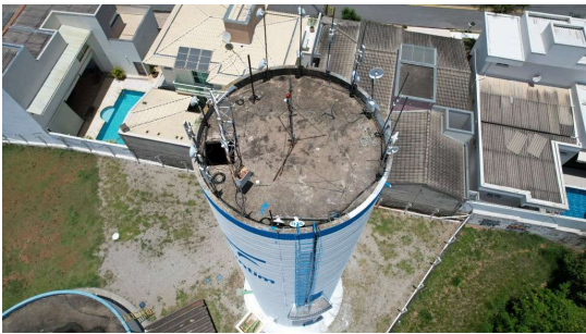
Foto 1 - Não foi verificado para-raios e aterramento. no reservatório elevado.
