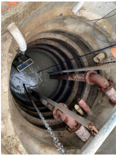
Foto 2 - Poço de sucção da elevatória.
