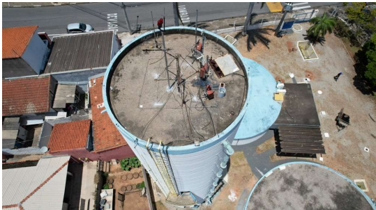
Foto 1 - Para-raios no reservatório elevado.
