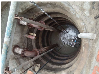
Foto 1 - Poço de sucção.
