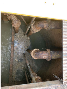
Foto 2 - Poço de sucção da elevatória
