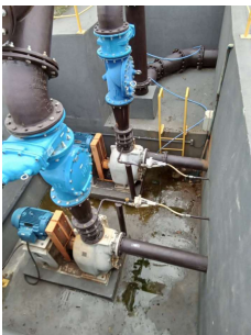
Foto 1 - Bombas de sucção da elevatória.
