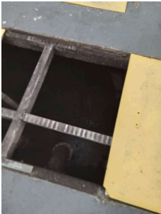
Foto 1 - Poço de limpeza com cesto peneira.
