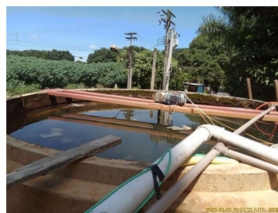
Foto 6 - Vista de outro tanque em operação.
