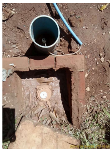
Foto 1 - Macromedidor na entrada da ETA.
