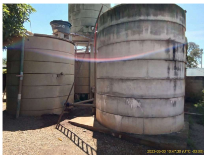
Foto 1 - Vista dos tanques de tratamento.
