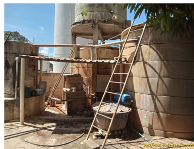
Foto 2 - Vista dos tanques de tratamento.
