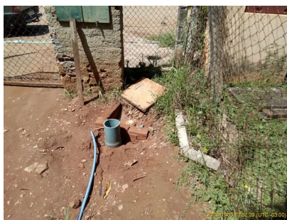
Foto 9 - Entrada da água bruta com macromedidor.
