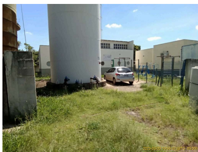
Foto 1 - Reservatório sem cerca no entorno.
