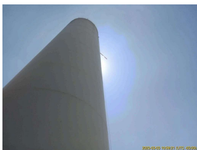
Foto 1 - Tubo extravasor avançando para fora do topo do reservatório.
