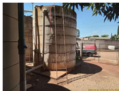
Foto 2 - Ausência de escada adequada e guarda-corpos.
