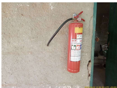
Foto 1 - Extintor da ETA Rincão.
