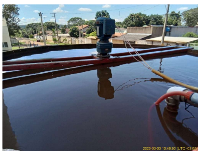
Foto 5 - Vista de um dos tanques em operação.
