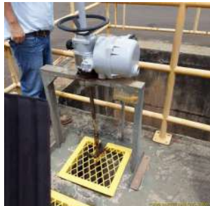
Foto 17 - EEE na ETE Anselmo em Leme
