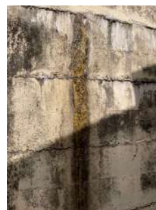
Foto 2 - Vazamento no Reservatório Apoiado Santa Maria em Leme
