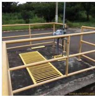
Foto 15 - EEE na ETE Anselmo em Leme
