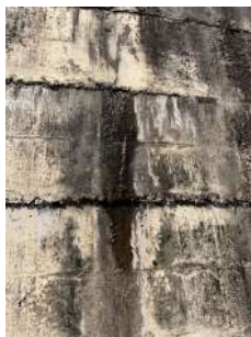
Foto 3 - Vazamento no Reservatório Apoiado Santa Maria em Leme
