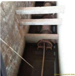
Foto 2 - EEE na ETE Anselmo em Leme
