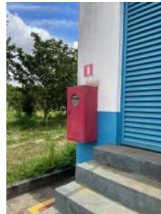
Foto 18 - EEE na ETE Anselmo em Leme
