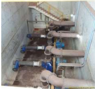
Foto 7 - EEE na ETE Anselmo em Leme
