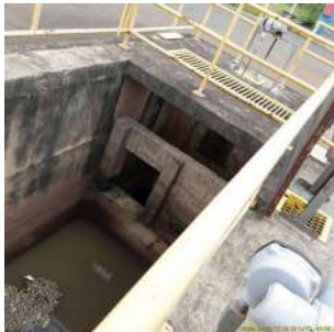
Foto 11 - EEE na ETE Anselmo em Leme
