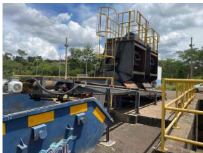
Foto 19 - EEE na ETE Anselmo em Leme
