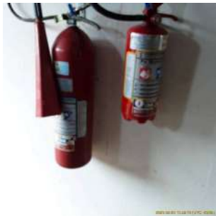
Foto 3 - EEE na ETE Anselmo em Leme
