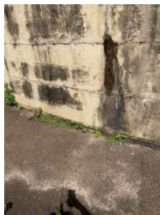
Foto 4 - Vazamento no Reservatório Apoiado Santa Maria em Leme
