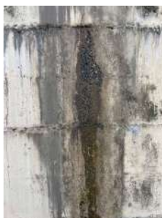
Foto 1 - Vazamento no Reservatório Apoiado Santa Maria em Leme
