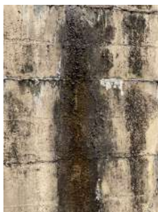
Foto 5 - Vazamento no Reservatório Apoiado Santa Maria em Leme
