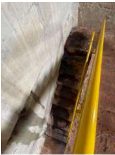
Foto 1 - Infiltração na parede na EEE da ETE Anselmo em Leme
