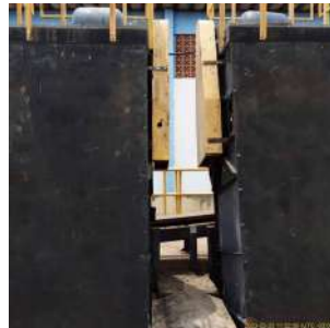
Foto 14 - EEE na ETE Anselmo em Leme
