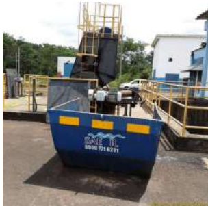
Foto 13 - EEE na ETE Anselmo em Leme
