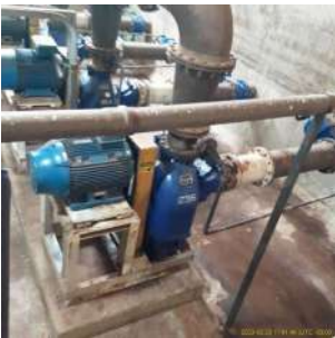
Foto 4 - EEE na ETE Anselmo em Leme
