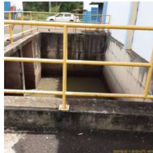
Foto 12 - EEE na ETE Anselmo em Leme
