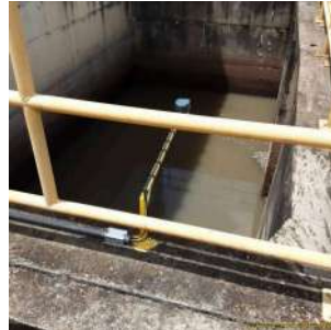
Foto 8 - EEE na ETE Anselmo em Leme
