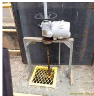
Foto 16 - EEE na ETE Anselmo em Leme
