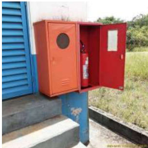
Foto 9 - EEE na ETE Anselmo em Leme
