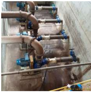
Foto 5 - EEE na ETE Anselmo em Leme
