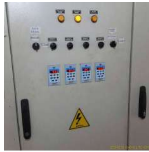
Foto 6 - EEE na ETE Anselmo em Leme
