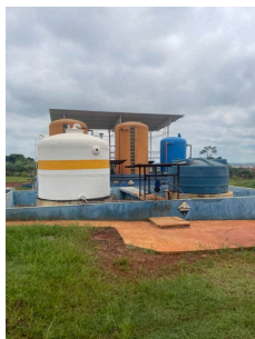
Foto 1 - Produtos químicos utilizados na ETA 4 em Santa Bárbara DOeste
