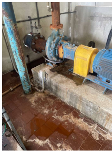
Foto 1 - Vazamento na drenagem no Reservatório Amélia semi enterrado circular em Santa Bárbara DOeste
