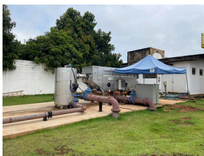
Foto 3 - Tratamento de lodo na ETA 2 em Santa Bárbara DOeste
