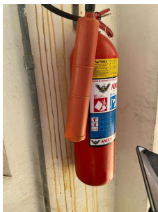
Foto 1 - Extintor de incêndio na ETA 2 em Santa Bárbara DOeste
