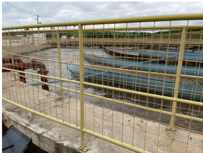
Foto 5 - ETE Barrocão em Santa Bárbara DOeste
