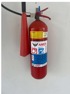
Foto 1 - Extintor de incêndio na ETA 4 em Santa Bárbara DOeste
