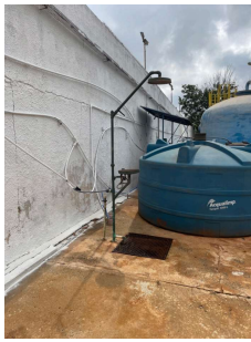
Foto 1 - Chuveiro de emergência na ETA 2 em Santa Bárbara DOeste
