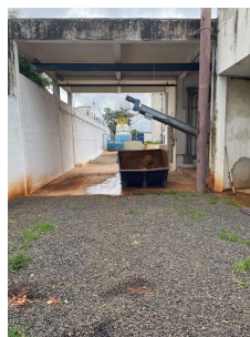
Foto 2 - Tratamento de lodo na ETA 2 em Santa Bárbara DOeste
