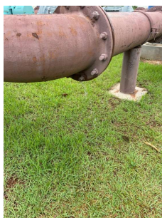
Foto 1 - Vazamento na flange da tubulação na ETA 2 em Santa Bárbara DOeste
