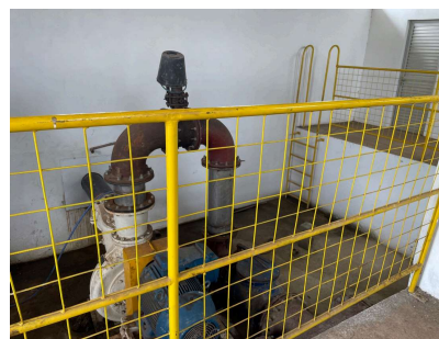
Foto 2 - Estação Elevatória na ETE Barrocão em Santa Bárbara DOeste
