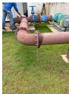
Foto 2 - Vazamento na flange da tubulação na ETA 2 em Santa Bárbara DOeste
