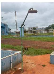
Foto 1 - Chuveiro de emergência na ETA 4 em Santa Bárbara DOeste
