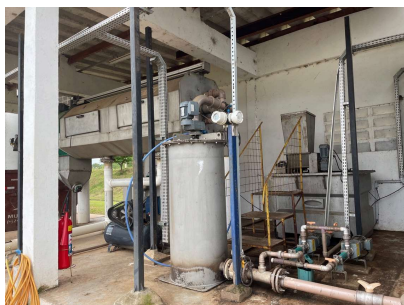
Foto 1 - Estação Elevatória na ETE Barrocão em Santa Bárbara DOeste
