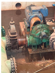
Foto 1 - Vazamento na ETA 4 em Santa Bárbara DOeste
