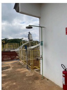
Foto 1 - Chuveiro de emergência na Estação Elevatória na ETE Barrocão em Santa Bárbara DOeste
