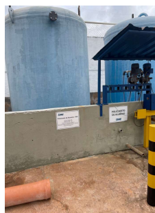
Foto 2 - Produtos químicos utilizados na ETA 2 em Santa Bárbara DOeste
