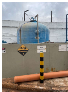
Foto 4 - Produtos químicos utilizados na ETA 2 em Santa Bárbara DOeste
