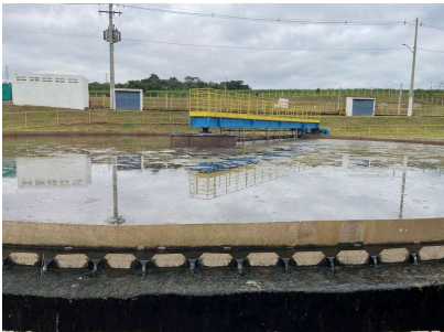
Foto 1 - ETE Barroção em Santa Bárbara DOeste
