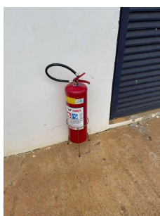
Foto 1 - Extintor de incêndio na Estação Elevatória na ETE Barrocão em Santa Bárbara DOeste
