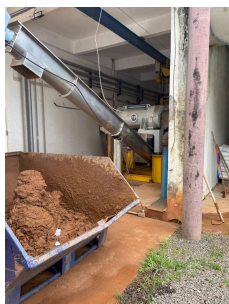
Foto 1 - Tratamento de lodo na ETA 2 em Santa Bárbara DOeste
