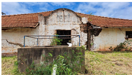
Foto 1 - Detalhe frontal da situação estrutural do Reservatório Filipão Velho
