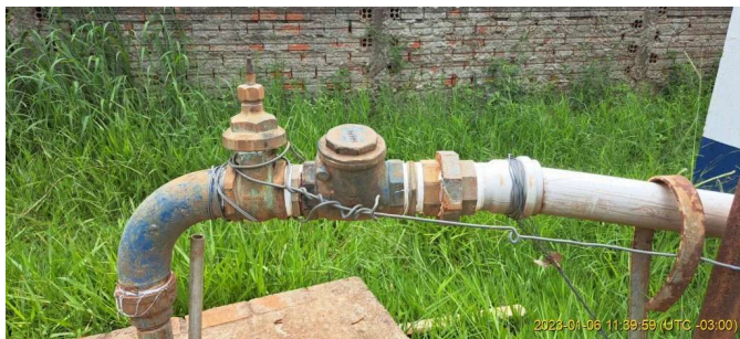
Foto 1 - Ausência de macromedidor - Poço CDHU
