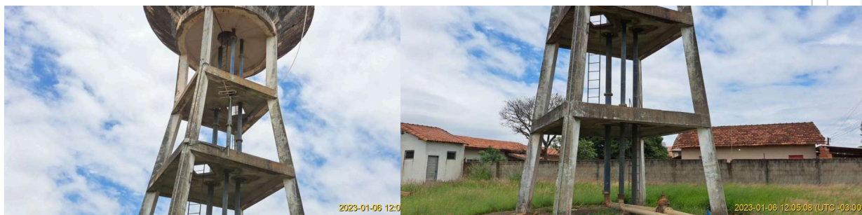
Foto 1 - Ausência de guarda-corpos em escada - Reservatório Jd. Paulista
