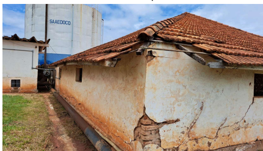
Foto 4 - Detalhe da situação estrutural do Reservatório Filipão Velho
