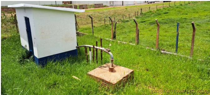
Foto 1 - Vista geral do Poço CDHU
