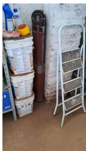
Foto 1 - Bomba reserva - Poço CDHU
