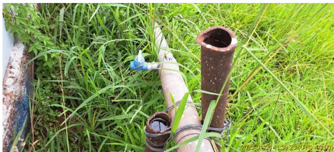
Foto 1 - Torneira na tubulação para coleta de água bruta - Poço CDHU
