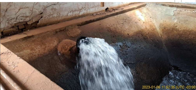
Foto 4 - Chegada de água da ETA - Reservatório Filipão Velho
