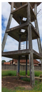
Foto 3 - Ausência de guarda-corpos em escada - Reservatório Jd. Paulista
