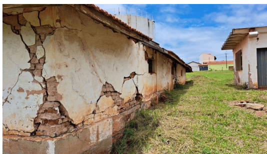
Foto 2 - Detalhe da situação estrutural do Reservatório Filipão Velho
