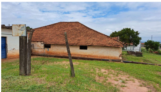
Foto 1 - Ausência de cerca na área - Reservatório Filipão Velho
