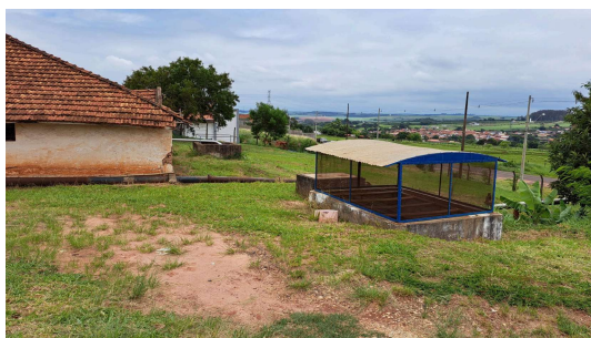
Foto 6 - Sistema de filtros para água captada da Lagoa Filipão - Reservatório Filipão Velho
