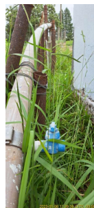
Foto 2 - Torneira na tubulação para coleta de água bruta - Poço CDHU
