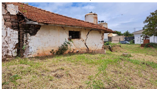
Foto 3 - Detalhe da situação estrutural do Reservatório Filipão Velho
