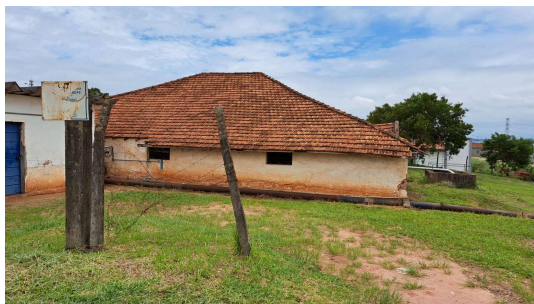
Foto 2 - Ausência de cercamento nas áreas dos Reservatórios Filipão Velho e Novo
