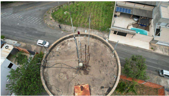
Foto 1 - Detalhe da ausência de guarda-corpo
