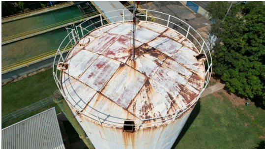
Foto 1 - oxidação e aberturas na tampa
