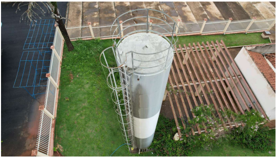
Foto 4 - Reservatório Apoiado Cemitério lateral e extravasamento
