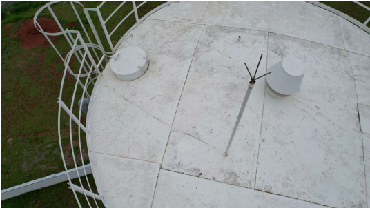
Foto 1 - Para-raios sem descida de aterramento
