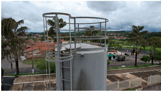
Foto 3 - Reservatório Apoiado Cemitério com extravasamento
