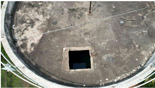
Foto 1 - Ausência de tampa
