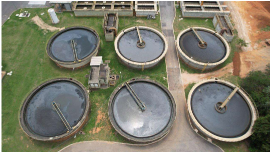
Foto 3 - Vista dos decantadores
