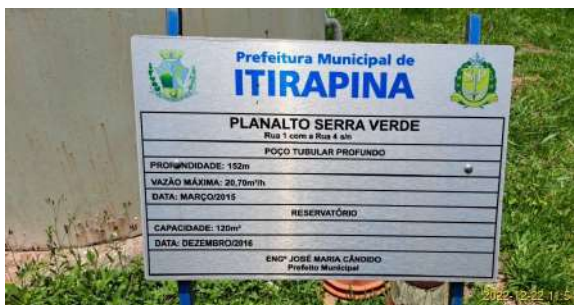
Foto 3 - Placa de identificação do poço e reservatório Planalto Serra Verde
