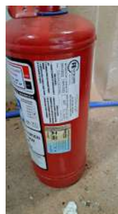
Foto 5 - Validade do extintor de incêndio no interior da base do Reservatório Elevado Ubá 1
