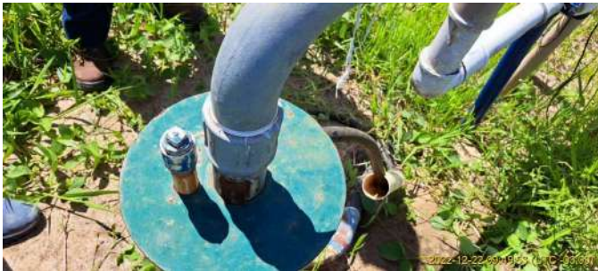
Foto 1 - Tubo de medição de nível - Poço Itaqueri da Serra (Novo)
