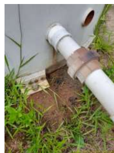
Foto 2 - Vazamento na tubulação de saída - Reservatório Ubá 2
