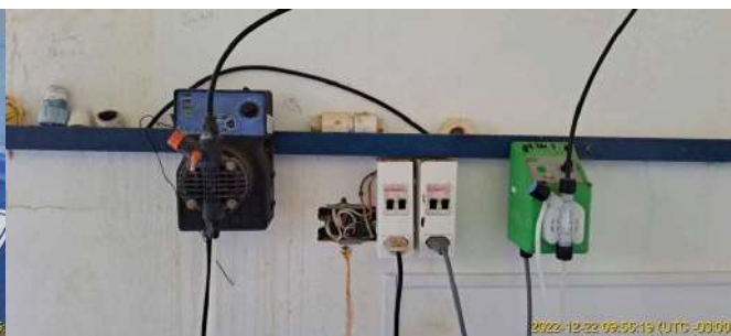
Foto 2 - Bombas dosadoras de cloro e flúor - Poço Itaqueri da Serra (Novo)
