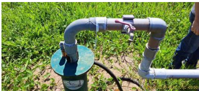
Foto 3 - Tomada de água - Poço Itaqueri da Serra (Novo)
