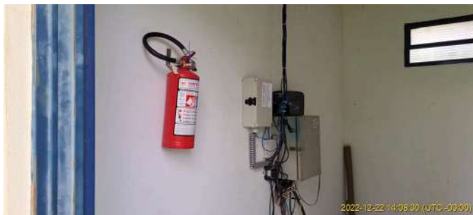
Foto 1 - Extintor de incêndio instalado dentro do abrigo.
