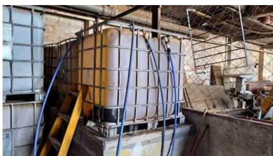
Foto 1 - Estoque inadequado de flúor - DAE Itirapina
