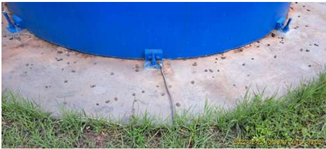
Foto 1 - Detalhe do aterramento do fio condutor - Reservatório elevado Broa
