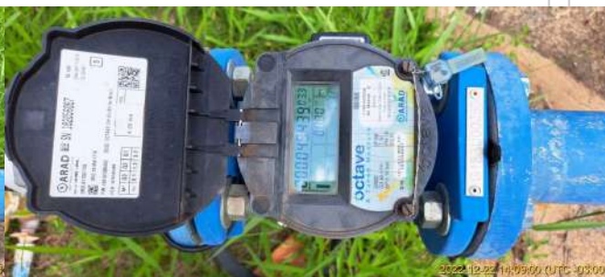
Foto 2 - Macromedidor - Poço Ubá 2
