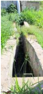
Foto 1 - Calha Parshall para medição da vazão de saída da ETE
