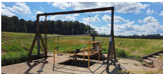
Foto 1 - Pórtico com talha para manutenção das bombas submersas - ETE Itirapina
