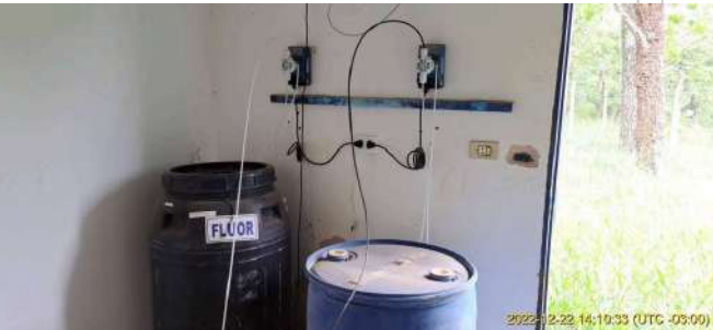
Foto 2 - Bombonas com cloro e flúor e bombas dosadoras - Poço Ubá 2
