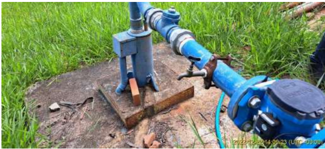
Foto 1 - Torneira para tomada de água bruta - Poço Ubá 2
