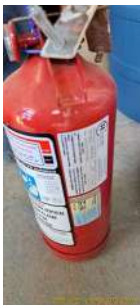
Foto 1 - Extintor de incêndio - Poço Itaqueri da Serra (Novo)
