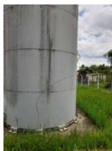
Foto 2 - Ausência de aterramento da estrutura metálica do reservatório e do fio condutor de descida - Reservatório Ubá 2
