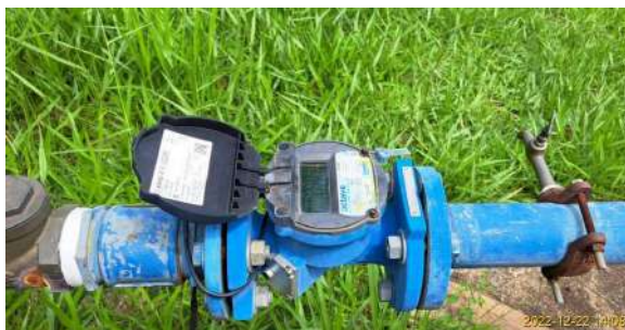
Foto 1 - Macromedidor - Poço Ubá 2
