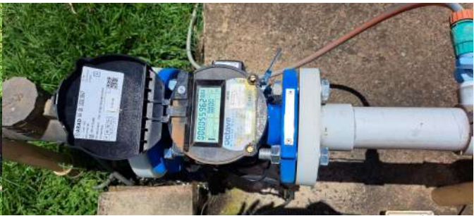
Foto 2 - Macromedidor - Poço Planalto Serra Verde
