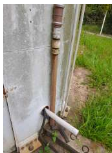
Foto 4 - Vazamento na tubulação de chegada de água - Reservatório Ubá 2
