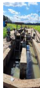
Foto 6 - Tratamento preliminar - Gradeamento - ETE Itirapina
