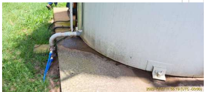
Foto 6 - Aplicação de cloro e flúor na tubulação de entrada do Reservatório
