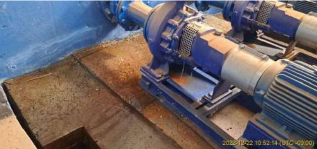
Foto 2 - Piso molhado devido a falta de drenagem da água de lubrificação das gaxetas - EEA Broa
