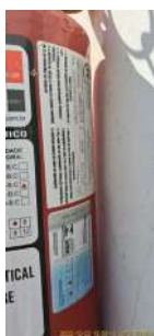
Foto 1 - Validade do extintor de incêndio - ETE Itirapina
