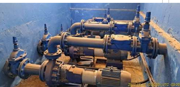
Foto 2 - Conjuntos motobomba da EEA Broa
