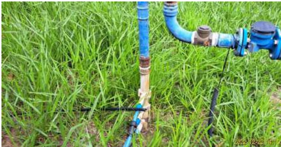
Foto 1 - Local de aplicação de cloro e flúor na tubulação - Poço Ubá 2
