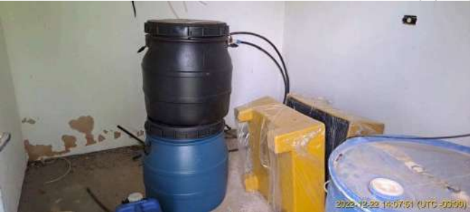
Foto 7 - Vista interna do abrigo de produtos químicos e bombas dosadoras
