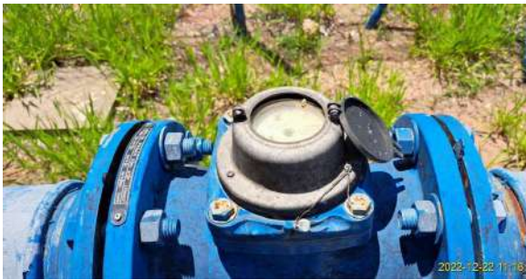
Foto 1 - Macromedidor - Poço Broa - Rua 4
