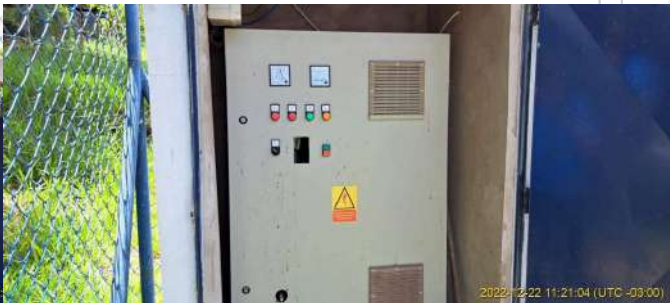
Foto 2 - Vista do painel de controle do Poço Broa - Rua 4
