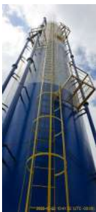
Foto 1 - Guarda-corpos em escada - Reservatório elevado Broa
