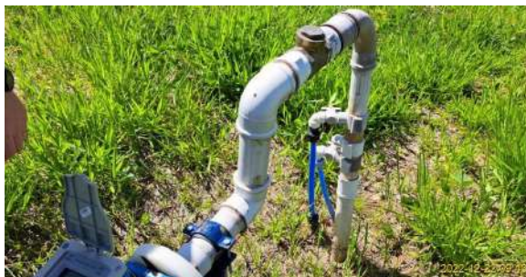
Foto 5 - Dosagem de cloro e flúor - Poço Itaqueri da Serra (Novo)
