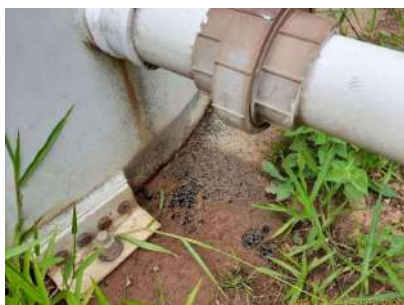
Foto 1 - Vazamento na tubulação de saída - Reservatório Ubá 2
