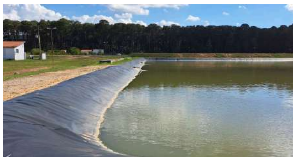
Foto 13 - Vista da segunda lagoa (facultativa) - ETE Itirapina
