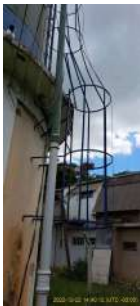
Foto 2 - Guarda-corpos em escada - Reservatório Elevado Ubá 1
