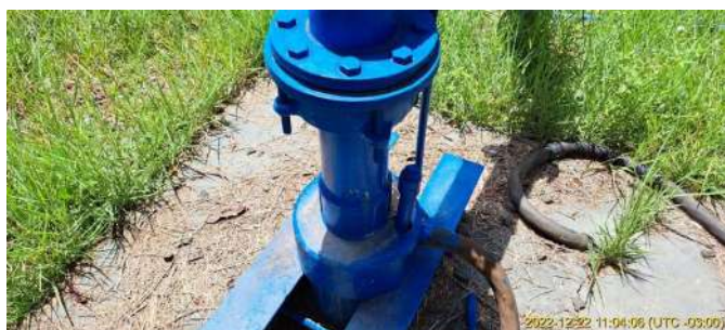
Foto 1 - Tubo de medição de nível - Poço Broa
