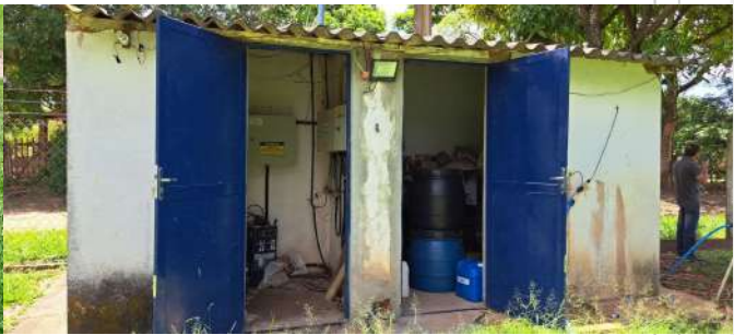
Foto 2 - Abrigo das bombonas de cloro e flúor e das bombas dosadoras
