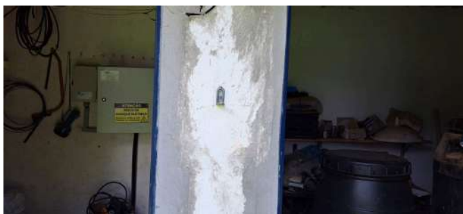
Foto 1 - Local onde fica instalado o extintor de incêndio, ausente no momento da fiscalização - Poço Planalto Serra Verde
