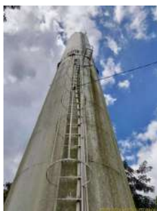
Foto 1 - Guarda-corpos em escada vertical - Reservatório Ubá 2
