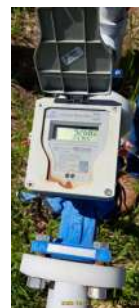
Foto 4 - Macromedidor - Poço Itaqueri da Serra (Novo)
