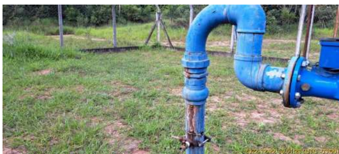
Foto 1 - Torneira para tomada de água bruta - Poço Ubá 1
