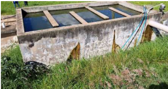
Foto 1 - Tanque com vazamentos aparentes - ETE Itirapina
