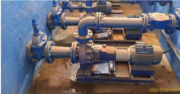
Foto 1 - Piso molhado devido a falta de drenagem da água de lubrificação das gaxetas - EEA Broa
