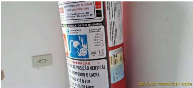
Foto 1 - Detalhe da data de validade do extintor de incêndio - Poço Ubá 2
