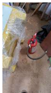
Foto 4 - Extintor de incêndio disposto de maneira inadequada no piso no interior da base do Reservatório Elevado Ubá 1
