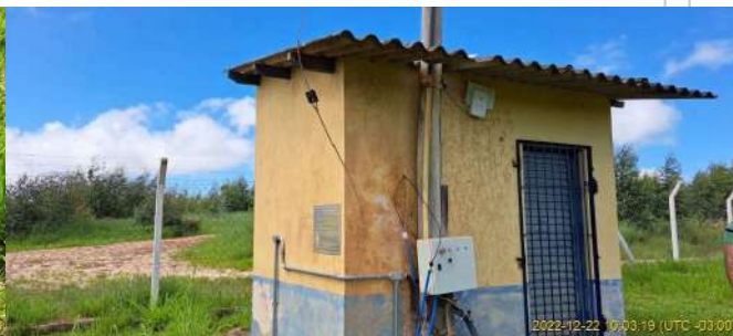
Foto 6 - Abrigo de painéis eletrônicos e produtos químicos - Poço Itaqueri da Serra (Novo)
