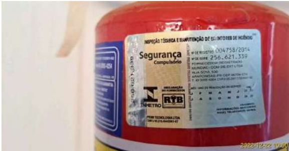
Foto 1 - Detalhe da data de validade do extintor de incêndio - EEA Broa
