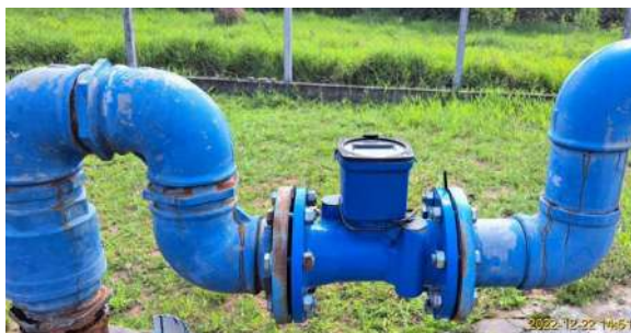
Foto 1 - Macromedidor - Poço Ubá 1
