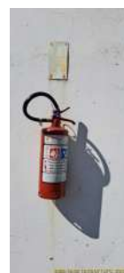
Foto 2 - Extintor de incêndio - ETE Itirapina
