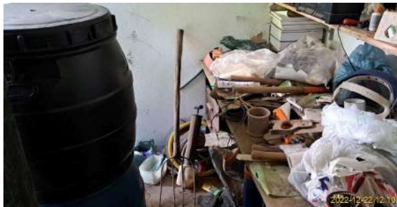
Foto 1 - Vista do interior do abrigo de químicos e bombas dosadoras - Poço Planalto Serra Verde
