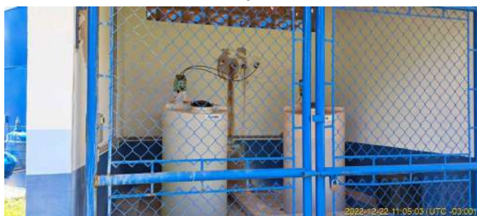
Foto 3 - Tanques e bombas dosadoras de cloro e flúor - Sistema de Reservaão Broa
