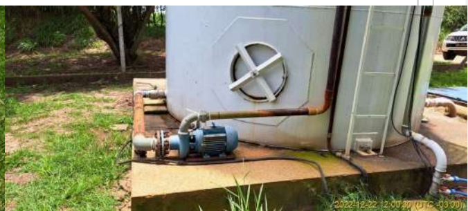
Foto 4 - Conjunto motobomba de recalque da parte inferior do Reservatório para parte superior.
