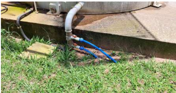
Foto 1 - Local de aplicação de cloro e flúor na tubulação de entrada do reservatório Planalto Serra Verde
