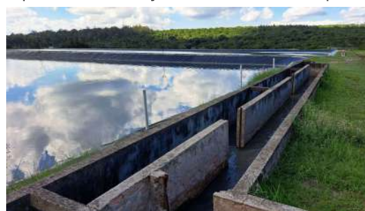
Foto 10 - Canal de distribuição de esgoto na primeira lagoa (anaeróbia)
