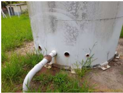
Foto 1 - Aberturas na parte inferior do Reservatório Ubá 2.
