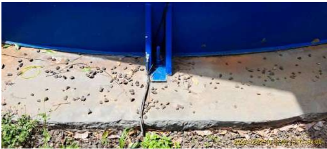
Foto 1 - Detalhe do aterramento do fio condutor.
