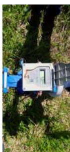
Foto 1 - Macromedidor - Poço Itaqueri da Serra (Novo)
