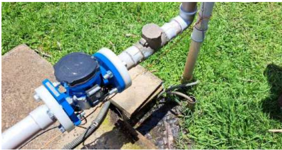
Foto 1 - Macromedidor - Poço Planalto Serra Verde
