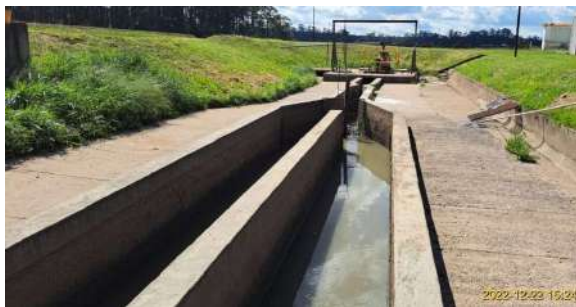
Foto 3 - Tratamento preliminar - Desarenador - ETE Itirapina
