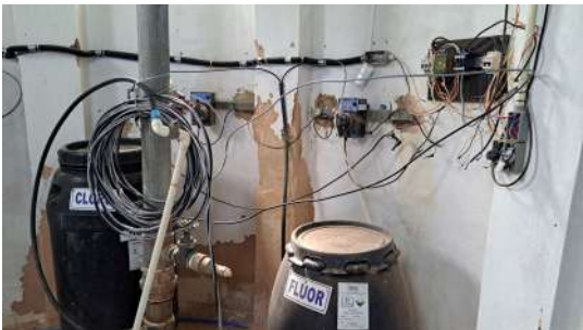
Foto 1 - Situação da instalação elétrica das bombas dosadoras instaladas na base do Reservatório Ubá 1
