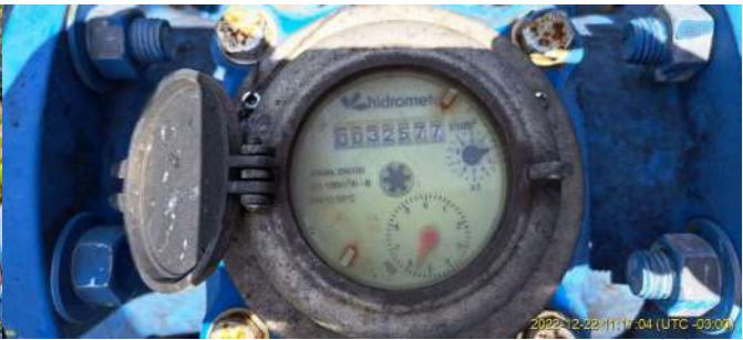
Foto 2 - Macromedidor - Poço Broa - Rua 4
