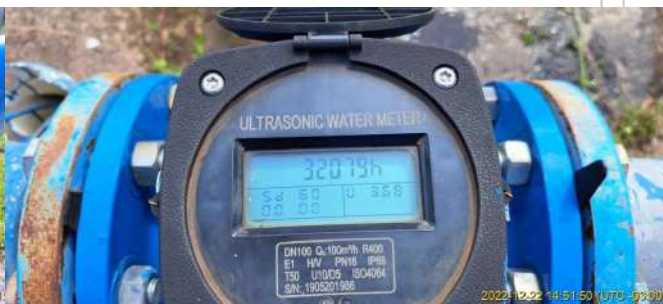
Foto 2 - Macromedidor - Poço Ubá 1
