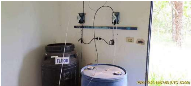
Foto 8 - Vista interna do abrigo de produtos químicos e bombas dosadoras
