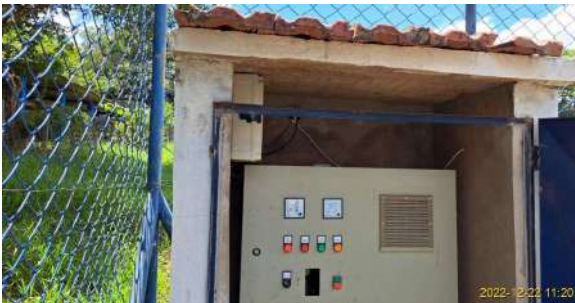
Foto 1 - Vista do painel de controle do Poço Broa - Rua 4
