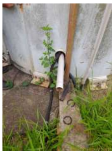
Foto 1 - Tubo extravasor Ausência de aterramento da estrutura metálica do reservatório e do fio condutor de descida - Reservatório Ubá 2
