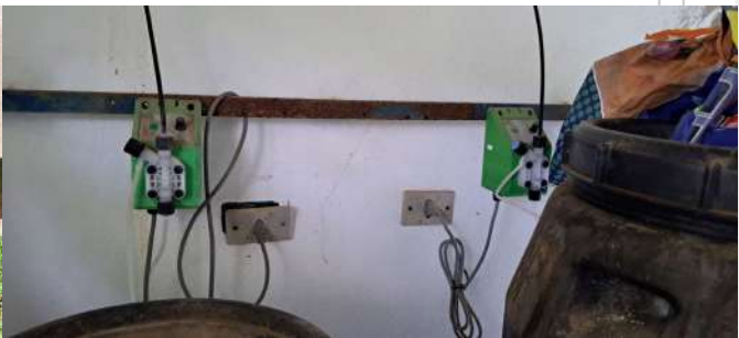
Foto 2 - Bombas dosadoras - Poço Planalto Serra Verde
