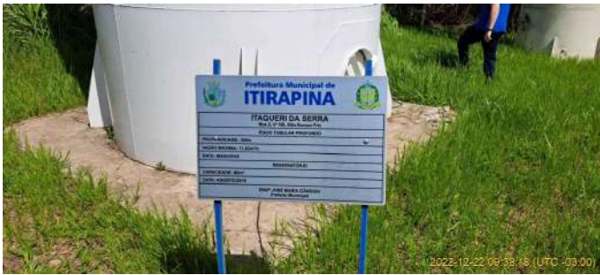
Foto 3 - Placa de identificação Vista geral - Reservatório Itaqueri da Serra
