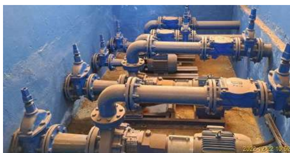
Foto 1 - Conjuntos motobomba da EEA Broa
