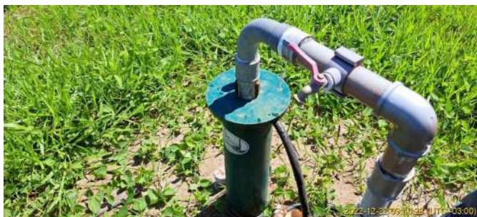
Foto 1 - Tomada de água bruta - Poço Itaqueri da Serra (Novo)
