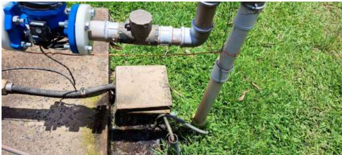
Foto 1 - Vazamento na tubulação situada após o macromedidor - Poço Planalto Serra Verde
