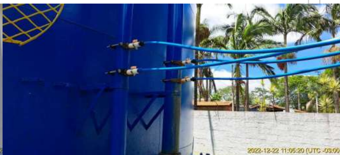
Foto 2 - Tubos para cloração e fluoretação - Sistema de Reservaão Broa
