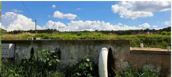
Foto 2 - Tanque com vazamentos aparentes - ETE Itirapina
