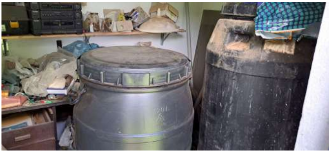
Foto 3 - Vista do interior do abrigo de químicos e bombas dosadoras - Poço Planalto Serra Verde
