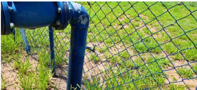
Foto 1 - Tomada de água bruta - Poço Broa - Rua
