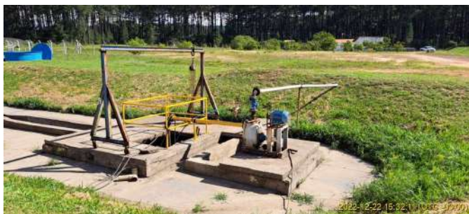
Foto 1 - Detalhe do poço onde são utilizadas duas bombas submersas e o conjunto motobomba externo.
