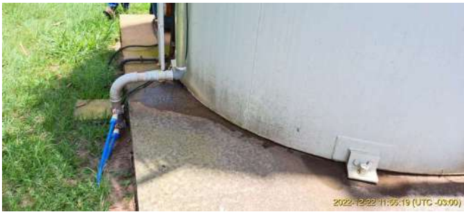
Foto 1 - Vazamento próximo a tubulação de entrada de água no Reservatório.
