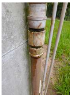
Foto 3 - Vazamento na tubulação de chegada de água - Reservatório Ubá 2
