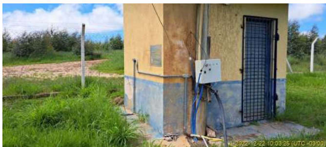
Foto 7 - Abrigo de painéis eletrônicos e produtos químicos - Poço Itaqueri da Serra (Novo)
