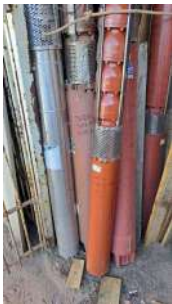
Foto 1 - Bomba reserva do Poço Broa (Rua 13)
