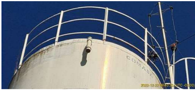
Foto 1 - Tubo extravasor - Reservatório Itaqueri da Serra
