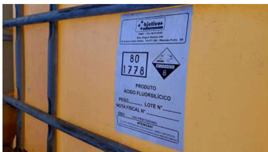
Foto 3 - Tanque de flúor no estoque do DAE Itirapina
