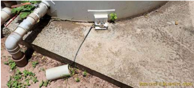
Foto 1 - Detalhe do aterramento da estrutura metálica do Reservatório
