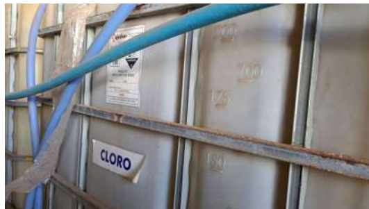
Foto 6 - Tanque de cloro no estoque do DAE Itirapina
