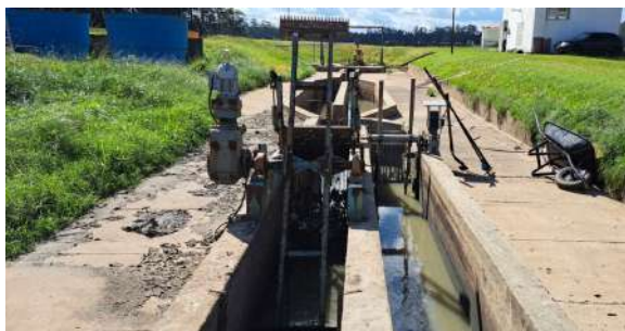
Foto 7 - Tratamento preliminar - Gradeamento - ETE Itirapina
