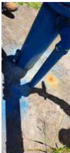
Foto 1 - Tubo de medição de nível - Poço Broa -
