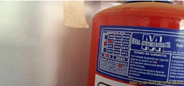
Foto 2 - Detalhe da data de validade do extintor de incêndio - EEA Broa
