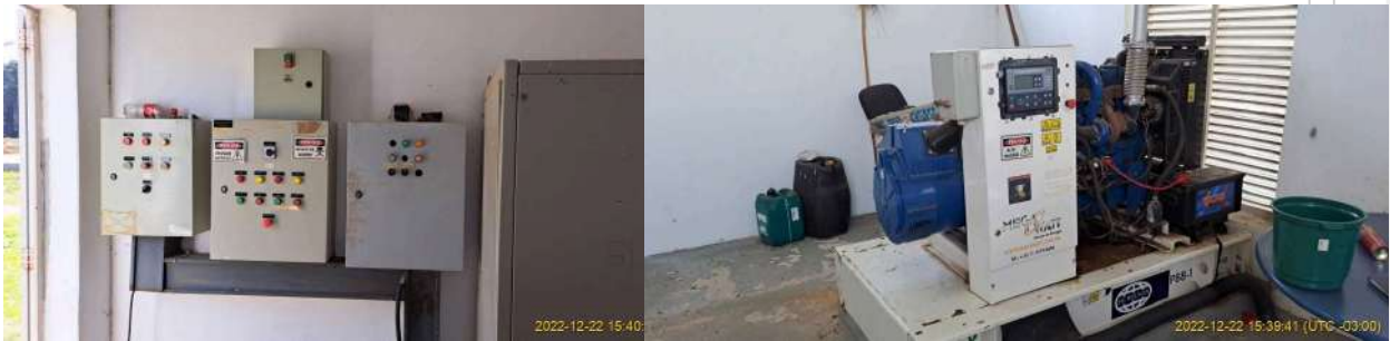
Foto 1 - Painel de controle elétrico da ETE Itirapina
