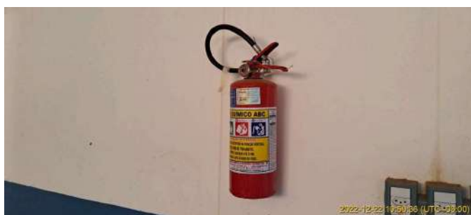
Foto 1 - Extintor de incêndio - EEA Broa
