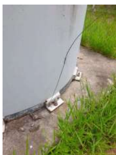
Foto 1 - Ausência de aterramento da estrutura metálica do reservatório e do fio condutor de descida - Reservatório Ubá 2
