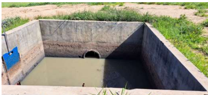
Foto 5 - Chegada do esgoto bruto na entrada da ETE Itirapina
