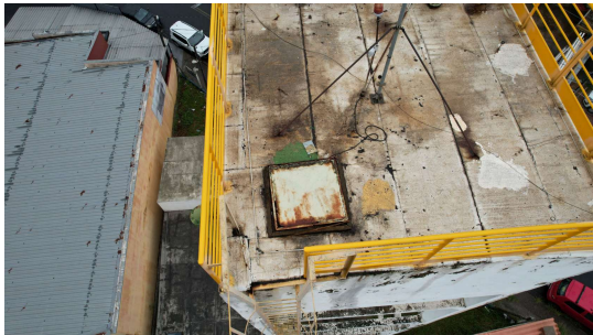
Foto 1 - Situação da tampa de inspeção do Reservatório Elevado São Marcos - visão ampla
