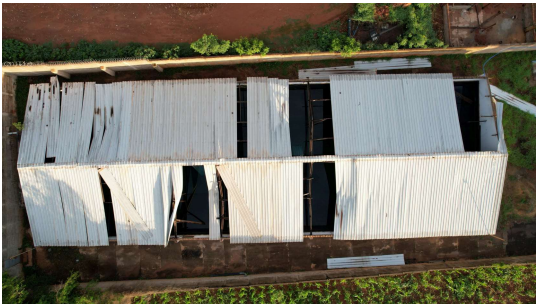
Foto 2 - Visão aérea com enfoque em áreas sem cobertura no Reservatório 2,5 milhões manta pead Bairro Alto
