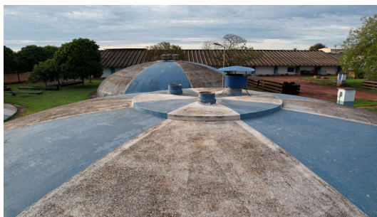
Foto 2 - Ausência de cobertura e tela nas tubulações de ventilação (2)
