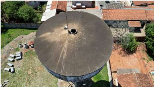
Foto 1 - Ausência de tampa de inspeção na cobertura - Reservatório elevado Jd Paulista
