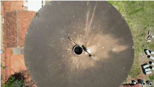
Foto 2 - Ausência de tampa de inspeção na cobertura - Reservatório elevado Jd Paulista
