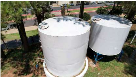
Foto 2 - Vista geral - Reservatórios Ginásio II (esquerda) e da Balança (direita)
