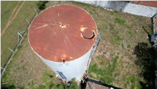
Foto 1 - Ausência de para-raios - Reservatório elevado CDHU
