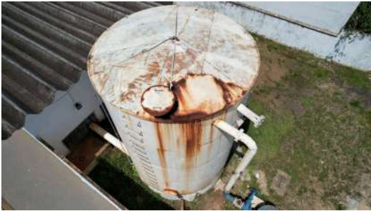
Foto 1 - Ausência de guarda-corpos - Reservatório de transição Figueira Branca
