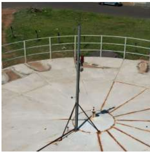
Foto 2 - Detalhe do fio condutor de descida do para-raios cortado - Reservatório Filipão Novo
