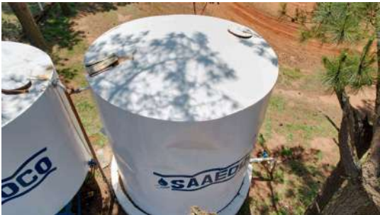
Foto 2 - Tampa inadequada na parte à esquerda da cobertura - Reservatório Ginásio
