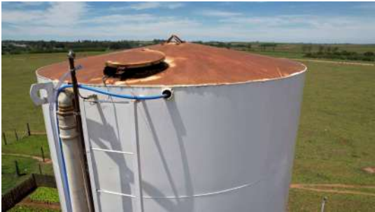
Foto 1 - Tubulação de respiro/extravasor sem proteção - Reservatório elevado CDHU
