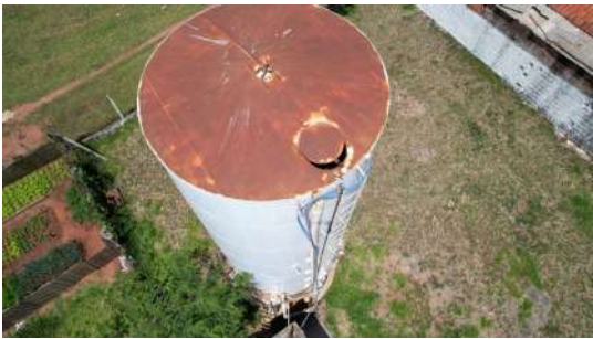
Foto 1 - Ausência de guarda-corpos - Reservatório elevado CDHU
