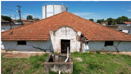
Foto 1 - Vista frontal com destaque para rachaduras em toda a parede externa.
