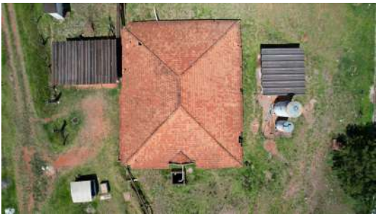
Foto 2 - Ausência de telhas na cobertura do reservatório.
