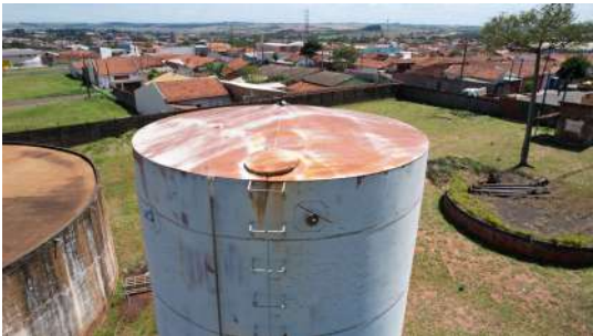
Foto 1 - Tubo extravasor tampado - Reservatório elevado João Viotto 2
