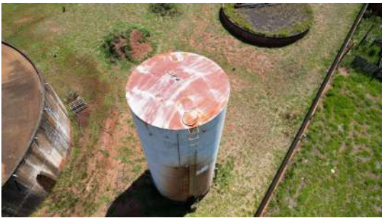
Foto 1 - Ausência de guarda-corpo em escada e próximo à tamp de inspeção - Reservatório elevado João Viotto 2
