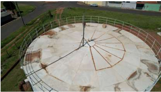
Foto 1 - Fio condutor de descida do para-raios cortado - Reservatório Filipão Novo
