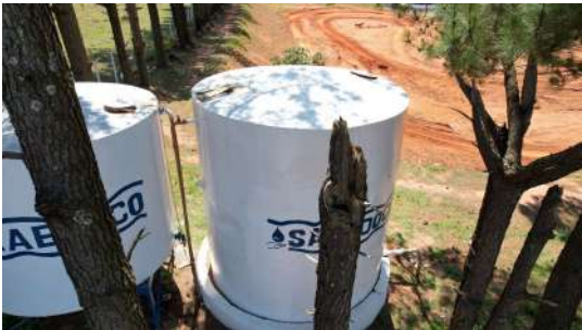
Foto 1 - Tampa inadequada na parte à esquerda da cobertura - Reservatório Ginásio
