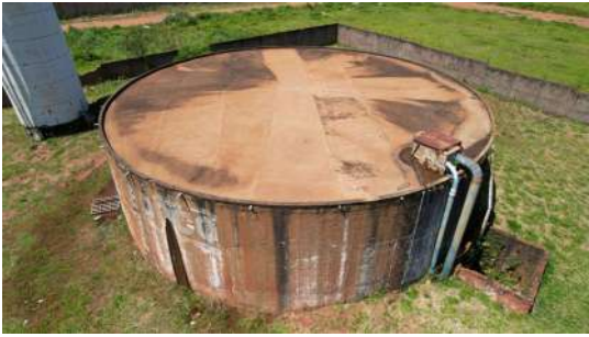
Foto 1 - Vazamento aparente - Reservatório João Viotto 1
