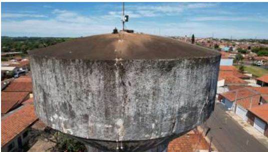
Foto 2 - Fio condutor de descida do para-raios cortado - Reservatório Jd Paulista
