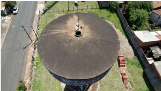
Foto 1 - Fio condutor de descida do para-raios cortado - Reservatório Jd Paulista
