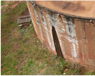
Foto 2 - Detalhe do vazamento - Reservatório João Viotto 1
