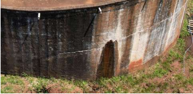
Foto 4 - Detalhe do vazamento - Reservatório João Viotto 1
