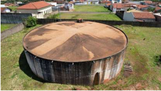
Foto 3 - Vazamento aparente - Reservatório João Viotto 1
