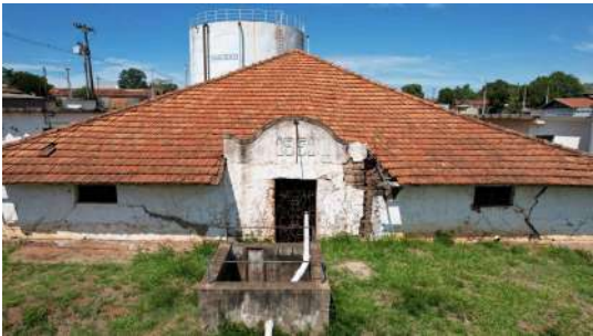
Foto 3 - Situação estrutural - Reservatório enterrado Filipão Velho
