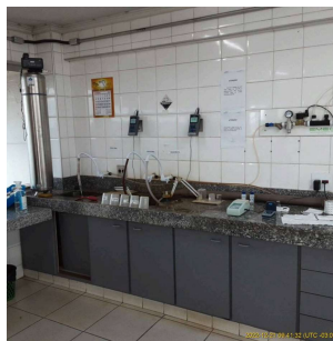
Foto 2 - Laboratório da ETA em Leme
