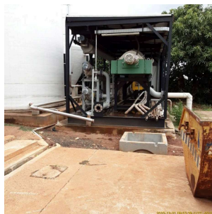
Foto 2 - Centrífuga de lodo da ETA em Leme
