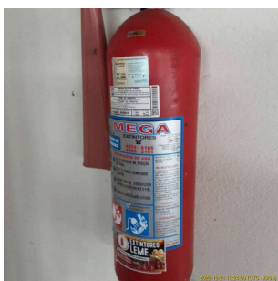
Foto 1 - Extintor de incêndio na Captação do Ribeirão do Roque em Leme
