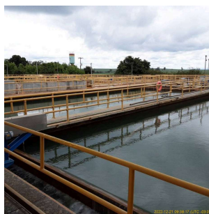
Foto 4 - Vista dos decantadores da ETA em Leme
