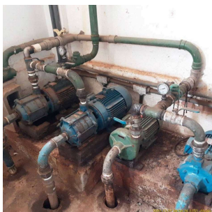
Foto 1 - Sala de bombas da ETA em Leme
