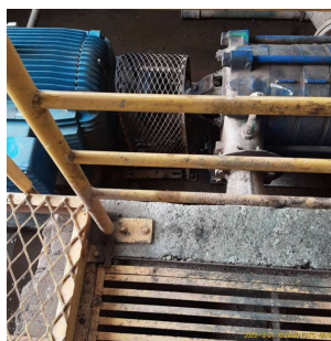
Foto 4 - Drenagem inadequada de água de lubrificação de gaxetas das bombas de Captação do Ribeirão do Roque em Leme
