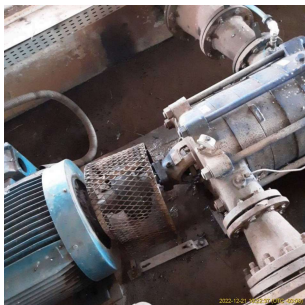
Foto 1 - Drenagem inadequada de água de lubrificação de gaxetas das bombas de Captação do Ribeirão do Roque em Leme
