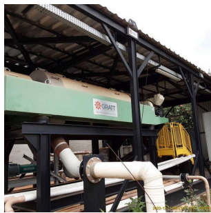
Foto 3 - Centrifuga de lodo da ETA em Leme
