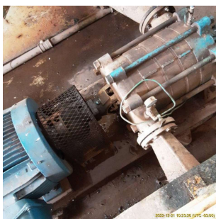
Foto 3 - Drenagem inadequada de água de lubrificação de gaxetas das bombas de Captação do Ribeirão do Roque em Leme
