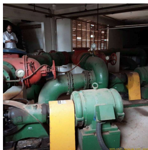
Foto 2 - Sala de bombas da ETA em Leme
