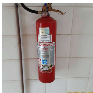
Foto 1 - Extintor de incêndio da ETA em Leme
