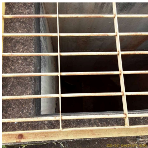
Foto 1 - Local onde ocorre o extravasamento dos reservatórios da ETA em Leme
