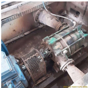
Foto 2 - Drenagem inadequada de água de lubrificação de gaxetas das bombas de Captação do Ribeirão do Roque em Leme
