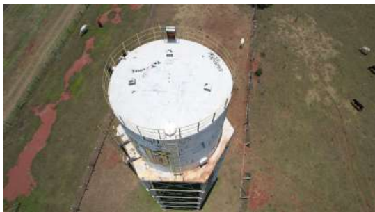
Foto 1 - Imagens captadas com auxílio de drone no dia 28/11/2022 dos guarda-corpos no Reservatório Universidade em Araraquara
