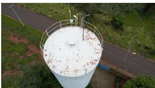
Foto 1 - Imagens captadas com auxílio de drone no dia 28/11/2022 da tubulação de ventilação no Reservatório Bandeirantes em Araraquara
