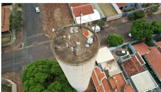
Foto 1 - Imagens captadas com auxílio de drone no dia 28/11/2022 do para-raios no Reservatório R28 de Araraquara
