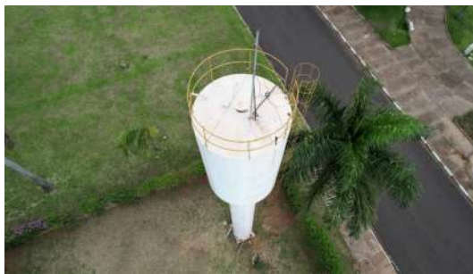
Foto 2 - Imagens captadas com auxílio de drone no dia 28/11/2022 do para-raio do Reservatório Bueno de Andrade em Araraquara
