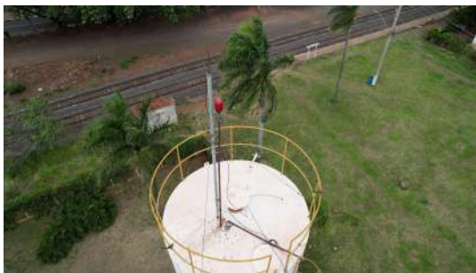
Foto 1 - Imagens captadas com auxílio de drone no dia 28/11/2022 do para-raio do Reservatório Bueno de Andrade em Araraquara
