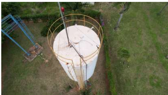
Foto 1 - Imagens captadas com auxílio de drone no dia 28/11/2022 dos guarda-corpos do Reservatório Bueno de Andrade em Araraquara
