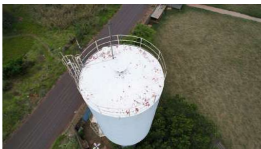
Foto 1 - Imagens captadas com auxílio de drone no dia 28/11/2022 do para-raios no Reservatório Bandeirantes em Araraquara
