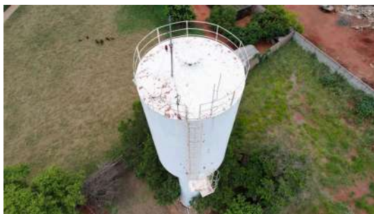
Foto 1 - Imagens captadas com auxílio de drone no dia 28/11/2022 do guarda-corpo no Reservatório Bandeirantes em Araraquara
