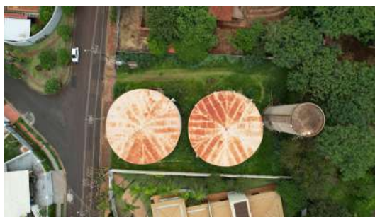
Foto 2 - Vista superior dos reservatórios apoiados
