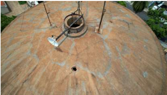
Foto 1 - Ausência de tampa de inspeção
