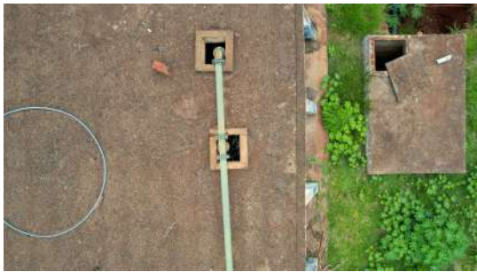
Foto 1 - Ausência de tampa de inspeção
