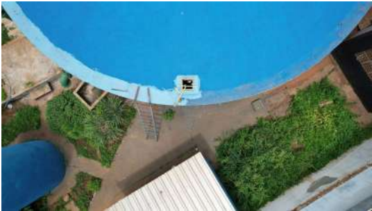
Foto 1 - Ausência de tampa de inspeção
