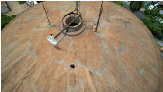
Foto 1 - Furos abertos na cobertura do reservatório
