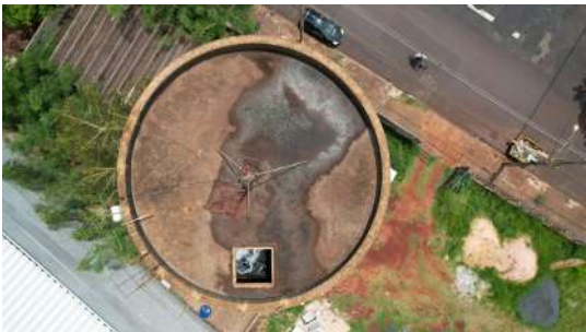
Foto 1 - Ausência de tampa de inspeção
