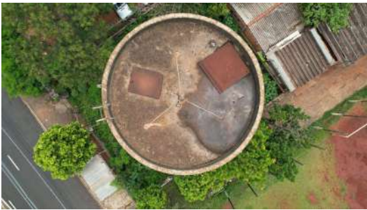
Foto 1 - Tampa de inspeção oxidada, com abertura
