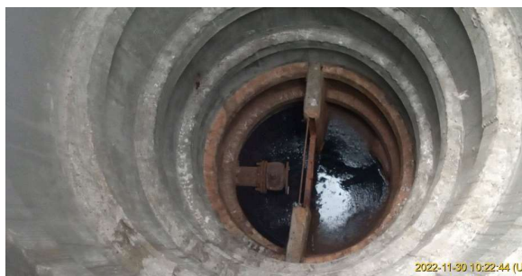
Foto 1 - Vista do sistema de gradeamento.
