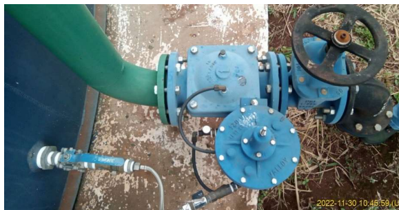
Foto 1 - Vista da válvula com solenóide para controle remoto.
