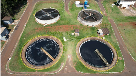
Foto 5 - Vista superior dos filtros e decantadores
