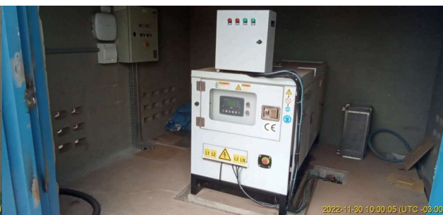
Foto 2 - Gerador de energia.
