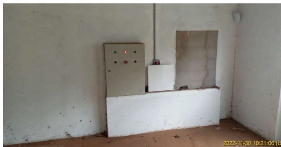
Foto 3 - Vista do painel de controle.
