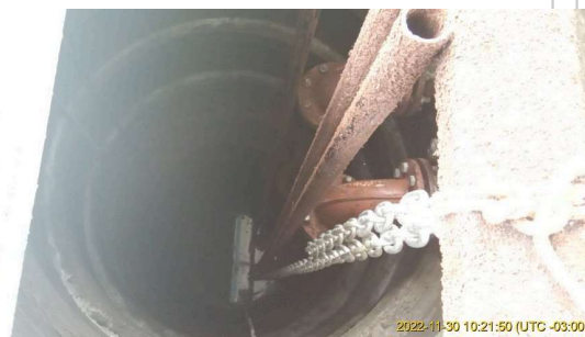
Foto 2 - Vista do poço de sucção.
