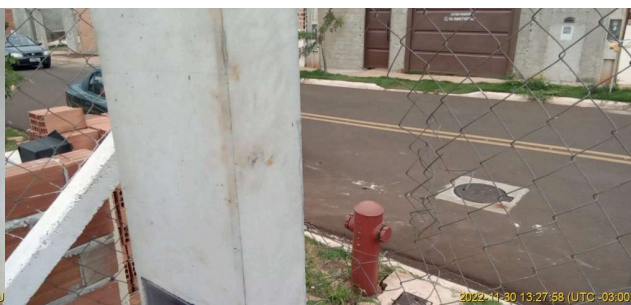
Foto 2 - Vista de abertura do cercamento.
