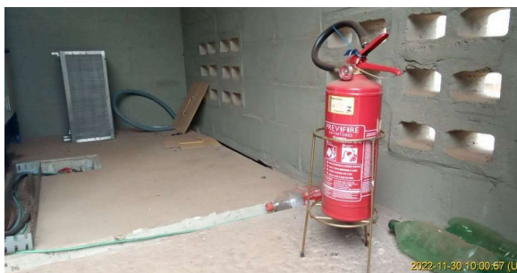
Foto 1 - Extintor localizado junto ao gerador.
