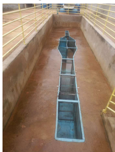
Foto 7 - Vista do sistema de gradeamento.
