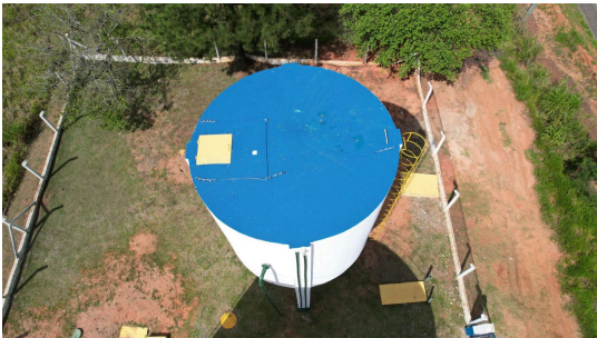
Foto 1 - Cobertura do reservatório sem guarda-corpos.
