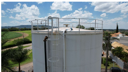
Foto 1 - Detalhe da tubulação de ventilação.
