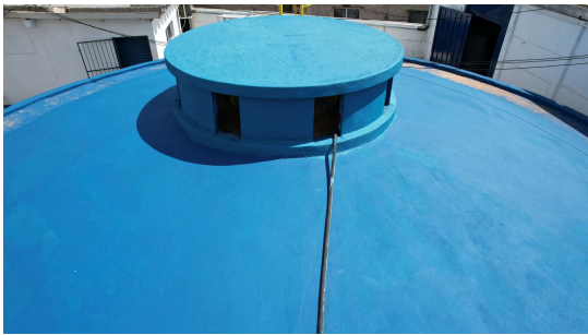
Foto 1 - Detalhe da ventilação.
