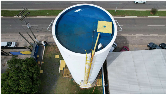
Foto 1 - Detalhe do topo do reservatório evidenciando a ausência de para-raios no reservatório elevado.
