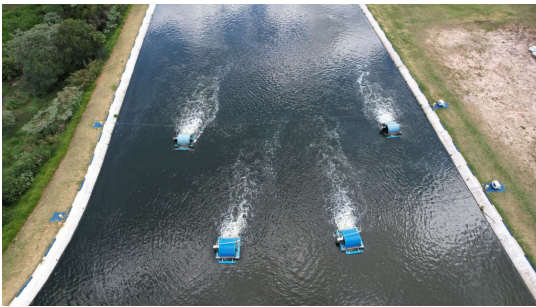
Foto 6 - Detalhe dos aeradores na lagoa.
