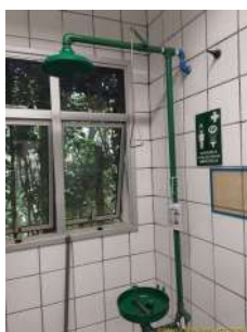
Foto 1 - Chuveiro de emergência junto ao laboratório.
