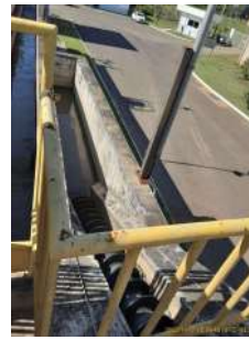
Foto 34 - Rosca sem fim utilizada para transporte da areia acumulada no fundo da caixa.
