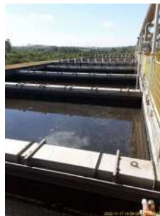
Foto 13 - Vista geral 2 dos reatores.
