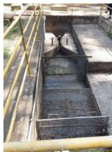
Foto 2 - Detalhe do gradeamento grosseiro.
