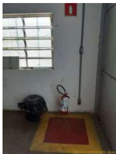
Foto 1 - Extintor junto à EEE.
