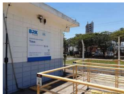
Foto 2 - Vista geral 2 da EEE.
