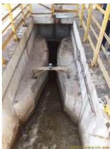
Foto 1 - Vista da calha Parshall e sensor na chegada do esgoto bruto junto ao tratamento preliminar.
