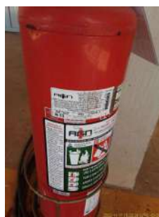
Foto 2 - Extintor 2 com validade adequada.
