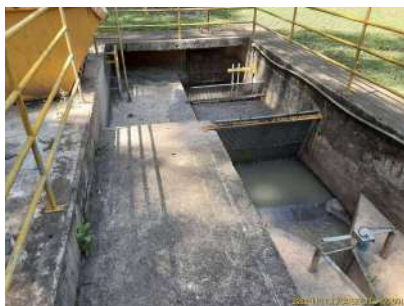
Foto 1 - Chegada do esgoto bruto.
