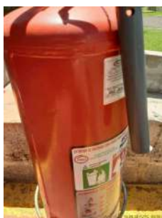
Foto 1 - Extintor 1 com validade adequada.
