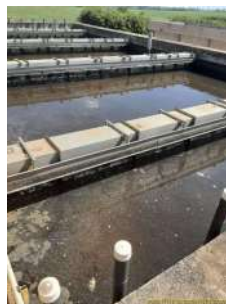
Foto 11 - Reator em fase de decantação.
