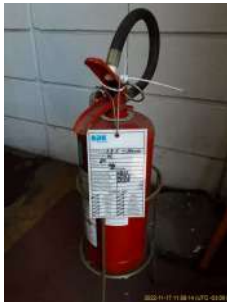
Foto 1 - Extintor dentro da casa da EEE.
