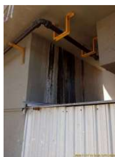
Foto 2 - Detalhe do vazamento junto ao tratamento preliminar.
