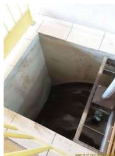
Foto 18 - Saída do efluente após a desinfecção.
