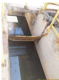
Foto 11 - Gradeamento fino reserva manual na chegada da ETE.
