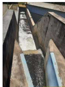
Foto 21 - Saída do efluente tratado.
