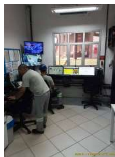
Foto 6 - CCO da ETE Conduta.
