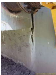
Foto 3 - Vazamento 1 junto ao tanque de aeração.
