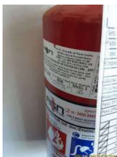
Foto 1 - Extintor de incêndio com validade adequada.
