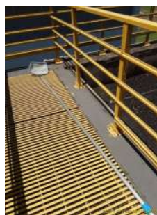
Foto 4 - Ponto 4 - ausência de barra inferior no guarda-corpo.
