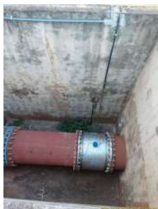
Foto 1 - Sensor para medição da vazão de saída.
