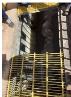
Foto 7 - Passagem do esgoto sob a passarela.
