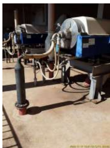
Foto 27 - Vista geral 2 das centrífugas em operação.
