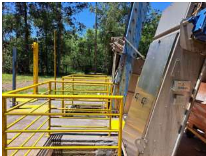
Foto 1 - Tratamento preliminar (grades) - ETE Conduta
