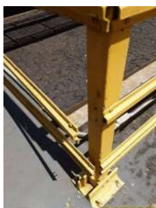
Foto 1 - Ponto 1 - guarda-corpo com barra de segurança solta.
