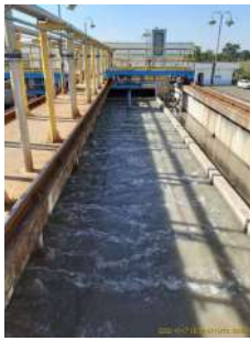
Foto 33 - Caixa de areia em operação.
