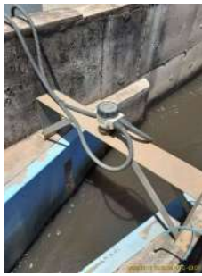
Foto 3 - Vista da calha Parshall e sensor na saída do efluente tratado.
