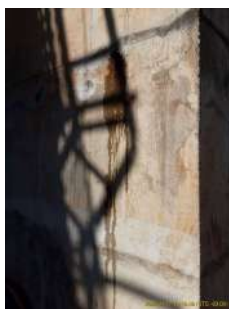
Foto 1 - Vazamento identificado próximo ao tratamento preliminar da ETE Jardim Novo.
