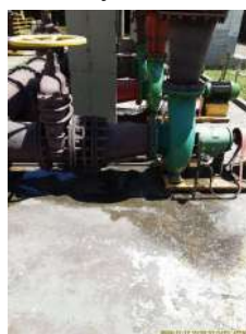
Foto 6 - Vista lateral do vazamento junto às bombas de recirculação do lodo.
