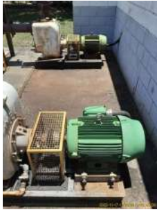
Foto 1 - Bombas em operação.
