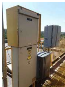
Foto 9 - Painéis junto aos sensores.
