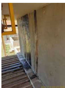
Foto 1 - Vazamento junto ao tratamento preliminar.
