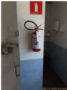
Foto 1 - Extintor de incêndio dentro da casa da EEE.
