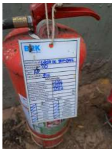
Foto 1 - Extintores - EEE ETE Conduta
