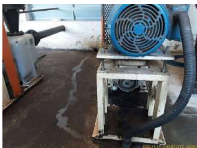
Foto 1 - Vazamento identificado próximo a uma das bombas.
