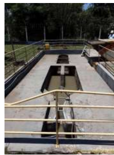
Foto 2 - Chegada do esgoto bruto.
