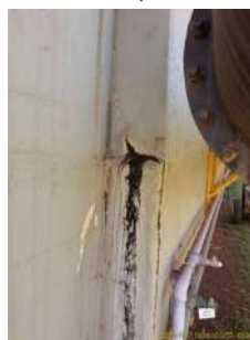
Foto 4 - Vazamento 2 junto ao tanque de aeração.
