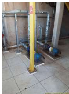
Foto 16 - Bombas instaladas junto à desinfecção UV.
