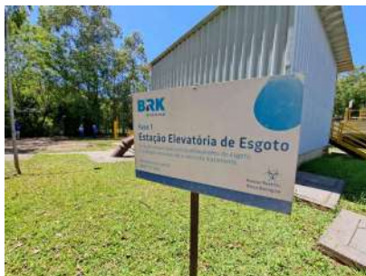
Foto 1 - Placa de identificação - EEE ETE Conduta
