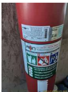
Foto 1 - Extintor 1 com validade adequada.
