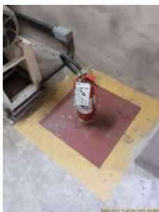
Foto 1 - Extintor dentro das instalações da EEE.
