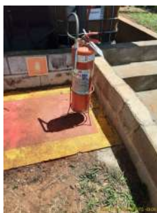
Foto 1 - Extintor próximos à casa da EEE.
