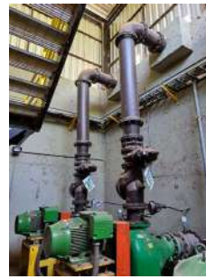
Foto 2 - Conjuntos motor bombas - ETE Conduta
