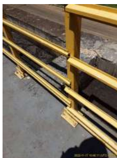
Foto 3 - Ponto 3 - guarda-corpo com barras de segurança soltas.
