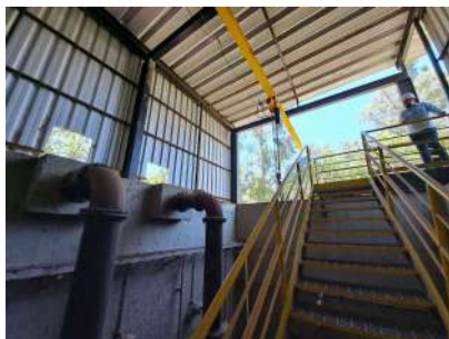
Foto 3 - Guarda corpos - EEE ETE Conduta
