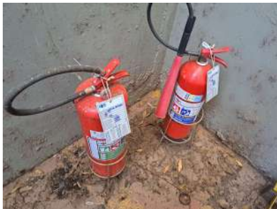
Foto 1 - Extintores - ETE Conduta
