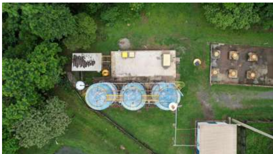
Foto 3 - Detalhe dos tanques UASB.
