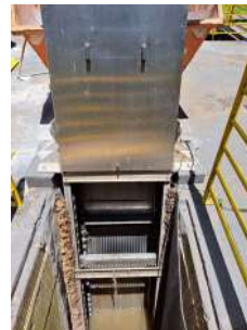
Foto 2 - Tratamento preliminar (grades) - ETE Conduta
