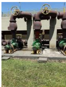
Foto 20 - Bombeamento usado na recirculação do lodo.
