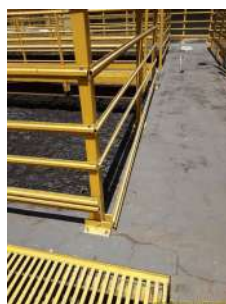
Foto 2 - Ponto 2 - guarda-corpo com barra de segurança solta e apoiada sobre o chão.
