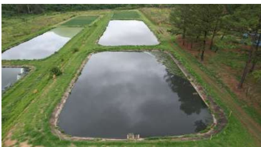
Foto 3 - Detalhe 1 das lagoas da ETE.
