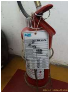
Foto 1 - Extintor com validade adequada.
