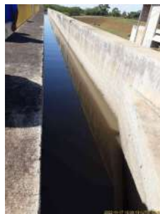
Foto 14 - Canal de alimentação dos reatores 1, 2 e 3.
