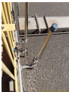
Foto 8 - Sensores de controle.
