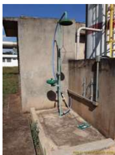
Foto 1 - Chuveiro de emergência.
