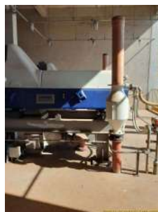
Foto 26 - Vista geral 1 das centrífugas em operação.
