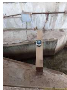
Foto 2 - Detalhe do sensor junto à Calha Parshall.
