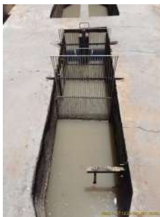
Foto 1 - Detalhe do gradeamento na chegada do esgoto bruto.
