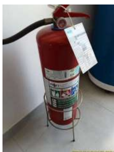
Foto 1 - Extintor de incêndio junto ao laboratório.
