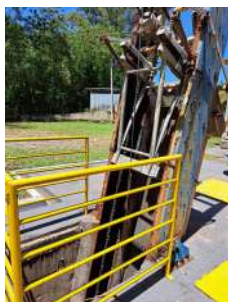
Foto 3 - Tratamento preliminar (grades) - ETE Conduta
