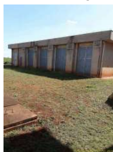
Foto 21 - Estrutura dos sopradores de ar.
