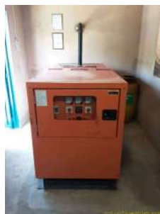
Foto 2 - Gerador da EEE.
