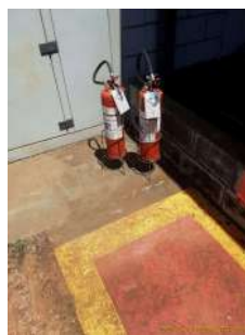
Foto 2 - Extintor próximo à casa da EEE.
