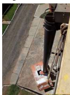
Foto 14 - Tubulação guia para os resíduos retidos no gradeamento.
