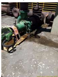
Foto 5 - A drenagem de lubrificação das gaxetas junto às bombas de recirculação de lodo está inadequada.
