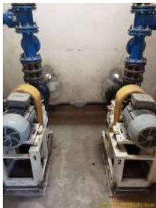
Foto 1 - Bombas instaladas na EEE.
