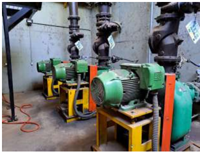
Foto 1 - Conjuntos motor bombas - ETE Conduta
