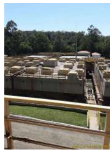
Foto 16 - Vista geral dos reatores anaeróbios.
