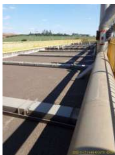
Foto 6 - Vista geral dos reatores.
