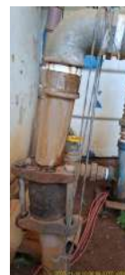
Foto 2 - Detalhe do vazamento na tubulação das bombas
