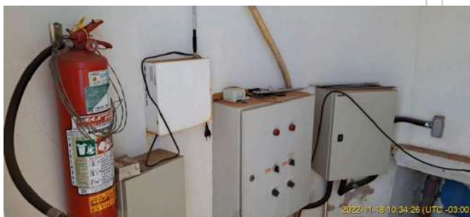
Foto 4 - Extintor de incêndio e painéis de controle
