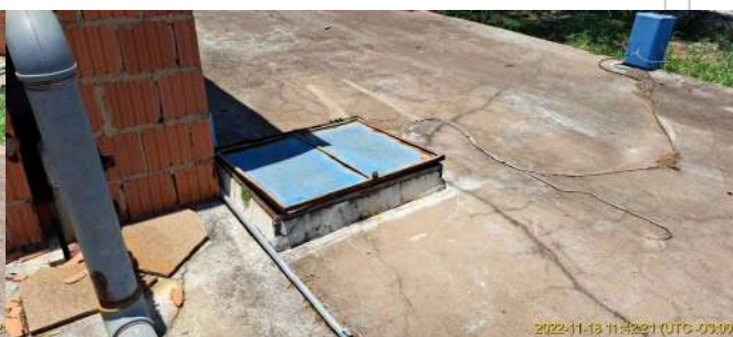
Foto 2 - Tubulação sem tela de proteção
