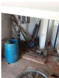
Foto 1 - Vista do interior da estação elevatória
