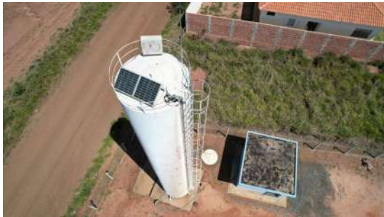
Foto 1 - Ausência de tela de proteção em tubo extravasor do Reservatório Santa Amélia
