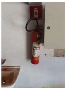
Foto 1 - Extintor de incêndio da EEAT
