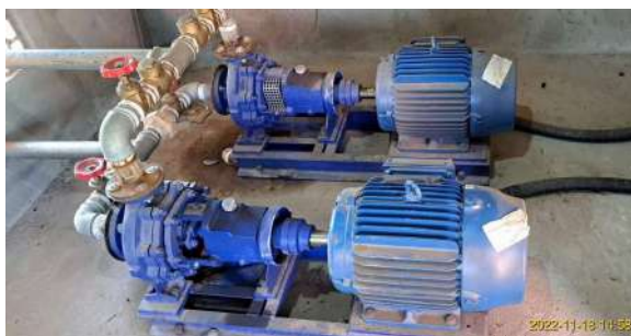
Foto 1 - Conjuntos motobomba da estação elevatória
