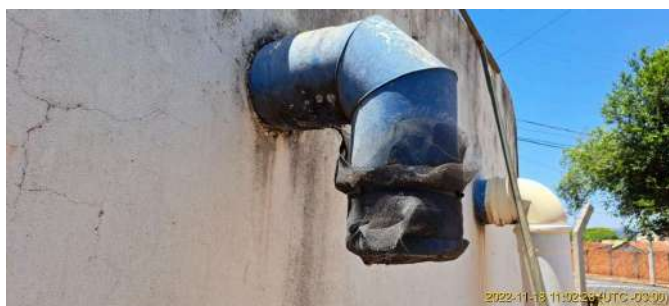
Foto 1 - Tela de proteção no tubo extravasor.
