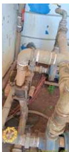
Foto 1 - Vazamentos na tubulação das bombas
