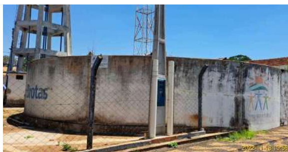
Foto 1 - Vista frontal do Sistema de Abastecimento da Polícia Militar
