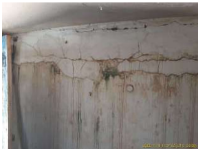
Foto 1 - Trincas na parede interna da EEAT
