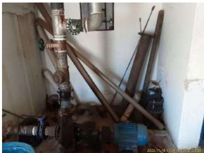
Foto 3 - Material armazenado na EEAT
