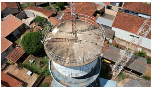
Foto 4 - Sinais de vazamentos - Reservatório elevado Polícia Militar
