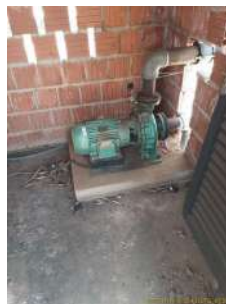
Foto 2 - Vista interna da EEAT 1 Campos Elíseos I e do conjunto motobomba
