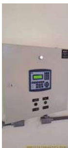
Foto 1 - Sistema supervisório do Reservatório Apoiado Santa Maria
