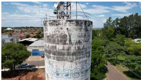
Foto 1 - Ausência de tela de proteção em tubulação - Reservatório elevado Campos Elísios I
