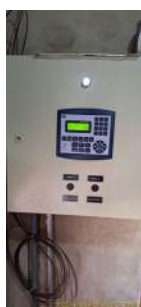
Foto 1 - Sistema supervisório dos reservatórios
