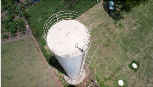
Foto 1 - Ausência de tela de proteção em tubo extravasor no reservatório novo - Campos Elísios II
