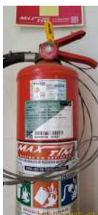
Foto 1 - Extintor de incêndio com validade expirada
