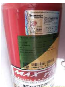
Foto 1 - Extintor de incêndio com validade expirada
