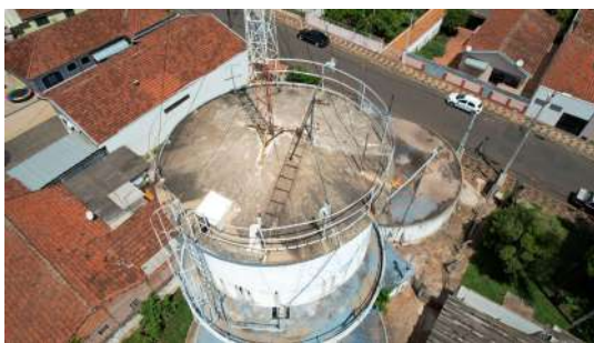
Foto 5 - Sinais de vazamentos - Reservatório elevado Polícia Militar
