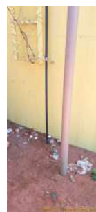
Foto 2 - Aterramento do Fio condutor de descida do para-raios
