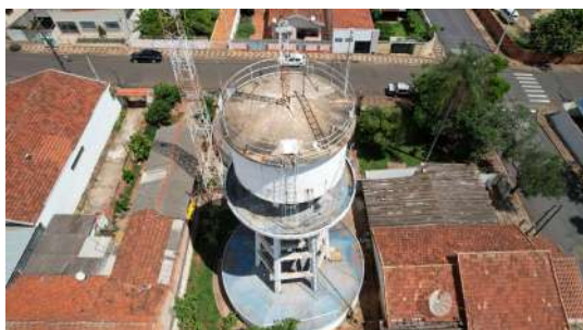
Foto 3 - Vista geral - Reservatório elevado Polícia Militar
