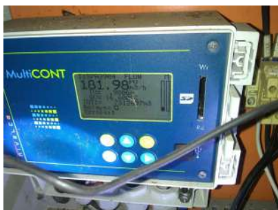
Foto 1 - Medidor de Vazão de saída da ETE
