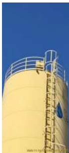
Foto 1 - Ausência de telas de proteção no tubo extravasor.
