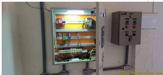
Foto 2 - Sistema supervisório do Reservatório Apoiado Santa Maria
