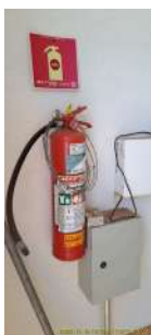
Foto 1 - Extintor de incêndio
