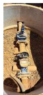
Foto 4 - Medidor de vazão e registro do Reservatório elevado Santa Amélia
