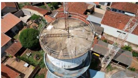
Foto 1 - Sinais de vazamentos - Reservatório elevado Polícia Militar
