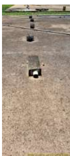
Foto 1 - Tubulação sem tela de proteção
