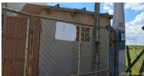
Foto 1 - Ausência de identificação da área
