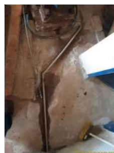
Foto 2 - Sistema de drenagem da água das gaxetas
