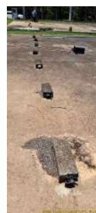
Foto 2 - Tubulação sem tela de proteção
