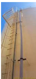
Foto 1 - Fio condutor de descida do para-raios
