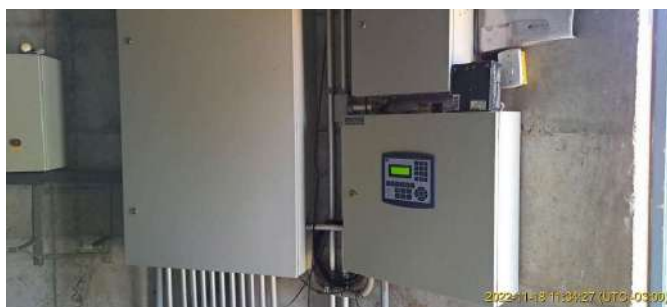
Foto 1 - Sistema supervisorio do Reservatório elevado
