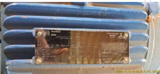
Foto 2 - Especificações de um dos conjuntos motobombas da estação elevatória
