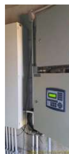
Foto 2 - Sistema supervisorio do Reservatório elevado
