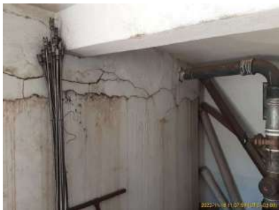
Foto 2 - Trincas na parede interna da EEAT
