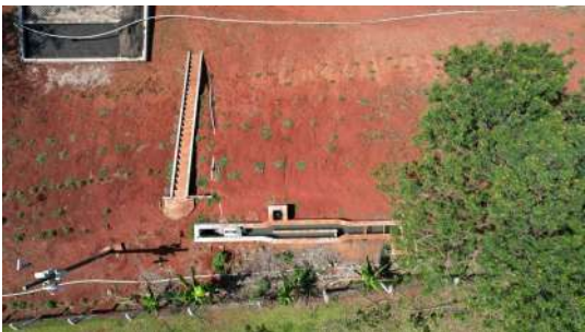
Foto 4 - Chegada de esgoto bruto e tratamento preliminar - ETE Patrimônio
