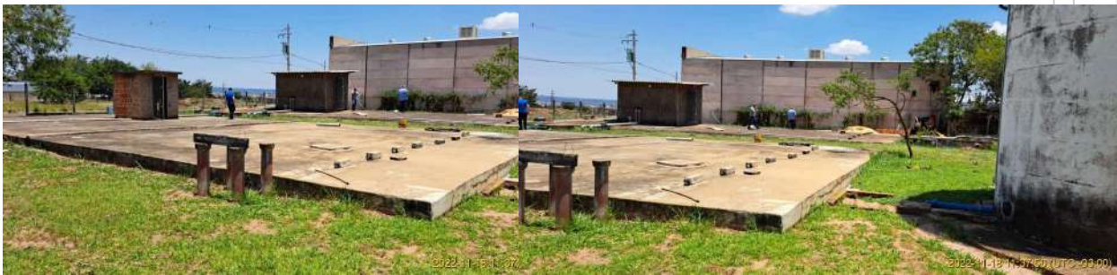
Foto 1 - Vista geral dos reservatórios enterrados Campos Elísios I
