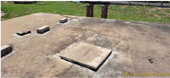
Foto 3 - Tubulação sem tela de proteção
