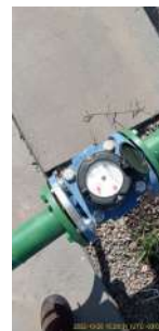
Foto 2 - Macromedidor do Poço São João
