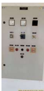
Foto 5 - Quadro de comando do Booster da Residencial Jaboticabal
