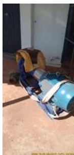
Foto 5 - Bomba retirada para manutenção - EEAT Perina
