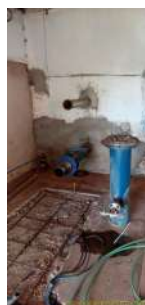
Foto 4 - Local de posicionamento da bomba suplente da EEAT Perina
