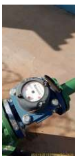
Foto 4 - Macromedidor do Poço Bom Jesus
