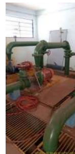
Foto 2 - Sala de bombas com duas bombas em operação e uma reserva.
