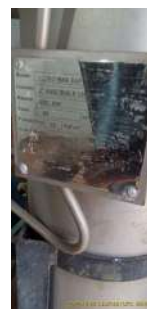
Foto 6 - Filtro Bag da ETA Estiva
