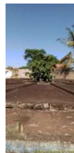
Foto 2 - Vegetação no topo do reservatório, sobre a ventilação (2)
