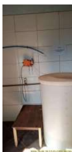
Foto 1 - Tanque de dosagem de produtos químicos (1)
