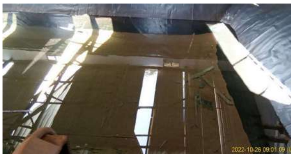
Foto 3 - Fundo do reservatório com parte da estrutura desmoronada e excesso de sedimentos
