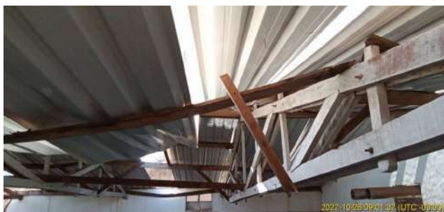
Foto 5 - Estrutura da cobertura do reservatório comprometida
