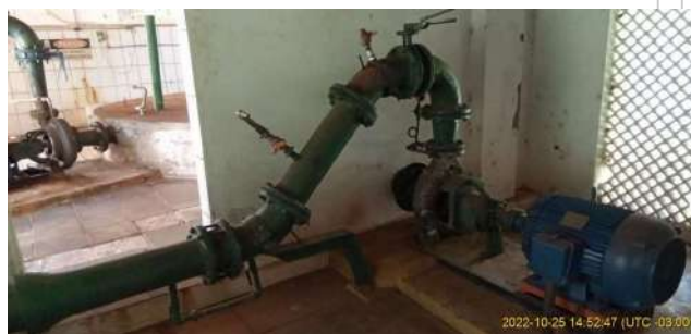
Foto 4 - Conjunto motobomba reserva da EEAT Estiva
