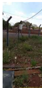
Foto 4 - Quadro de energia do Reservatório Lusitânia
