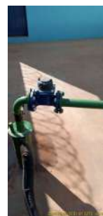
Foto 3 - Detalhes da captação do Poço Bom Jesus
