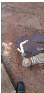
Foto 1 - Tomada de água bruta do Poço Lusitânia
