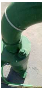
Foto 4 - Detalhe de local do tubo medidor de nível
