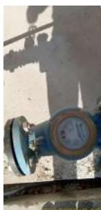
Foto 3 - Macromedidor do Poço Romana
