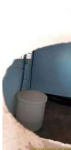
Foto 7 - Tanque de dosagem de produto químico (2)
