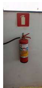
Foto 4 - Extintor de incêndio na sala de bombas
