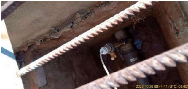
Foto 3 - Ponto de dosagem dos produtos químicos
