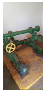
Foto 4 - Bombas da Booster da Residencial Jaboticabal, sendo uma suplente
