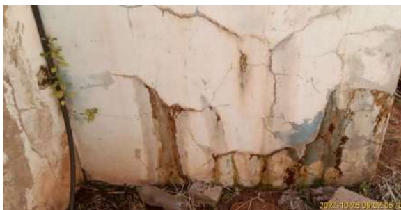
Foto 1 - Marcas de vazamento na lateral do reservatório
