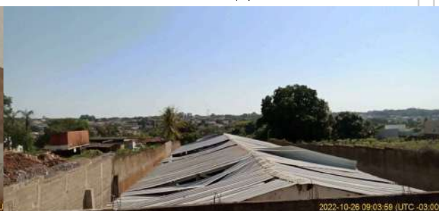
Foto 4 - Cobertura do reservatório comprometida
