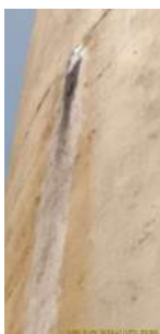
Foto 1 - Ponto de vazamento no Reservatório São Marcos
