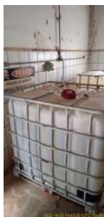
Foto 3 - Tanque de hipoclorito de sódio e bomba dosadora
