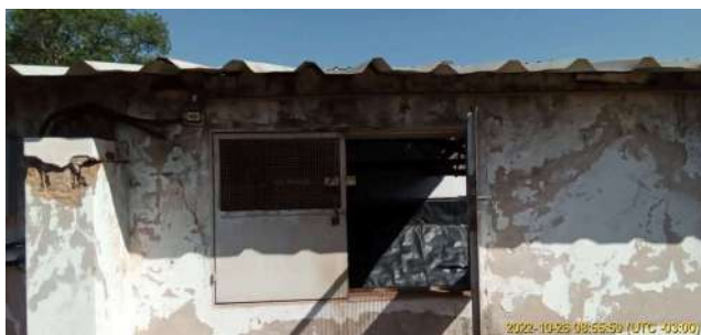
Foto 1 - Ventilação do reservatório sem tela de proteção contra entrada de insetos e pequenos animais.
