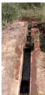
Foto 3 - Medidor de vazão da ETE Lusitânia
