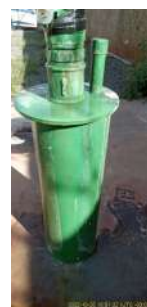
Foto 5 - Tubo medidor de nível do Poço Bom Jesus
