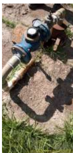
Foto 1 - Macromedidor e ausência de tomada de água para coleta de água bruta.
