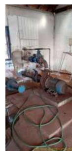
Foto 2 - Bomba da EEAT Perina
