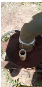
Foto 1 - Tubo de medição de nível sem tampa de proteção
