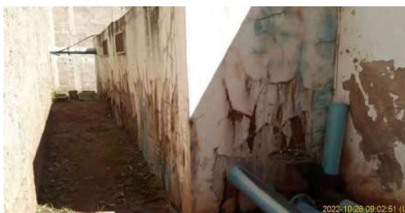
Foto 3 - Marcas de vazamento na lateral do reservatório (3)
