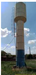
Foto 3 - Visão lateral do do Reservatório Lusitânia
