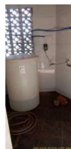
Foto 2 - Tanque de dosagem de produtos químicos (2)
