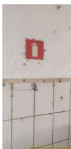
Foto 1 - Ausência de extintor de incêndio no local destinado
