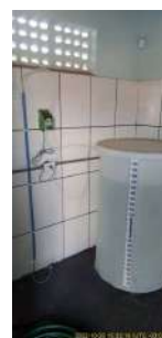
Foto 2 - Tanque de fluoretação
