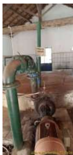
Foto 1 - Poço de sucção à "ETA Estiva"
