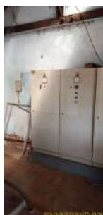
Foto 3 - Quadro de comando da EEAT Perina
