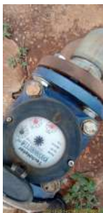
Foto 1 - Macromedidor do Poço Lusitânia
