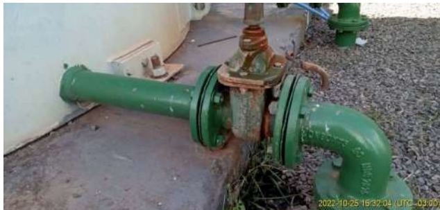
Foto 1 - Localização de vazamento no Reservatório São José
