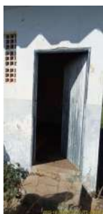
Foto 3 - Casa de bombas do Booster da Residencial Jaboticabal
