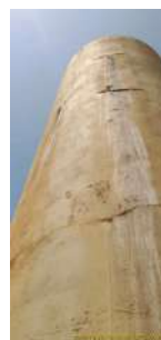
Foto 2 - Manchas de vazamento no Reservatório São Marcos
