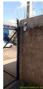
Foto 2 - Alarme na área do Poço Bom Jesus
