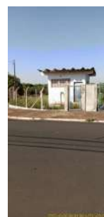
Foto 6 - Aspecto geral do Booster da Residencial Jaboticabal
