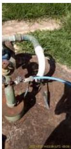
Foto 1 - Tubulação de saída do Poço 1 sem tomada de água para coleta
