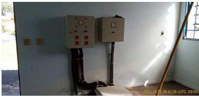
Foto 3 - Quadro de comando da EEAT Bairro Alto (Santo Antônio e Vale do Sol)
