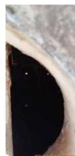
Foto 2 - Abertura de ventilação sem tela de proteção contra a entrada de insetos e pequenos animais nas tubulações de ventilação (2)
