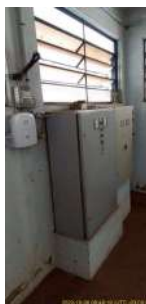
Foto 3 - Quadro elétrico de comando da EEAT
