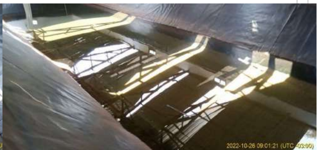
Foto 4 - Incidência de luz no fundo do reservatório evidenciando pontos da cobertura com ausência de telha
