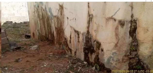
Foto 2 - Marcas de vazamento na lateral do reservatório (2)
