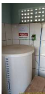
Foto 1 - Tanque e dosagem de hipoclorito de sódio
