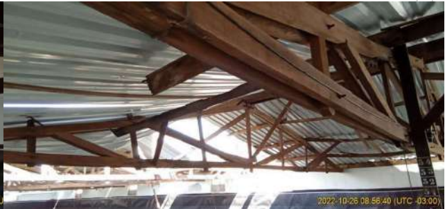
Foto 2 - Estrutura do telhado comprometida e ausência de telha
