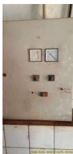
Foto 3 - Painel de comando e controle da EEAT Estiva
