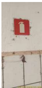
Foto 1 - Ausência de extintor de incêndio em local destinado para tal
