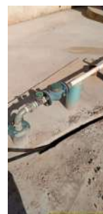
Foto 2 - Conexões da captação do Poço Romana
