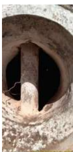
Foto 1 - Abertura de ventilação sem tela de proteção contra a entrada de insetos e pequenos animais nas tubulações de ventilação
