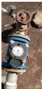
Foto 1 - Macromedidor do Poço 1 Estiva
