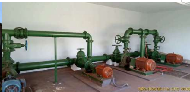
Foto 2 - Conjuntos moto-bomba em funcionamento e reserva da EEAT Bairro Alto (Santo Antônio e Vale do Sol)
