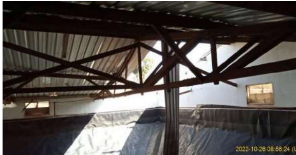
Foto 1 - Ausência de telha na cobertura do reservatório
