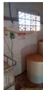
Foto 2 - Tanque com ácido fluorsilícico e bomba dosadora
