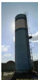
Foto 1 - Reservatório São José
