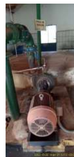
Foto 2 - Conjunto motobomba em operação
