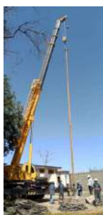
Foto 1 - Poço Bairro Alto, com guindaste para retirada da bomba
