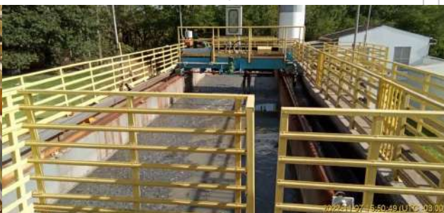
Foto 10 - Caixa de areia
