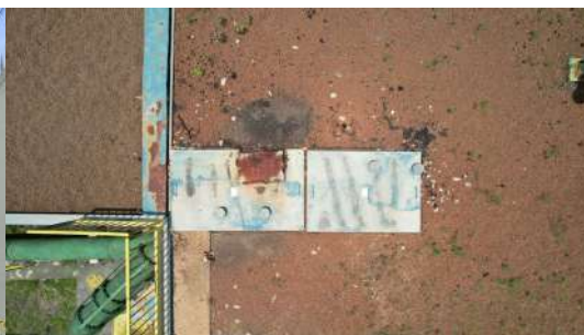
Foto 4 - Vista superior das tampas de inspeção
