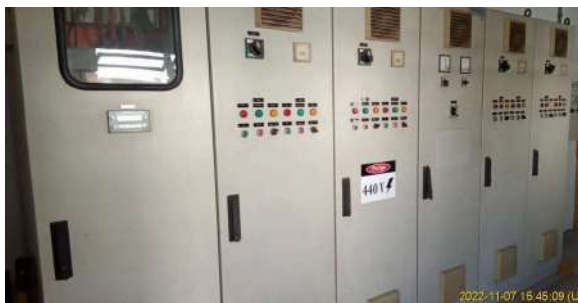
Foto 5 - Painel de comando e controle
