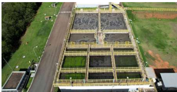
Foto 17 - Vista superior do tanque de aeração e decantador secundário
