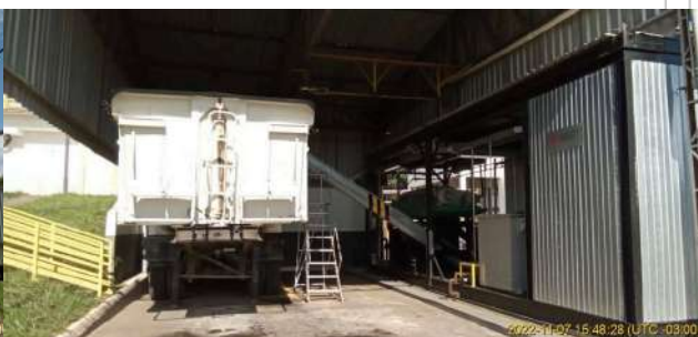
Foto 8 - Desidratação de lodo
