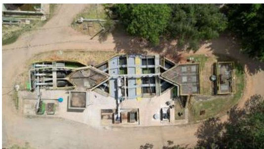
Foto 3 - Vista do tratamento preliminar (gradeamento).
