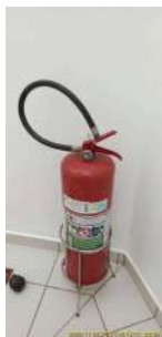
Foto 1 - Extintor de Incêndio
