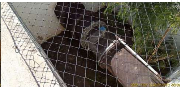
Foto 6 - Macromedidor de vazão da ETE
