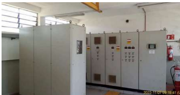
Foto 3 - Painel de controle e acionamento dos conjuntos motobombas
