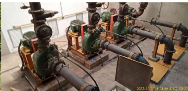
Foto 4 - Conjuntos motobomba da elevatória
