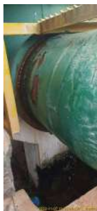
Foto 1 - Localização do vazamento na tubulação que interliga os reservatórios
