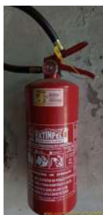
Foto 5 - Extintor de incêndio
