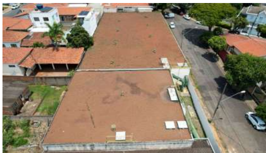
Foto 2 - Vista superior do centro de reservação Mercedes
