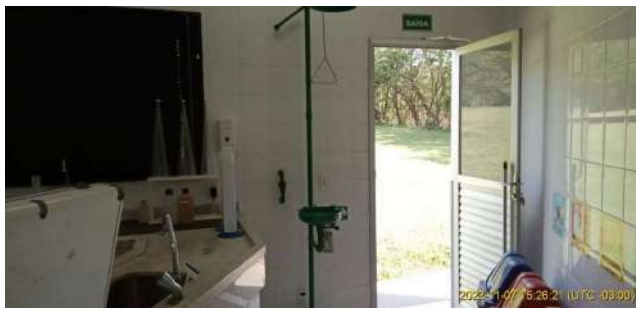
Foto 1 - Chuveiro de emergência
