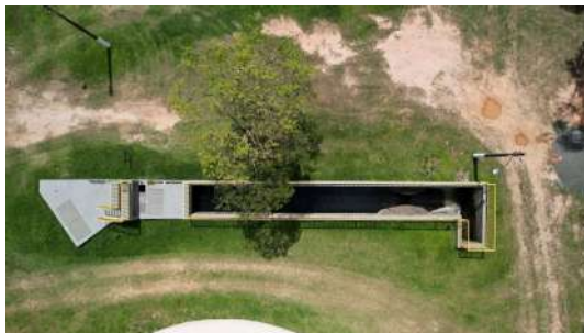
Foto 9 - Vista da calha de medição de vazão de efluente tratado
