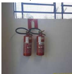
Foto 4 - Extintor de incêndio
