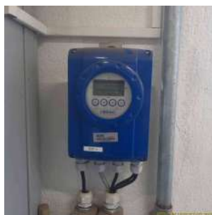
Foto 6 - Display do medidor de vazão
