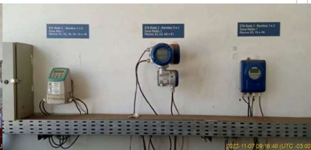
Foto 4 - Macromedidores de vazão
