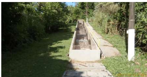
Foto 3 - Escada de aeração
