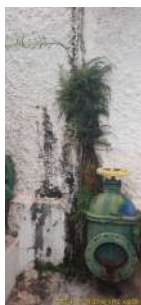
Foto 3 - Localização do vazamento na tubulação que interliga os reservatórios
