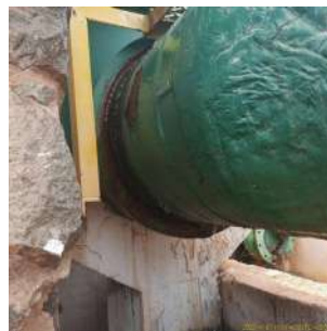
Foto 2 - Localização do vazamento na tubulação que interliga os reservatórios
