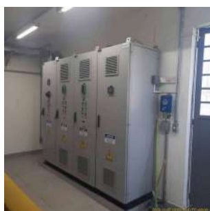
Foto 3 - Painel de controle e acionamento dos conjuntos motobombas
