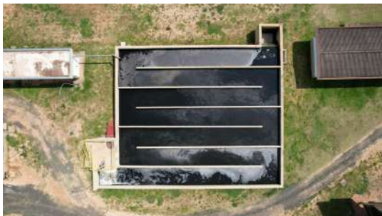
Foto 8 - Vista do tanque de contato para desinfecção
