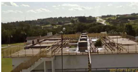
Foto 11 - Reatores anaeróbios de fluxo ascendente
