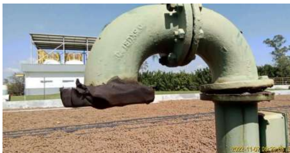
Foto 3 - Tela de proteção na tubulação de ventilação
