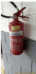
Foto 3 - Extintor de incêndio
