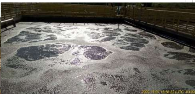
Foto 12 - Tanque de aeração
