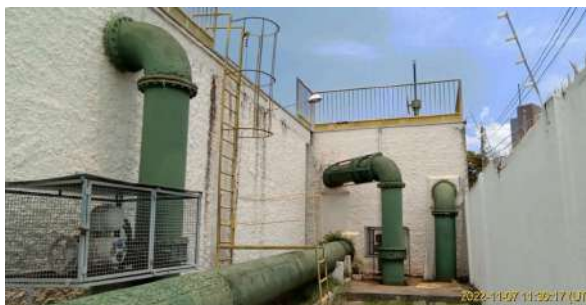
Foto 3 - Vista lateral dos reservatórios Mercedes
