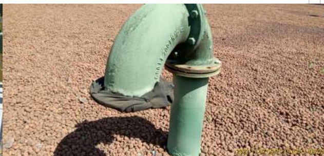
Foto 2 - Tela de proteção na tubulação de ventilação
