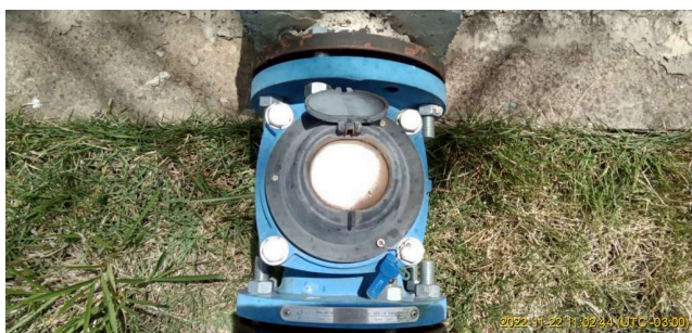
Foto 1 - Macromedidor de vazão
