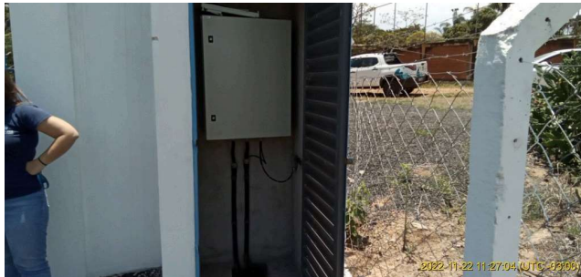
Foto 5 - Vista do painel de controle da EEEB.
