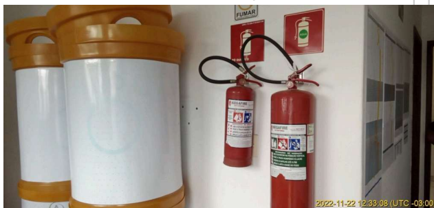
Foto 12 - Extintores de incêndio.
