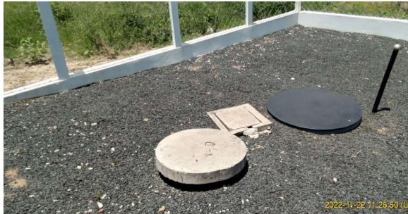
Foto 3 - Vista interna da EEEB.
