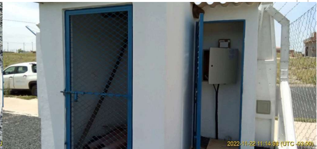
Foto 4 - Vista do painel de controle da EEEB.
