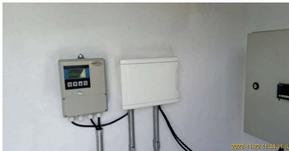
Foto 1 - Vista do painel de controle do reservatório com medição de nível.
