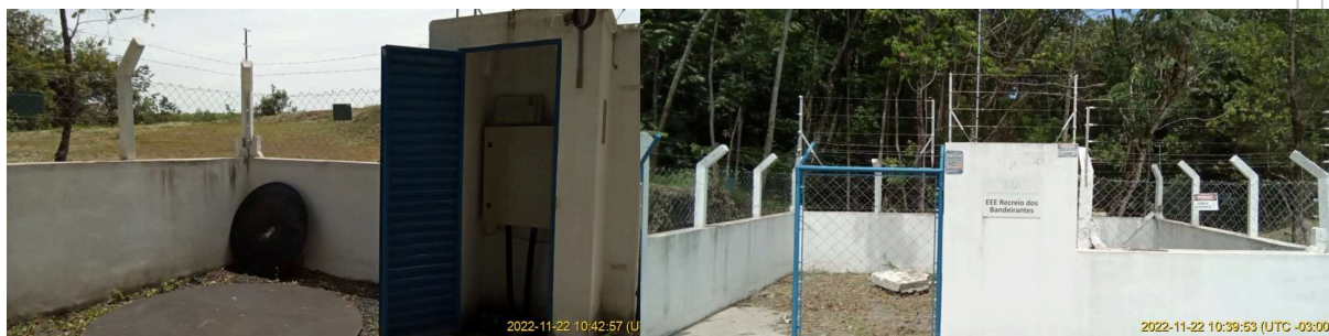
Foto 1 - Vista do painel de controle da EEEB.
