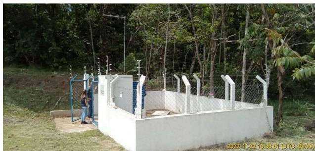
Foto 3 - Vista geral da EEEB.
