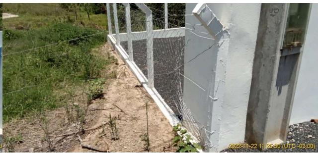
Foto 2 - Detalhe de abertura no alambrado de cercamento.
