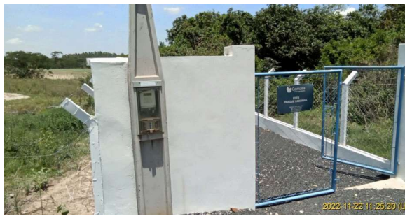
Foto 1 - Vista geral da EEEB com a placa de identificação.
