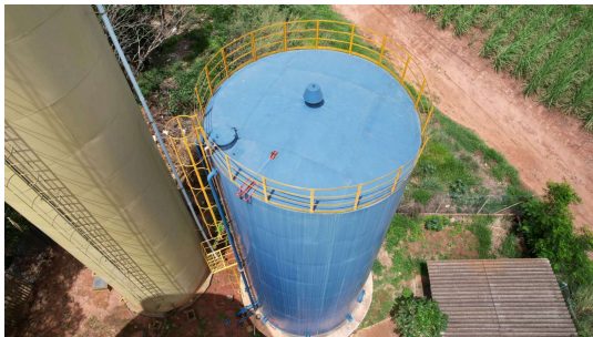
Foto 1 - Tapa de inspeção do Reservatório metálico novo
