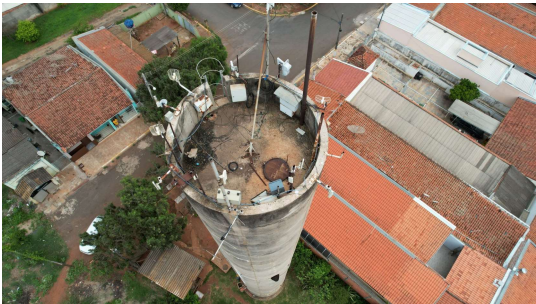
Foto 1 - Ausência de cobertura e tela de proteção em tubulação de respiro - Reservatório elevado em concreto Bom Jardim
