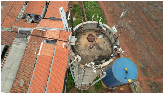
Foto 1 - Haste de para-raios caída - Reservatório elevado em concreto armado Bom Jardim
