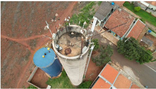
Foto 2 - Haste de para-raios caída - Reservatório elevado em concreto armado Bom Jardim
