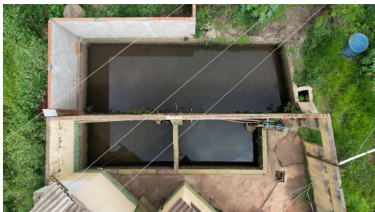
Foto 6 - Tanques de recuperação de água de lavagem - ETA III
