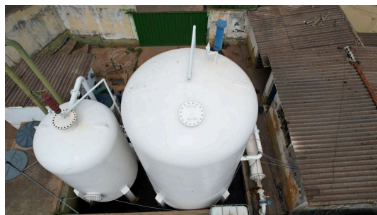
Foto 5 - Tanques de decantação e filtração - ETA III
