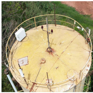
Foto 1 - Detalhe do fio condutor de descida do reservatório elevado amarelo São Cristóvão II
