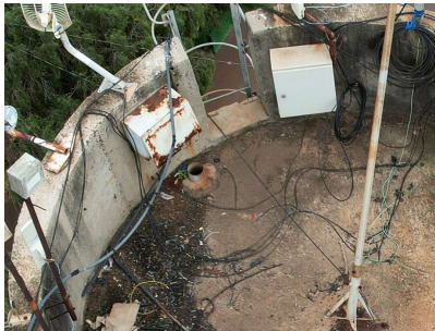
Foto 2 - Detalhe da ausência de cobertura e tela de proteção em tubulação de respiro - Reservatório elevado em concreto Bom Jardim
