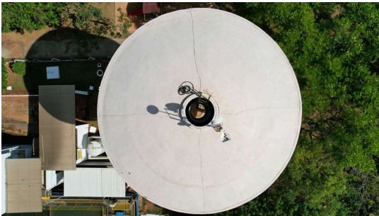
Foto 1 - Ausência de tampa de inspeção
