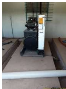
Foto 2 - Gerador instalado na EEE.
