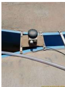
Foto 1 - Detalhe do macromedidor instalado na saída do efluente tratado e que não funciona.
