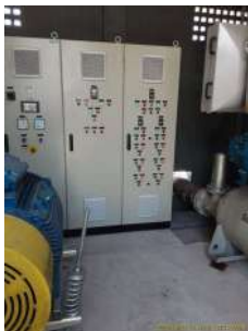
Foto 19 - Painelelétrico da casa de geradores.
