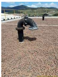
Foto 1 - Detalhe da rede de proteção instalada na tubulação de ventilação.
