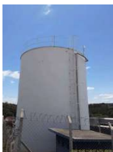
Foto 1 - Há para-raios instalado e condutor de descida.
