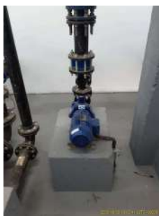
Foto 4 - Detalhe da bomba.
