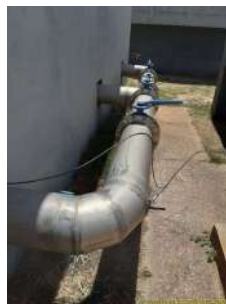
Foto 13 - Válvulas para controle de vazão.
