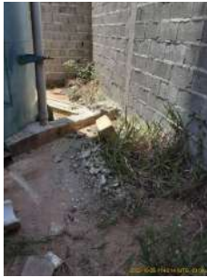
Foto 1 - Acúmulo de vegetação e sujeira na base do reservatório.
