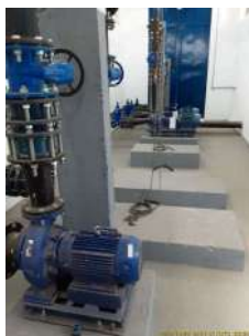
Foto 1 - Vista geral da casa de bombas junto à ETA 03.
