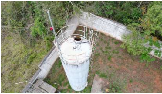
Foto 1 - Detalhe da haste do para-raios (imagem obtida com auxílio de drone).
