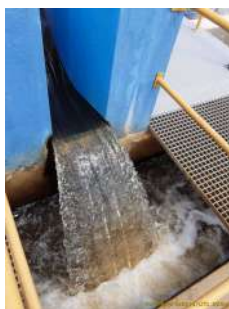
Foto 13 - Passagem pela calha Parshall.
