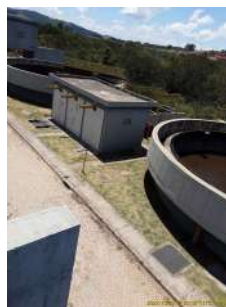
Foto 8 - Vista geral da casa de geradores e decantadores secundários.
