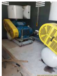
Foto 18 - Gerador em operação.
