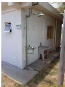
Foto 1 - Chuveiro de emergência próximo ao laboratório.
