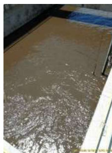
Foto 6 - Tanque de areia próximo à chegada do esgoto bruto.
