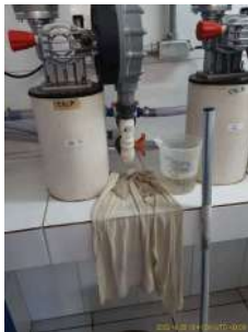
Foto 1 - Há vazamento junto às instalações das bombas dosadoras.
