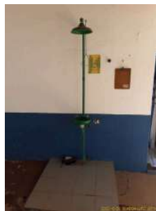
Foto 2 - Chuveiro de emergência 2.
