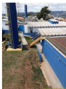
Foto 10 - Vista geral da torre de carga e reservatório apoiado junto à ETA 03.
