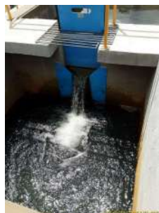
Foto 16 - Saída após passagem pelos filtros.
