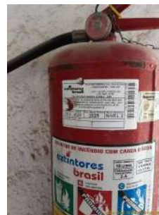
Foto 2 - Extintor de incêndio 2 com validade adequada.
