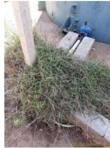
Foto 2 - Vegetação crescendo junto à base do reservatório.
