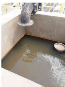
Foto 11 - Chegada da água bruta no tratamento.
