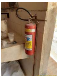
Foto 1 - Extintor de incêndio.
