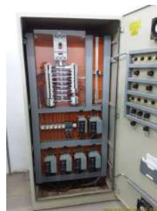
Foto 2 - Painelelétrico junto às bombas.
