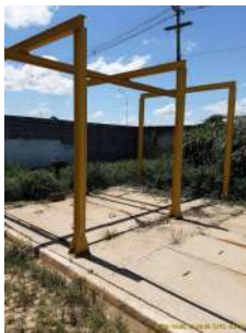
Foto 1 - Acesso para içamento e manutenção das bombas.
