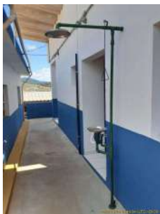
Foto 1 - Chuveiro de emergência 1.
