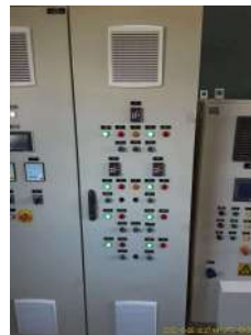
Foto 4 - Painéis elétricos do local.
