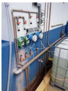
Foto 17 - Bombas dosadoras (cloro e flúor).
