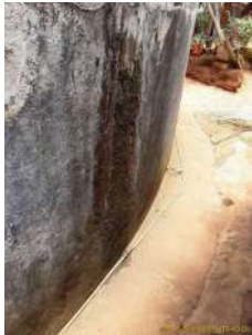
Foto 1 - Detalhe do vazamento 1.
