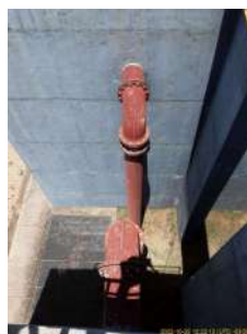
Foto 10 - Tubulação entre tanques.
