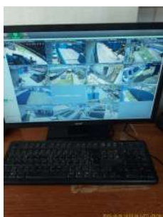
Foto 19 - Sistema de câmeras instalado na ETA 03.
