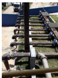
Foto 22 - Distribuição entre os bairros do município. Há tubulações reservadas para ampliação.
