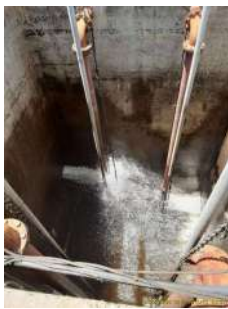
Foto 14 - Local de mistura de efluentes para recirculação.
