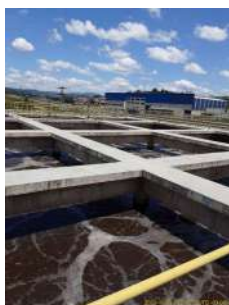
Foto 9 - Detalhe dos tanques da ETE.
