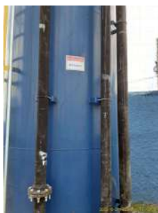
Foto 1 - Placa de identificação do reservatório.
