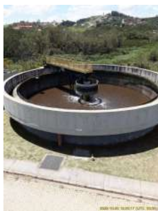
Foto 7 - Decantador secundário em operação.
