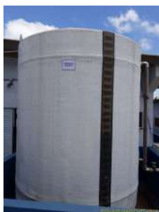
Foto 1 - Tanque de sulfato.
