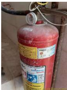
Foto 1 - Extintor de incêndio 1 com validade adequada.
