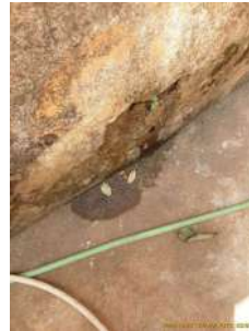
Foto 2 - Detalhe do vazamento 2.
