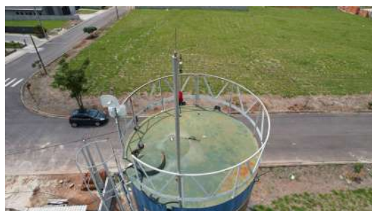
Foto 1 - Detalhe da haste de para-raios (imagem obtida com auxílio de drone).
