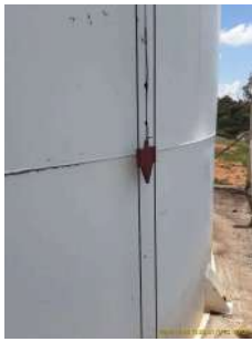
Foto 1 - O reservatório possui boia e está conectado ao sistema de telemetria.
