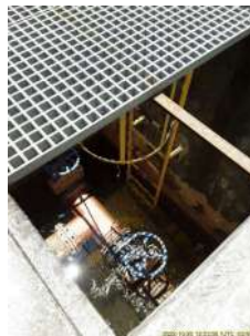
Foto 16 - Registro próximo à casa de geradores.
