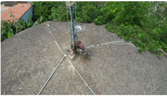
Foto 1 - Detalhe da rede de proteção instalada e danificada (imagem obtida com o auxílio de drone). É necessário realizar a troca da rede.
