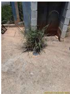
Foto 3 - Vegetação crescendo junto à base do reservatório.
