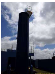
Foto 6 - Torre de carga utilizada pelas ETAs 02 e 03.
