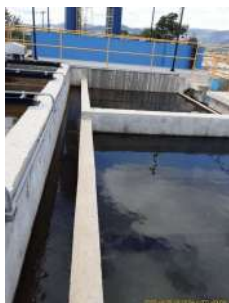
Foto 15 - Vista dos filtros da ETA 03.
