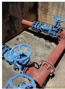
Foto 15 - Válvulas junto ao ponto de mistura.
