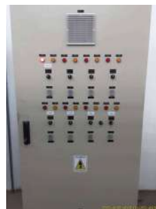
Foto 3 - Painelelétrico junto às bombas.
