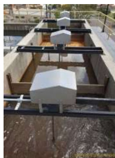
Foto 14 - Detalhe dos misturadores (floculação).
