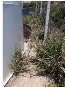
Foto 2 - Vegetação crescendo junto à base do reservatório.
