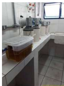
Foto 18 - Vista interna das instalações das bombas de dosagem.
