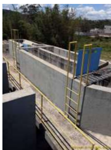
Foto 5 - Detalhe da calha Parshall na chegada do esgoto bruto.
