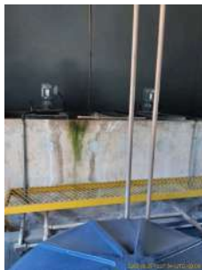
Foto 3 - Detalhe das bombas dentro das instalações para tratamento de lodo.
