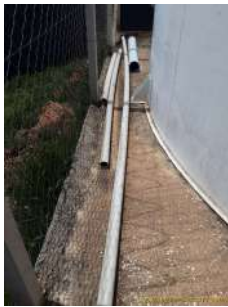
Foto 1 - Depósito de materiais estranhos à operação do reservatório.
