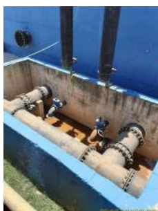
Foto 21 - Saída do reservatório apoiado.
