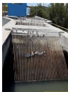
Foto 4 - Gradeamento grosseiro na chegada do esgoto bruto.
