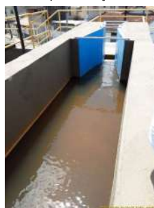
Foto 12 - Calha Parshall na chegada da água bruta.
