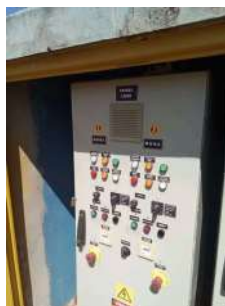
Foto 8 - Painele de comando das bombas do tratamento de lodo de da água de recirculação.
