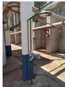
Foto 2 - Chuveiro de emergência próximo à aplicação de hipoclorito de sódio.
