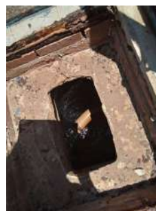
Foto 2 - Entrada de água proveniente do poço.
