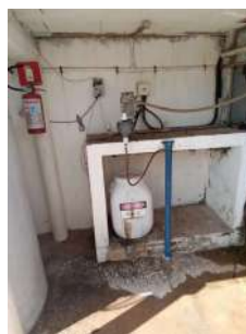
Foto 4 - Dosagem de PAC na entrada do tratamento.
