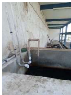
Foto 3 - Aplicação de flúor e desinfecção na saída dos filtros: não há medidor de vazão na saída do tratamento.
