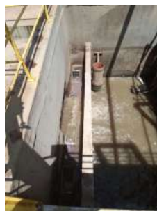
Foto 6 - Cesto para remoção de sólidos no tratamento preliminar.
