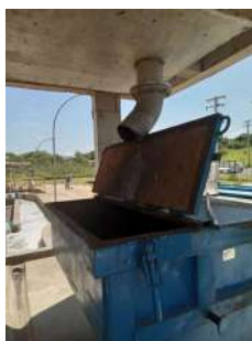
Foto 13 - Remoção de sólidos pelo peneiramento.
