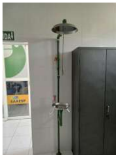
Foto 1 - Chuveiro de emergência no laboratório
