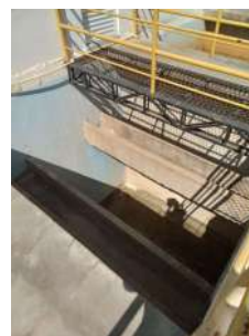
Foto 7 - Um dos 3 filtros em manutenção na ETA. Outros 3 estavam em operação
