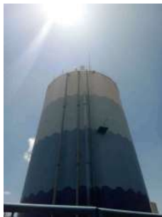
Foto 1 - Para-raios no reservatório de maior volume e altura.
