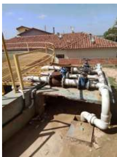
Foto 7 - Sistema de sucção do tanque de lodo.
