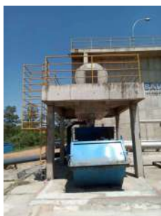
Foto 9 - Caçamba para coleta de sólidos removidos pelo peneiramento.
