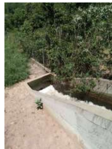
Foto 4 - Lançamento do efluente.
