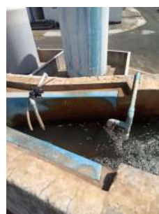
Foto 2 - Calha Parshall na entrada da ETA, adição de PAC e pré-cloração.
