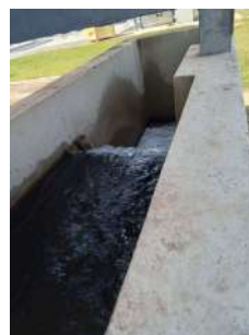
Foto 4 - Ausência de medição de vazão na saída do tratamento.
