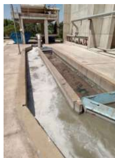
Foto 4 - Tanques para desarenação.
