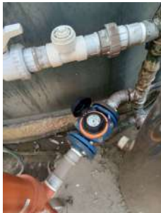
Foto 5 - Medidor de vazão na saída do reservatório
