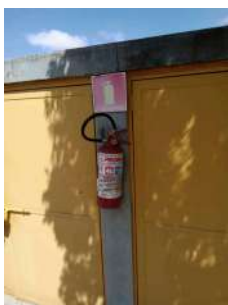
Foto 1 - Extintor próximo ao painel elétrico do tratamento de lodo.
