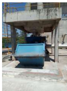
Foto 14 - Remoção de sólidos pelo peneiramento.
