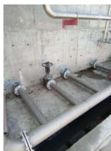
Foto 21 - Saída de lodo dos reatores.
