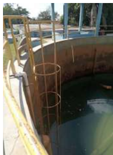
Foto 4 - Tanque para acúmulo de lodo.
