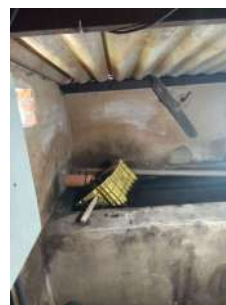
Foto 2 - Abertura para ventilação de água bruta.
