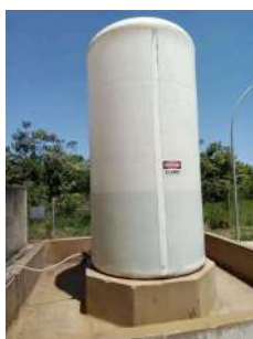
Foto 1 - Tanque para armazenamento de hipoclorito de sódio para adição na câmara de contato (mistura lenta).
