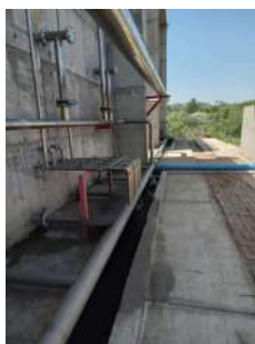
Foto 22 - Saída de efluente dos reatores.
