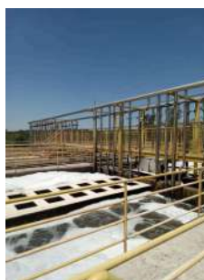
Foto 29 - Vista dos dois reatores. O da frente, na foto, foi reativado recentemente, tendo a manta de lodo regenerada, após episódio de chegada de produtos químicos, com o efluente bruto, que prejudicaram o tratamento.
