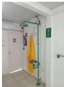
Foto 2 - Chuveiro de emergência no laboratório.
