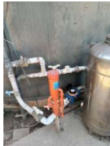
Foto 6 - Filtro existente na entrada do reservatório.
