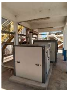
Foto 19 - Sopradores para injeção de ar nos reatores.
