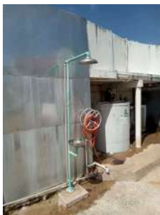
Foto 1 - Chuveiro de emergência próximo aos tanques de armazenamento de produtos químicos.
