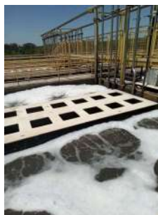
Foto 25 - Vista de um dos reatores. A presença de espuma, de acordo com o Saaesp, se dá pela recente reativação deste reator, após a ocorrência da chegada de produtos químicos junto com o efluente. Foi necessário regenerar a manta de lodo neste reator.
