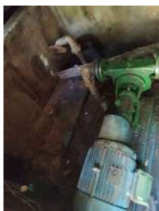
Foto 1 - Apenas uma bomba instalada no local. SAAESP vai instalar outra no local.
