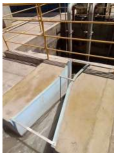
Foto 1 - Calha Parshall na entrada da ETE, após o desarenador.
