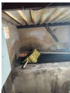
Foto 5 - Entrada de água bruta no reservatório.
