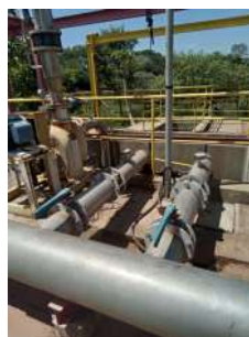
Foto 10 - Sistema de bombeamento para sucção do efluente bruto, após o gradeamento.
