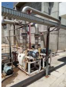
Foto 15 - Bombeamento do efluente para os reatores, após o tratamento preliminar.
