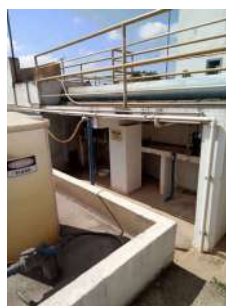
Foto 2 - Tanque para armazenamento de flúor e bombas dosadoras.
