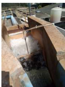
Foto 1 - Calha Parshall na entrada da ETA e adição de coagulante (PAC)
