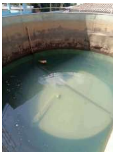
Foto 3 - Tanque para acúmulo de lodo.
