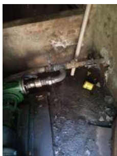
Foto 1 - Recalque de água bruta.
