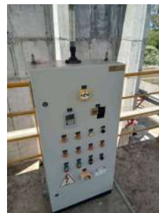
Foto 3 - Painel de comando da centrífuga.
