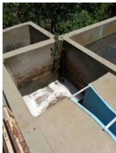
Foto 3 - Saída do efluente após a calha parshall.
