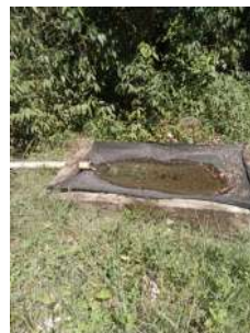
Foto 2 - Chegada da água bruta.
