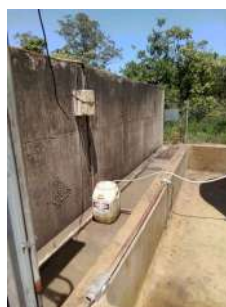
Foto 2 - Dosagem de hipoclorito de sódio.
