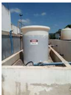
Foto 5 - Tanque para armazenamento de PAC
