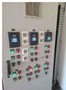
Foto 18 - Painel de comando dos sistemas bombeamento da ETE.
