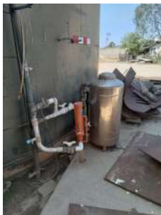
Foto 7 - Filtro existente na entrada do reservatório.
