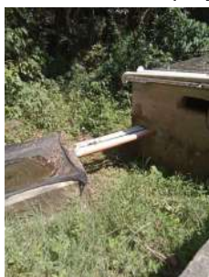
Foto 3 - Entrada de água bruta no reservatório.
