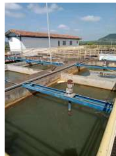
Foto 10 - Misturadores na etapa de floculação
