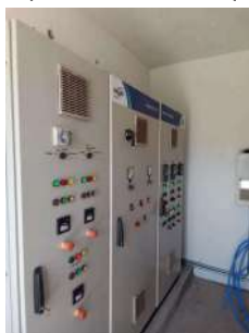
Foto 17 - Painel de comando dos sistemas bombeamento da ETE.
