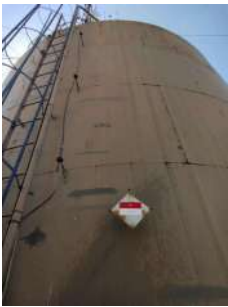
Foto 1 - Medidor de nível por contrapeso.
