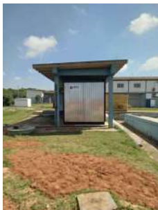
Foto 5 - Skid para desidratação do lodo.
