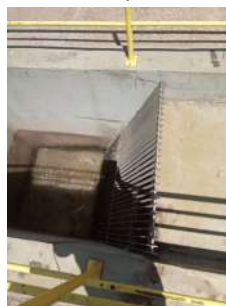
Foto 8 - Chegada de efluente bruto na ETE e gradeamento grosseiro.
