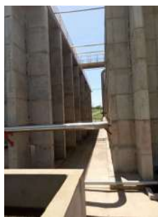
Foto 31 - Entrada de ar na fase aeróbia.
