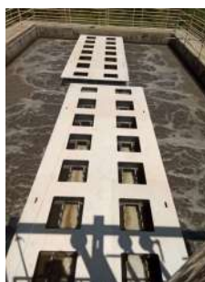
Foto 27 - Reator da ETE.
