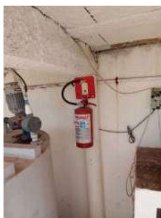
Foto 3 - Extintor próximo às bombas dosadoras de produtos químicos.
