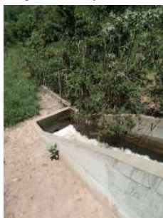
Foto 34 - Lançamento do efluente tratado.
