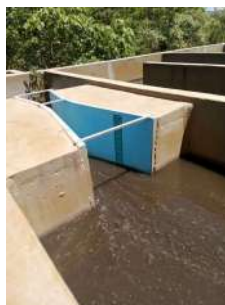
Foto 33 - Saída da câmara de contato e calha parshall na saída.
