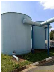
Foto 1 - Sedimentadores de água bruta, antes do início do tratamento na ETA.
