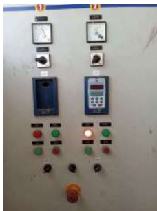
Foto 1 - Painel de comando.
