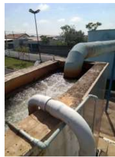
Foto 9 - Entrada de água bruta na ETA.
