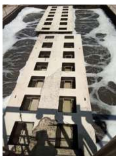
Foto 26 - Reator na fase aeróbia.
