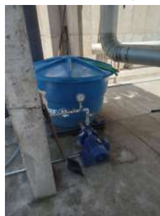
Foto 12 - Tanque para armazenamento de água para lavagem da peneira rotativa.
