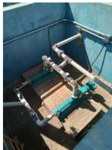
Foto 6 - Sistema de bombeamento do tratamento de lodo
