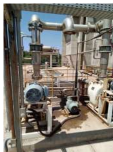
Foto 16 - Bombeamento do efluente para os reatores, após o tratamento preliminar.
