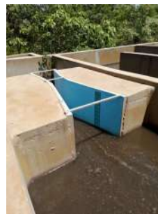
Foto 2 - Calha Parshall na saída da ETE, após a câmara de contato
