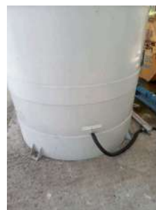
Foto 5 - Tanque para armazenamento de polímero.
