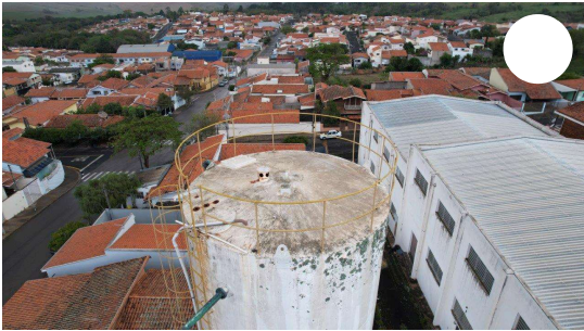
Foto 4 - Vista superior do Reservatório R8 com detalhes de corrosão no reservatório em três furos
