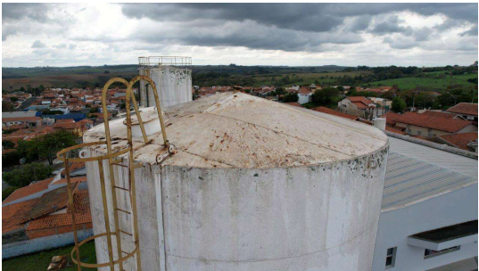
Foto 2 - Vista superior lateral do Reservatório R7 - Sistema Cohab, com detalhe de ausência de guarda-corpos
