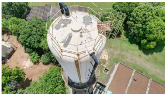
Foto 2 - Reservatório Jardim Europa Elevado em Santa Bárbara do Oeste
