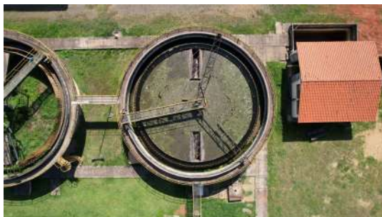
Foto 8 - ETE Toledos I em Santa Bárbara d'Oeste
