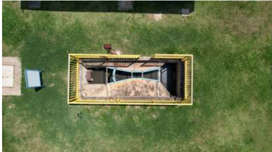
Foto 5 - ETE Balsa em Santa Bárbara d'Oeste
