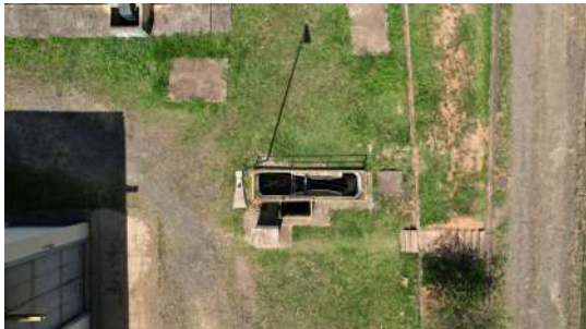
Foto 9 - ETE Toledos I em Santa Bárbara d'Oeste
