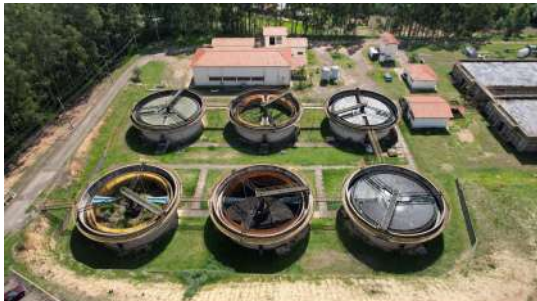
Foto 5 - ETE Toledos I em Santa Bárbara d'Oeste
