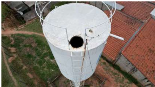
Foto 1 - Ausência de tampa de inspeção
