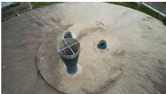
Foto 1 - Ausência de tela de proteção
