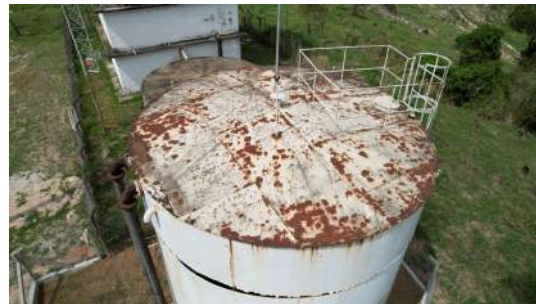
Foto 2 - Reservatório Arcadas (abertura no último anel)
