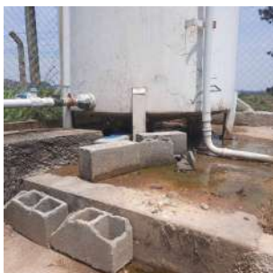
Foto 1 - Vazamento no reservatório
