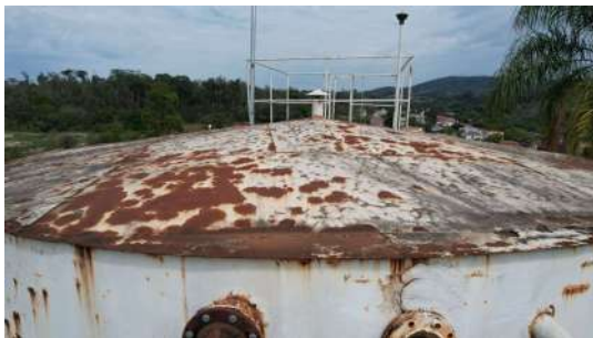
Foto 3 - Reservatório Arcadas (pontos de oxidação)
