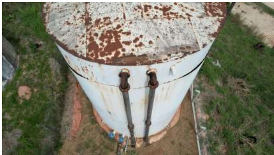
Foto 1 - Reservatório Arcadas (abertura no último anel)
