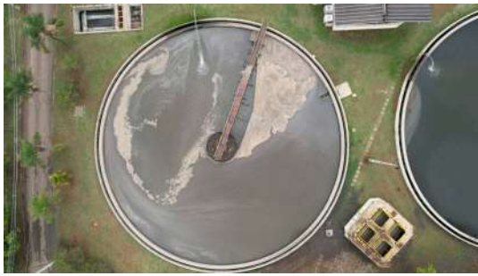
Foto 12 - Decantador secundário - ETE Canjica
