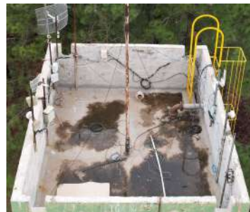
Foto 2 - Detalhe da tubulação de respiro sem tela de proteção - Reservatório elevado City Castelo
