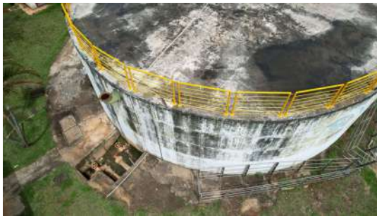
Foto 1 - Tubulação sem proteção contra entrada de insetos, poeira ou chuva - Reservatório apoiado ETA Pirapitingui
