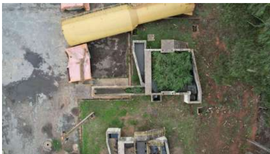
Foto 7 - Desarenador com vegetação em seu interior - ETE Canjica
