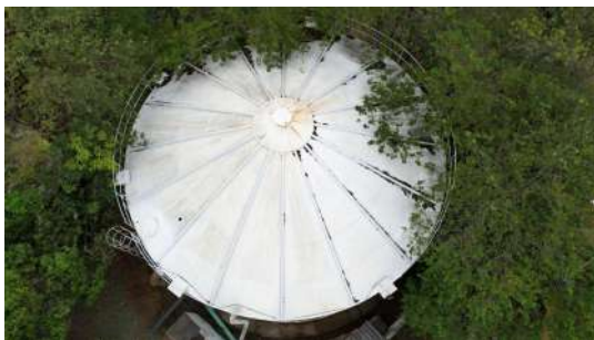
Foto 1 - Ausência de cobertura e tela em tubo na cobertura do Reservatório apoiado (a direita) City Castelo
