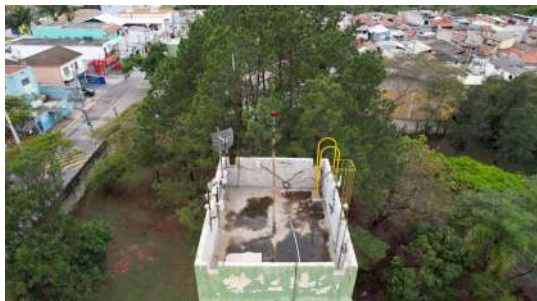
Foto 1 - Ausência de tela em tubulação de respiro - Reservatório elevado City Castelo
