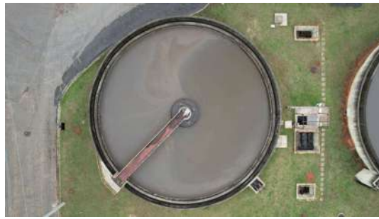
Foto 13 - Adensador de lodo - ETE Canjica
