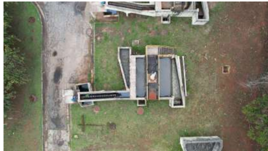
Foto 6 - Desarenador - ETE Canjica
