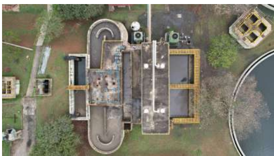
Foto 10 - Sistema Deep Shaft e Degaseificador - ETE Canjica
