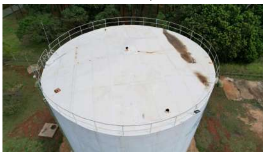
Foto 4 - Ausência de cobertura e tela de proteção nas tubulações de respiro-ventilação - Reservatório elevado ETA Pirapitingui
