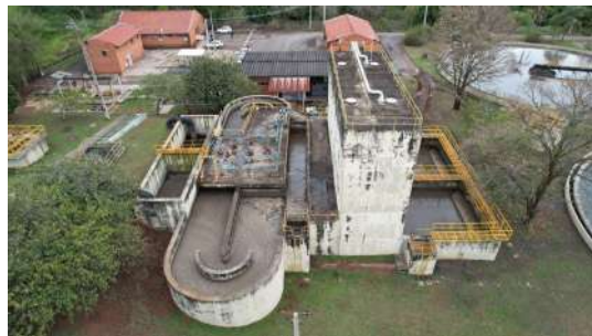
Foto 9 - Sistema Deep Shaft e Degaseificador - ETE Canjica
