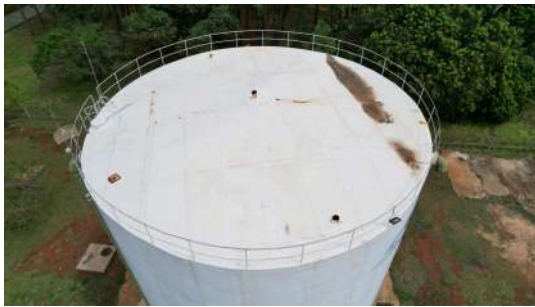
Foto 1 - Ausência de cobertura e tela de proteção nas tubulações de respiro-ventilação - Reservatório elevado ETA Pirapitingui
