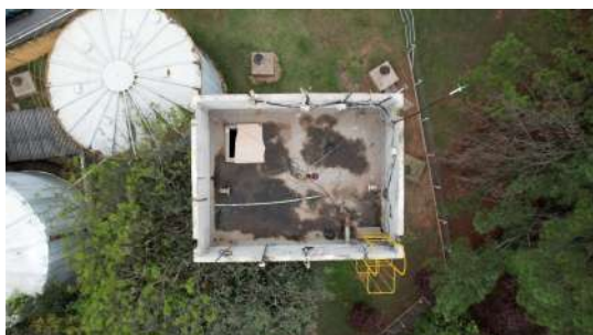
Foto 1 - Tampa de inspeção inadequada e aberta - Reservatório elevado City Castelo
