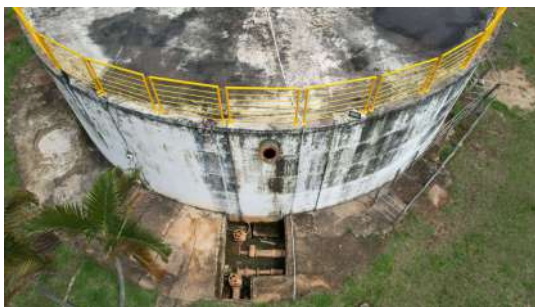
Foto 5 - Tubulação sem tela e com boca voltada para cima - Reservatório apoiado ETA Pirapitingui
