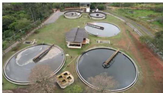
Foto 11 - Três Decantadores secundários (abaixo) e Dois adensadores de lodo (acima) - ETE Canjica
