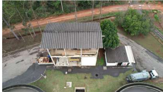
Foto 15 - Casa da centrífuga de lodo - ETE Canjica
