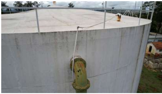
Foto 5 - Tubulações de ventilação com corrosão - Reservatório elevado ETA Pirapitingui
