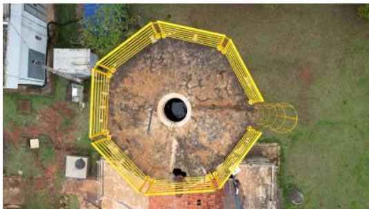
Foto 1 - Ausência de tampa de inspeção - Reservatório elevado para o Hospital ETA Pirapitingui
