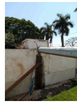
Foto 2 - Tubulação que extravasa água do reservatório Apoiado e encaminha para o reservatório enterrado
