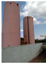
Foto 1 - Tanques para armazenamento e dosagem de hipoclorito de sódio no efluente final. Não estava sendo aplicado no momento da Fiscalização.
