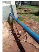
Foto 4 - Tubulação de recalque e sensores não intrusivos para medição de vazão.
