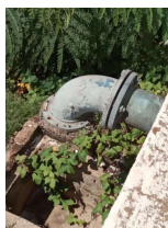
Foto 1 - Tela de proteção no extravasor.
