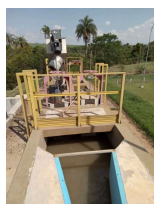
Foto 6 - Tratamento preliminar e calha Parshall na entrada.
