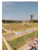
Foto 13 - Vista dos reatores a partir da estrutura que recebe o efluente do tratamento preliminar.
