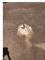
Foto 2 - Tubo de ventilação sem tela de proteção
