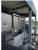
Foto 1 - Skid para desidratação de lodo e aplicação de polímeros.
