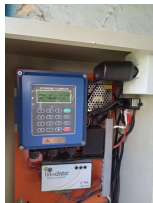
Foto 3 - Medidor de vazão da captação.
