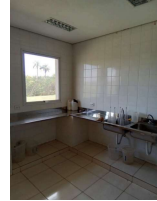
Foto 6 - Laboratório sem operação: necessário haver equipamentos para realização do monitoramento da eficiência ETE.
