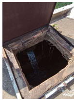
Foto 1 - Entrada de água proveniente do Poço Duque de Caxias
