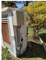
Foto 5 - Quadro elétrico abrindo também medidor de vazão
