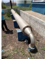
Foto 3 - Dispositivo para controlar a vazão de saída dos reservatórios.
