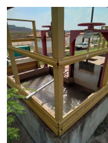
Foto 2 - Tratamento preliminar na chegada do efluente bruto vindo das elevatórias
