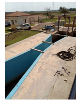
Foto 2 - Calha parshall na entrada da ETE, no tratamento preliminar
