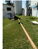
Foto 4 - Tubulação que abastece o reservatório Apoiado da prefeitura
