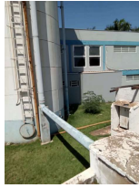
Foto 1 - Extravasor encaminha água para o reservatório semi enterrado.
