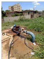
Foto 1 - Vazamento de grandes proporções verificado no poço
