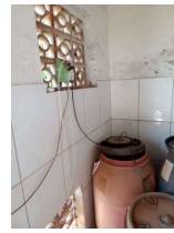
Foto 4 - Armazenamento de produtos químicos para cloração e fluoretação e bomba dosadora.
