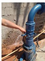
Foto 1 - Torneira para tomada de água bruta.
