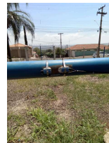
Foto 4 - Sensores para medição da vazão
