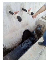
Foto 3 - Canaleta para escoamento de lodo nos reatores: obstruídas
