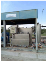
Foto 2 - Skid para desidratação de lodo
