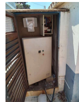
Foto 2 - Painelelétrico da bomba do poço e medidor de vazão.
