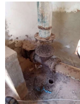
Foto 7 - Tubulação de recalque do poço atravessa a base do reservatório desativado. Observa-se a supressão da tubulação que abasteceria o reservatório.
