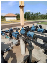
Foto 4 - Estação bombeamento para recirculação de lodo.
