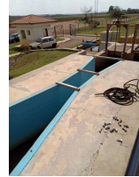
Foto 3 - Calha parshall na entrada da ETE, no tratamento preliminar
