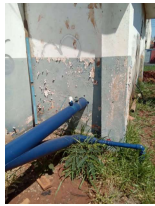
Foto 5 - Tubulação de recalque do poço passa pelo reservatório R5, que está desativado.
