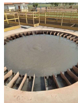
Foto 15 - Distribuidor do reator.
