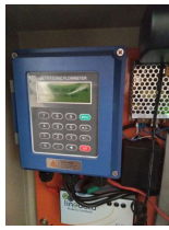
Foto 1 - Medidor de vazão do poço 5.
