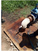
Foto 3 - A laje de proteção da captação contém chapa metálica muito corroída.
