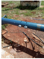
Foto 3 - Sensores para medição da vazão.
