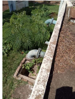
Foto 1 - Tubos de extravasão do reservatório.
