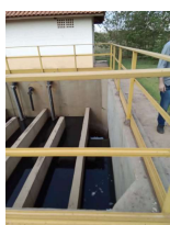
Foto 22 - Saída do efluente tratado da câmara de contato.
