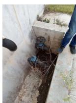
Foto 1 - Canaletas para escoamento de lodo nos reatores estavam obstruídas por sedimentos.
