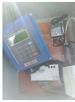
Foto 1 - Medidor de vazão da captação.
