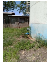
Foto 8 - Saída de um dos reservatórios.
