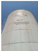
Foto 5 - Indicação do volume de um dos reservatórios: 600 m³
