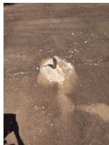
Foto 1 - Tubos de ventilação
