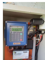
Foto 2 - Medidor de vazão da captação.
