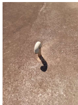
Foto 3 - Tubo de ventilação sem tela de proteção
