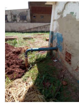
Foto 6 - Tubulação de recalque do poço abastece diretamente a rede.
