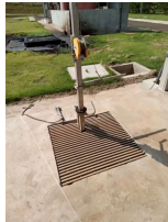
Foto 5 - Estação bombeamento para recirculação de lodo.
