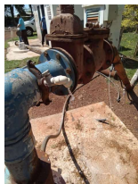
Foto 1 - Torneira para tomada de água bruta.
