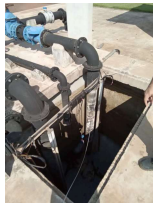
Foto 3 - Estação bombeamento para recirculação de lodo.
