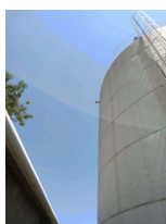
Foto 1 - Tubo extravasor com tela de proteção.
