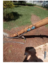
Foto 4 - Medidor ultrassônico não intrusivo.
