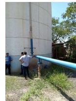
Foto 6 - Tubulação que abastece um dos reservatórios, proveniente do poço.
