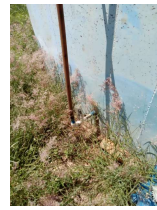
Foto 2 - DAES deverá operacionalizar a leitura do nível dos reservatórios, visto que na Fiscalização foi verificado que não está funcionando.
