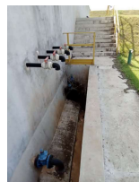
Foto 17 - Tubulação para monitoramento e escoamento de lodo nos reatores
