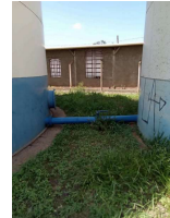
Foto 4 - Tubulação que comunica reservatórios.
