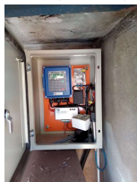
Foto 3 - Medidor de vazão da captação.
