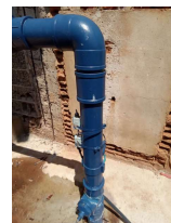
Foto 6 - Medidor de vazão não intrusivo.
