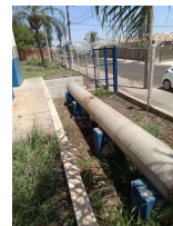
Foto 10 - Dispositivo para controlar a vazão de saída dos reservatórios.
