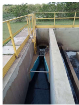
Foto 1 - Calha parshall na saída da ETE, antes das chicana para mistura lenta. Nela, havia a aplicação de hipoclorito, o que na ocasião da fiscalização não estava sendo executado.
