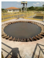
Foto 14 - Distribuidor do reator.
