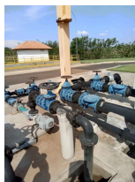
Foto 1 - Bombeamento para recirculação do lodo para os reatores UASB. Não estava em funcionamento.
