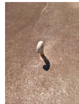
Foto 2 - Tubos de ventilação
