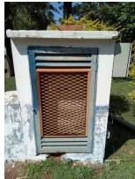
Foto 3 - Painel de comando da bomba
