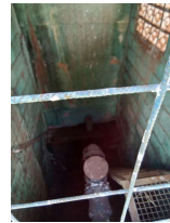
Foto 4 - Elevatória do água que bombeia do reservatório enterrado para o apoiado
