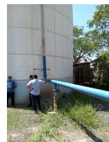
Foto 2 - Tubulação que abastece reservatório junto à captação.
