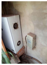
Foto 3 - Painele de comando da bomba do poço.
