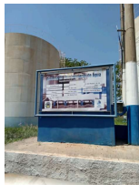
Foto 7 - Identificação do sistema de reservação.
