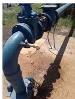
Foto 1 - Torneira para coleta de água bruta.
