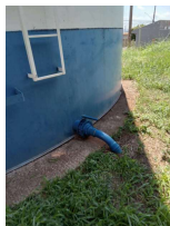
Foto 9 - Saída de um dos reservatórios.
