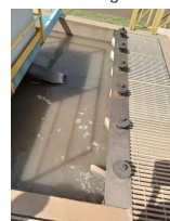
Foto 7 - Tanque de areia para desarenação.
