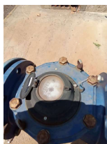
Foto 1 - Macromedidor antigo instalado na captação.
