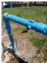
Foto 1 - Torneira para tomada de água bruta.
