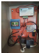
Foto 1 - Medidor de vazão do poço
