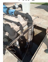
Foto 3 - Poço de sucção de lodo.
