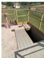
Foto 12 - Estrutura que recebe o efluente do tratamento preliminar e encaminha para os reatores UASB
