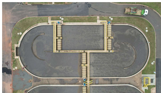
Foto 6 - Tanque de aeração
