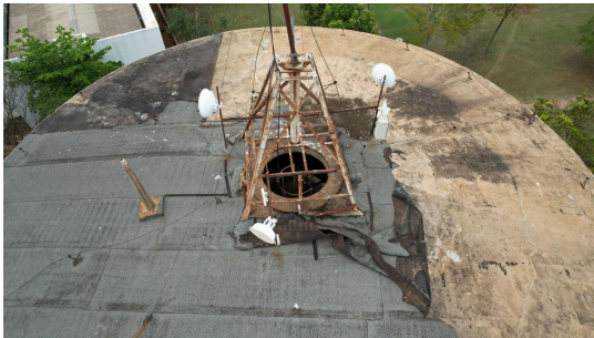
Foto 1 - Detalhe da ausência de tampa
