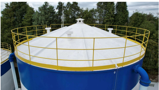
Foto 4 - Parte superior de um dos reservatórios com antenas de telemetria
