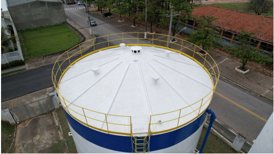
Foto 2 - Detalhes de reservatório apoiado - CR BEPIM
