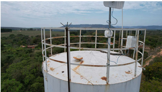
Foto 2 - Para-raios do Reservatório Uba 2
