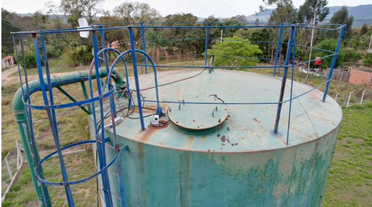
Foto 1 - Parafusos soltos tampa inspeção - Reservatório Uba 1
