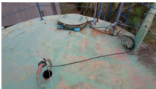
Foto 1 - Tubulação de ventilação e passagem de fiação sem tela de proteção contra insetos - Reservatório Uba 1
