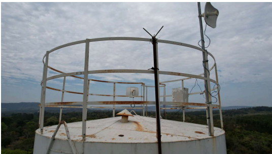
Foto 1 - Para-raios do Reservatório Uba 2
