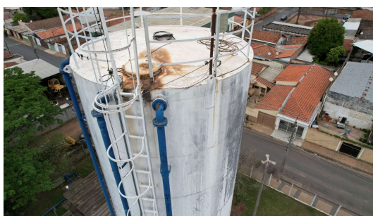
Foto 2 - Oxidação na tampa de inspeção e seu entorno - Reservatório elevado Rua Cinco
