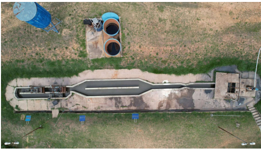
Foto 5 - Tratamento preliminar - ETE Itirapina. Recomenda-se manutenção no sistema de gradeamento.
