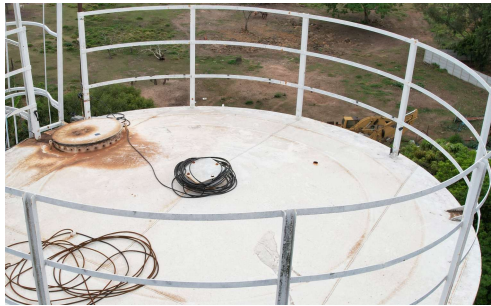
Foto 1 - Ausência de tampa na tubulação de ventilação , na parte a direita da foto.
