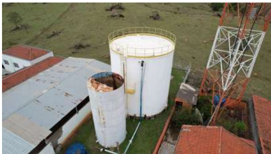
Foto 1 - Vista geral dos reservatórios no São Judas, sendo um deles (danificado) desativado.
