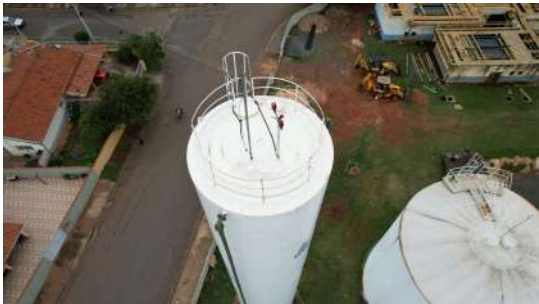
Foto 1 - Detalhe da haste do para-raios.
