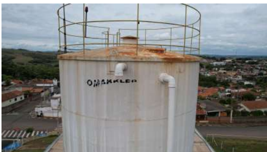
Foto 1 - Detalhe da tubulação de ventilação e tubo extravasor no reservatório 1. Não há rede de proteção contra a entrada de insetos e pequenos animais no tubo extravasor.
