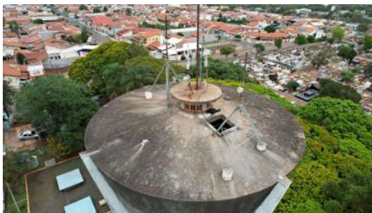
Foto 1 - Detalhe da ausência de tampa de inspeção e ave próxima à abertura.
