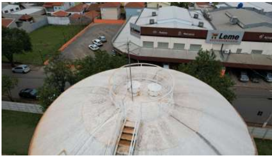
Foto 1 - Detalhe da haste do para-raios.
