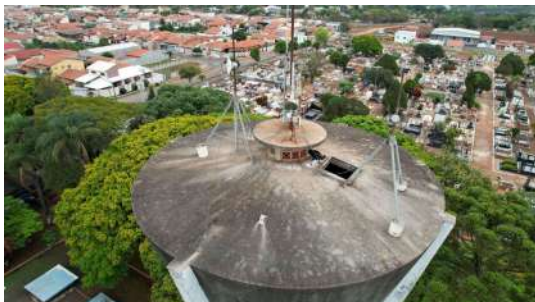
Foto 1 - Aberturas em alvenaria sem qualquer proteção contra entrada de insetos e pequenos animais.
