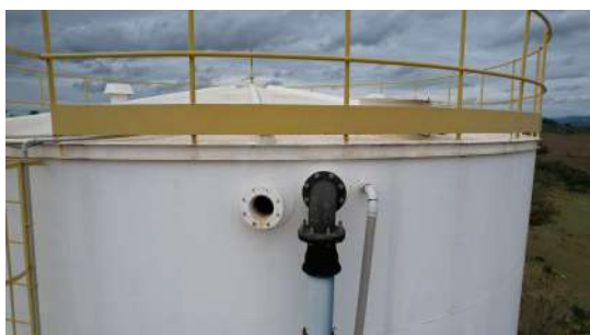
Foto 1 - Detalhe do extravassor sem rede de proteção contra entrada de insetos e pequenos animais.
