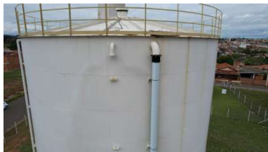
Foto 2 - Detalhe da tubulação de ventilação e tubo extravasor no reservatório 2. Não há rede de proteção contra a entrada de insetos e pequenos animais no tubo extravasor.
