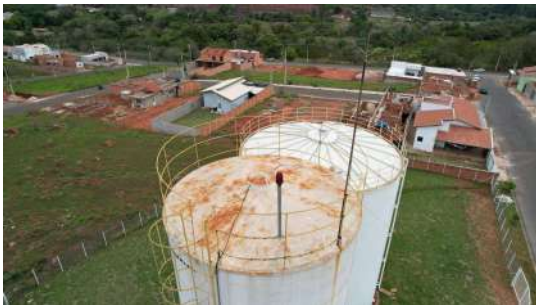
Foto 1 - Detalhe da haste do para-raios no reservatório 1.
