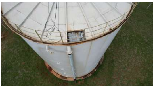
Foto 1 - Detalhe da tampa de inspeção danificada e semiaberta no reservatório 2.
